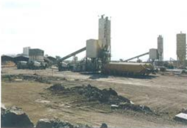
Figura 6.2.1. Plantas de hormigón.
