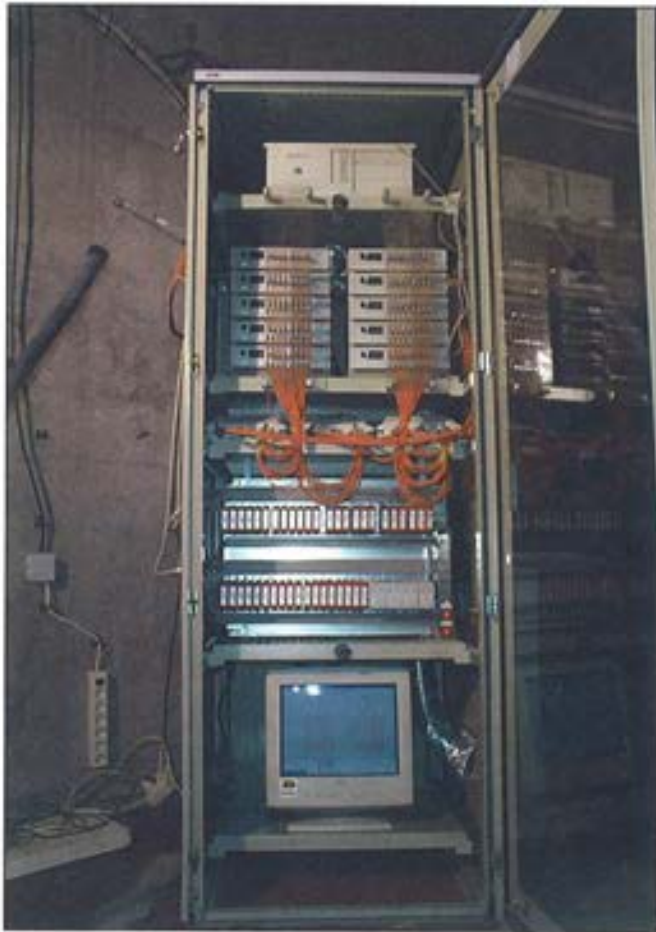
Figura 5.7.9. Armario de centralización del sistema.
