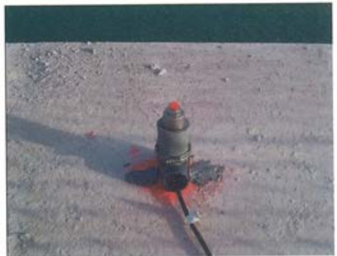
Figura 5.7.8. Sensores de presión hidrodinámica dispuestos en cubierta.
