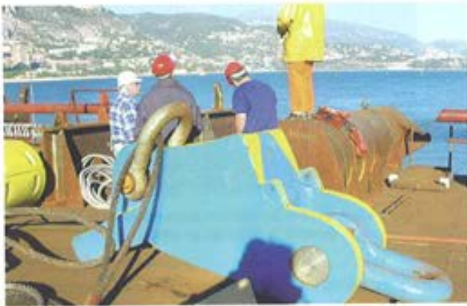
Fig. 5.2.11. Vista del equipo Stev-tensionner para control de la puesta en tensión de las cadenas.
