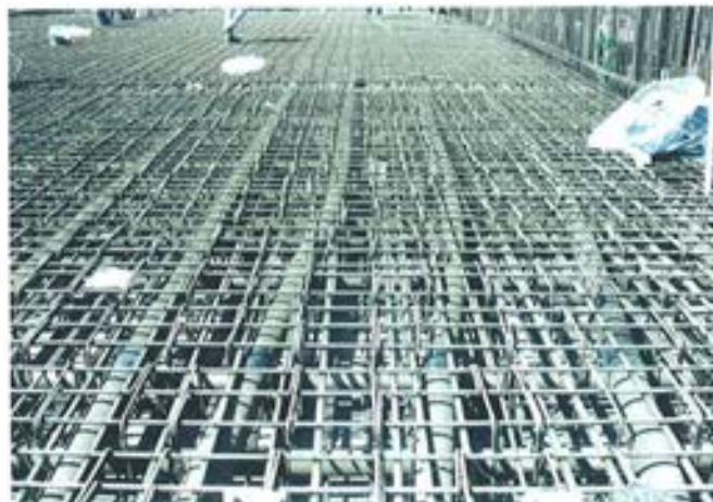
Figura 4.2. Vaina formada por tubos rígidos de acero.
