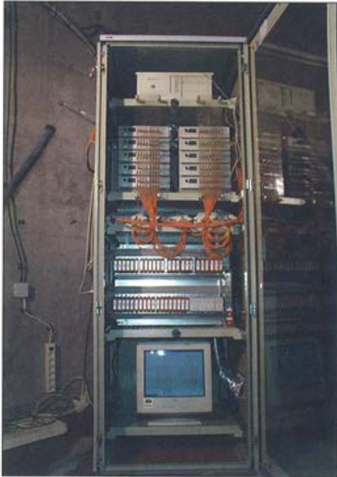
Figura 5.7.9. Armario de centralización del sistema.
