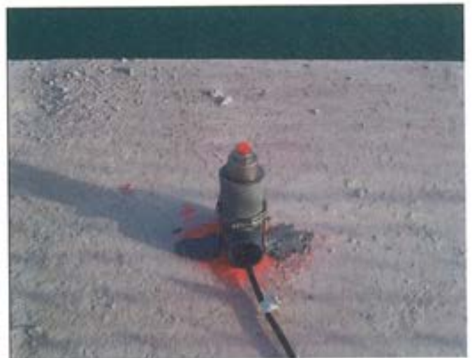
Figura 5.7.8. Sensores de presión hidrodinámica dispuestos en cubierta.
