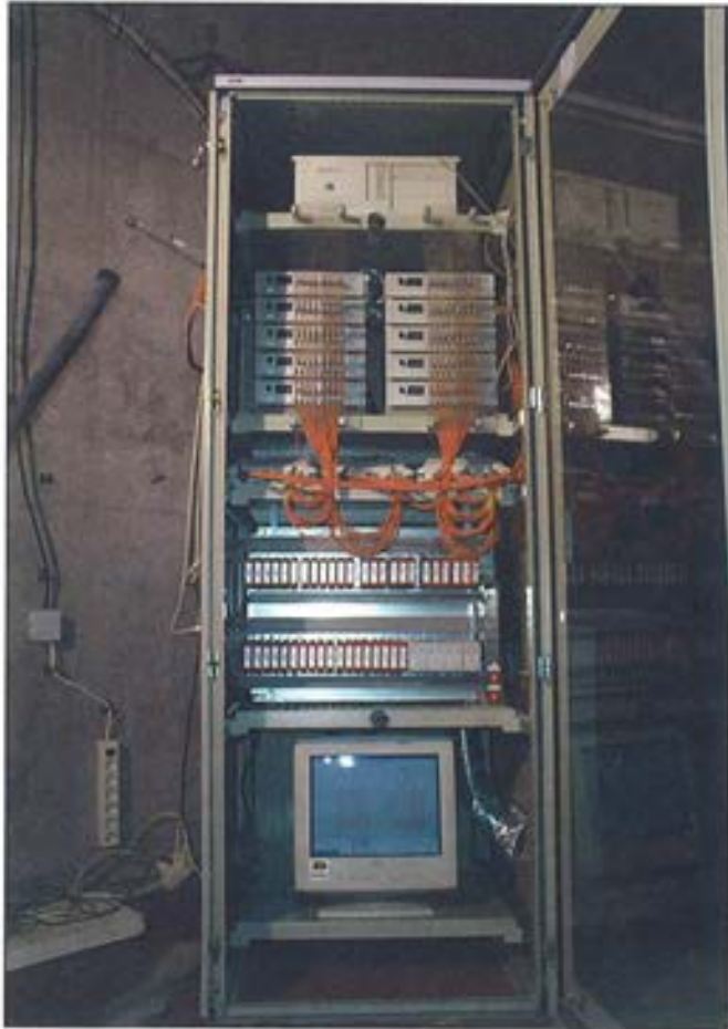
Figura 5.7.9. Armario de centralización del sistema.
