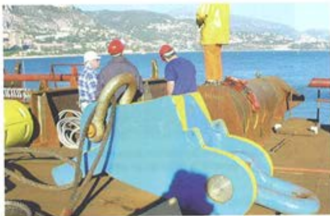
Fig. 5.2.11. Vista del equipo Stevensionner para control de la puesta en tensión de las cadenas.
