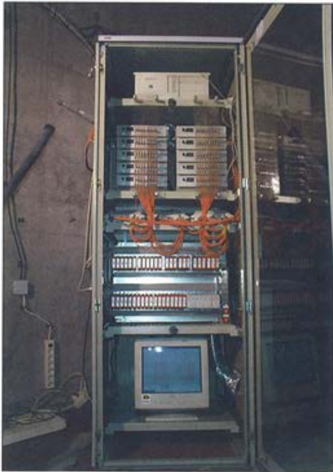
Figura 5.7.9. Armario de centralización del sistema.
