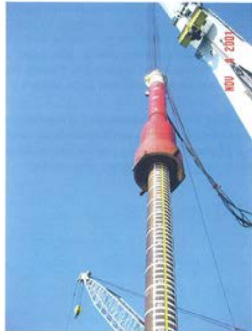
Figura 5.2.9. Detalle del martillo suspendido de la grúa durante la hincada de un pílate.
