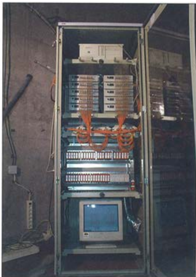
Figura 5.7.9. Armario de centralización del sistema.
