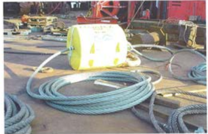
Figura 5.2.13. Detalle de la boya principal para recuperación de las cadenas desde el fondo.
