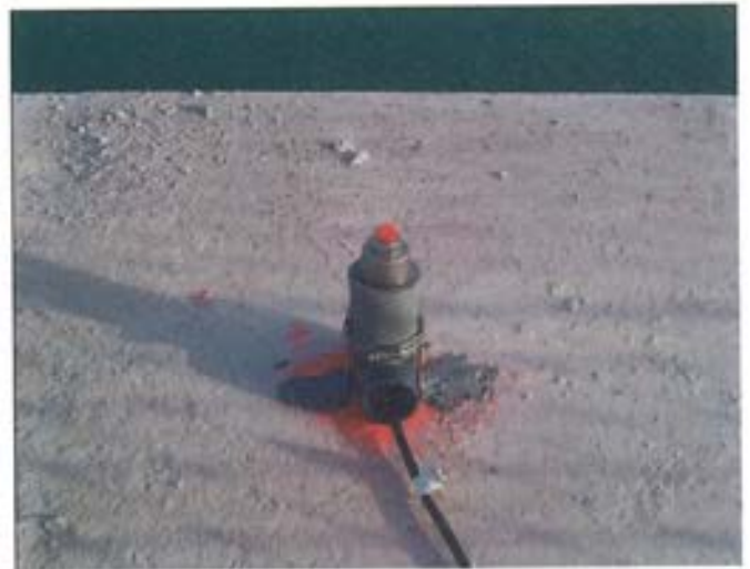
Figura 5.7.8. Sensores de presión hidrodinámica dispuestos en cubierta.
