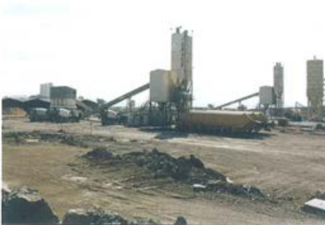
Figura 6.2.1. Plantas de hormigón.
