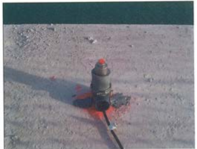
Figura 5.7.8. Sensores de presión hidrodinámica dispuestos en cubierta.
