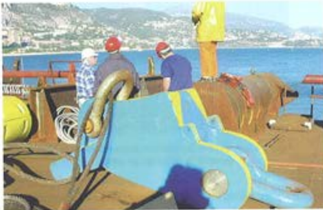
Fig. 5.2.11. Vista del equipo Stevensionner para control de la puesta en tensión de las cadenas.
