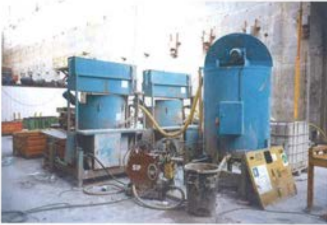
Figura 4.10. Equipo de inyección.
