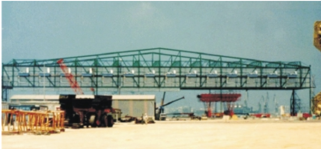
Fig. 28: Vista general de la nave de hormigonado con el sistema de aire acondicionado. Fig. 28: General view of the concrete-placing shed with the air-conditioning system.
