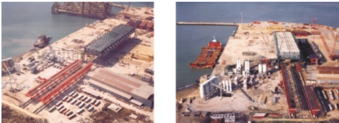
Fig. 10: Vistas generales de las instalaciones de hormigonado y embarque de los tableros. Fig. 10: General views of the concrete facilities and embarking of the spans.
