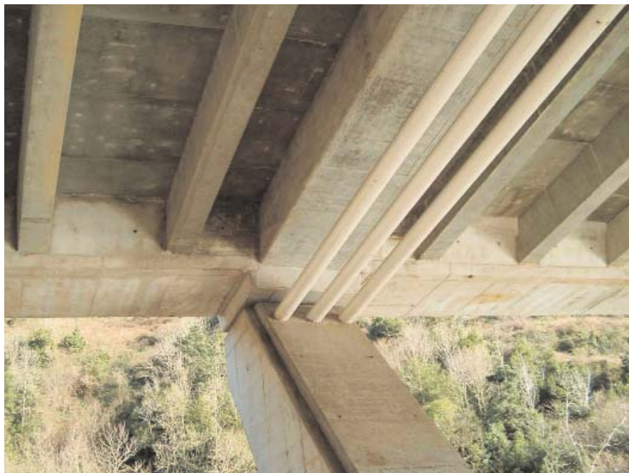
Figura 19. Detalle de la zona de apoyo del tablero sobre las pilas. Pueden apreciarse los tres tubos de atirantamiento transversal. Figure 19. Detail of the deck support area on the piers. The three cross stay tubes can be seen.
