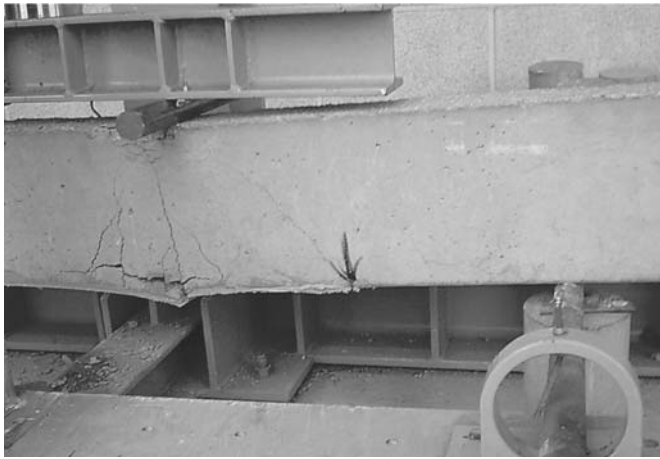
Foto 5. Rotura de la fibra. Rotura tipo 1.
