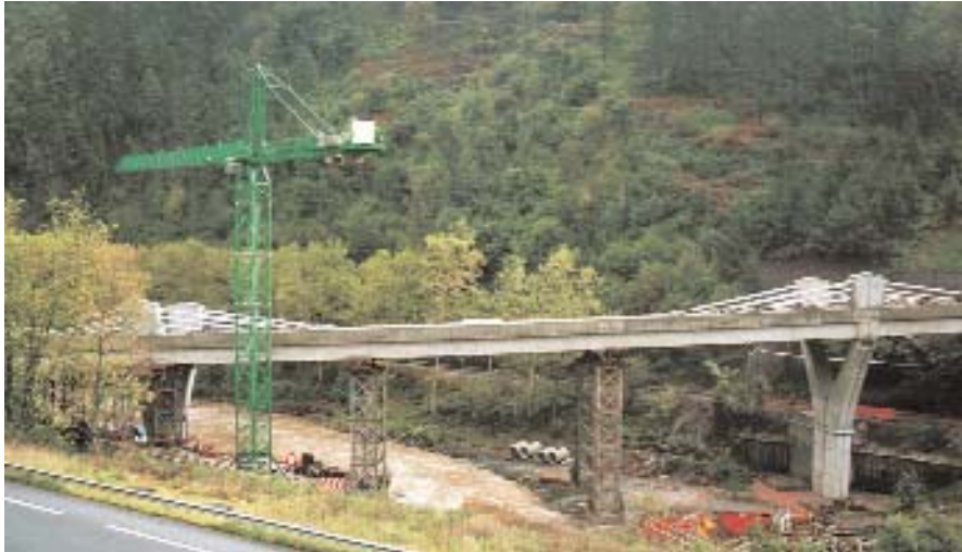
Figura 22. Tablero en fase de construcción. Vista lateral. Figure 22. Deck in the construction phase. Side view.
