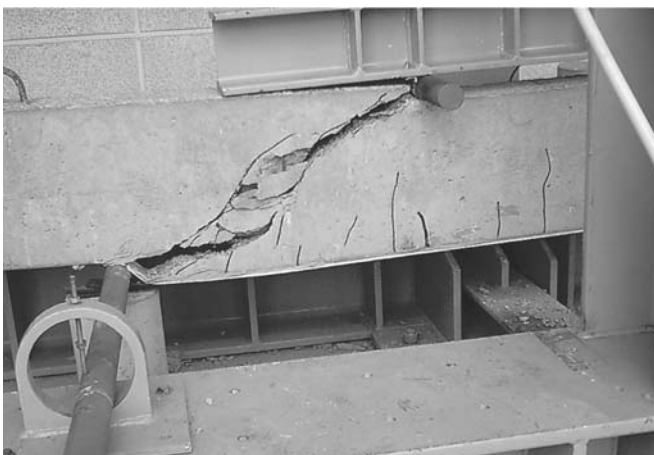
Foto 3. Rotura por cortante desde el extremo de la fibra. Rotura tipo 8.
