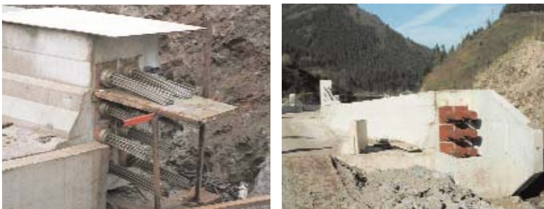
Figura 13. Anclajes de pretensado en un extremo del tablero. En la imagen de la izquierda, con el conjunto de tendones en fase de tesado. En la imagen de la derecha, protección exterior de los anclajes de pretensado extradosado. Figure 13. Prestressing anchorages at one end of the deck. In the left hand picture, with the group of cables in the tensioning phase. In the right hand picture, outside protection of the extradosed prestressing anchorages.
