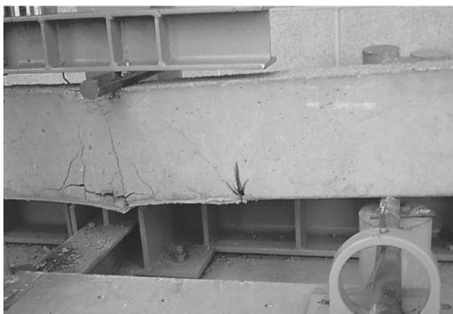
Foto 5. Rotura de la fibra. Rotura tipo 1.
