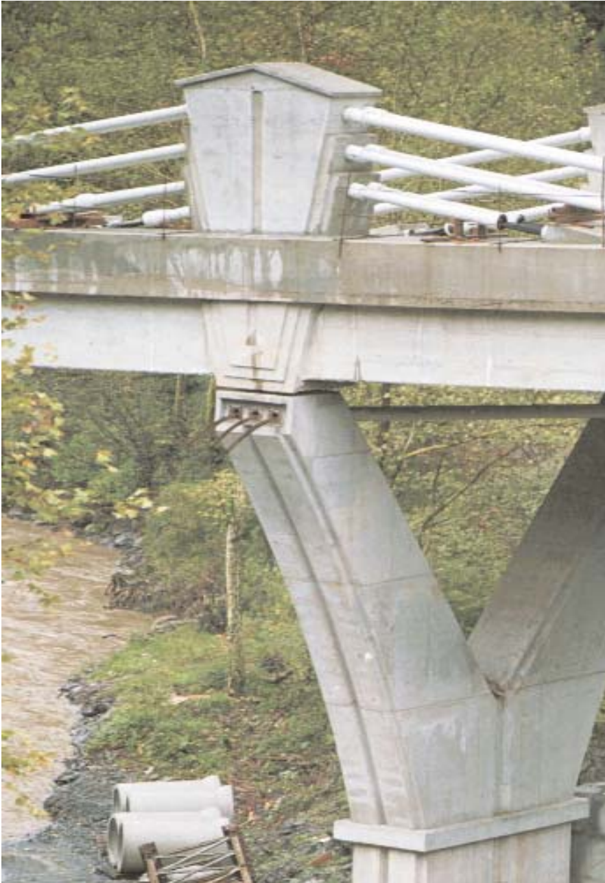
Figura 20. Detalle de la zona superior de una pila en proceso de construcción. Pueden apreciarse los extremos salientes de los tendones, que discurren por el interior de los tubos metálicos
