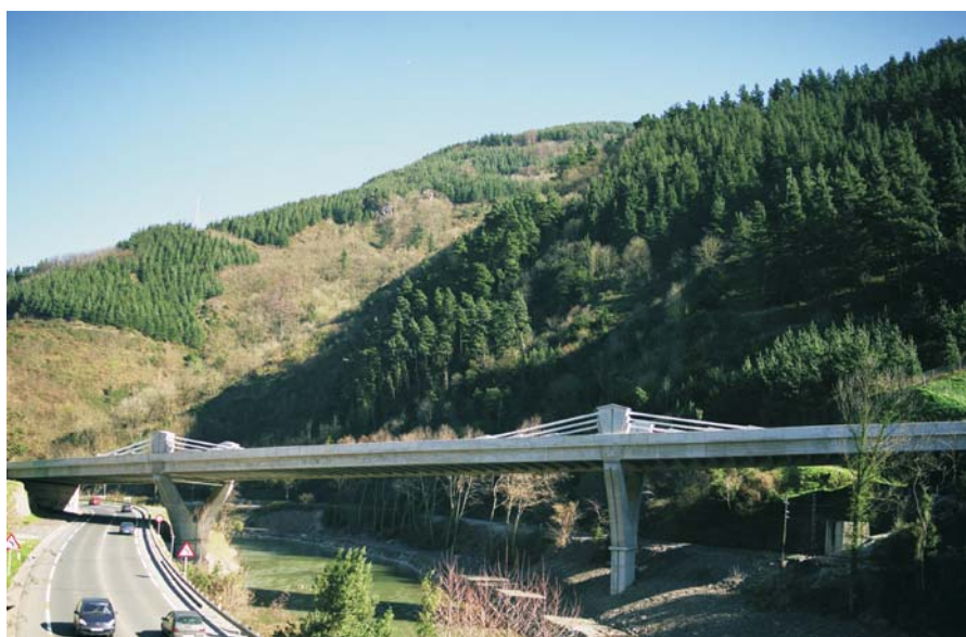
Figura 2. Puente sobre el río Deba. En la izquierda de la imagen aparece el paso de la Carretera N-634 por debajo del tablero. Figure 2. Bridge over the river Deba. The N-634 road appears passing under the deck on the left of the picture.
