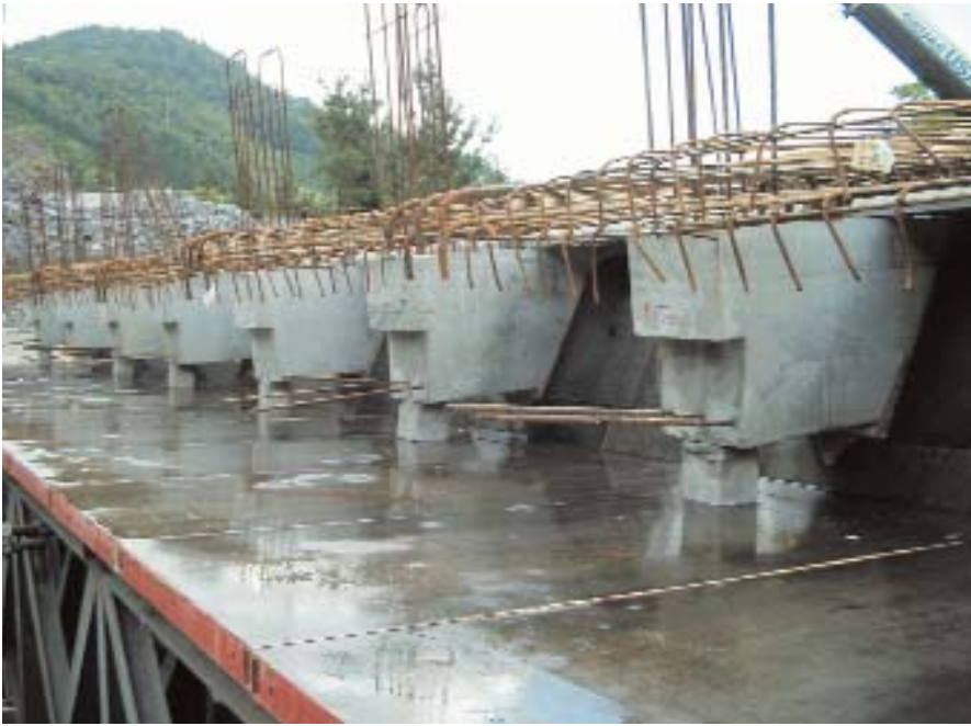
Figura 10. Vigas prefabricadas transversales, colocadas sobre el encofrado inferior de los nervios longitudinales. En una fase de construcción posterior, el extremo de las vigas quedará en el interior de la masa de hormigón de los nervios longitudinales. Figure 10. Prefabricated cross beams placed on the bottom formwork of the longitudinal ribs. The end of the beams will remain inside the longitudinal ribs' concrete mass in a subsequent construction phase.
