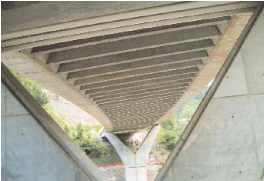
Figura 12. Aspecto del tablero, visto por la parte inferior. Figure 12. Appearance of the deck, seen from underneath.
