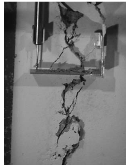
Figura 10. PC-JC. Estado en el que se encontraban las llaves en la fase de prerrotura.
