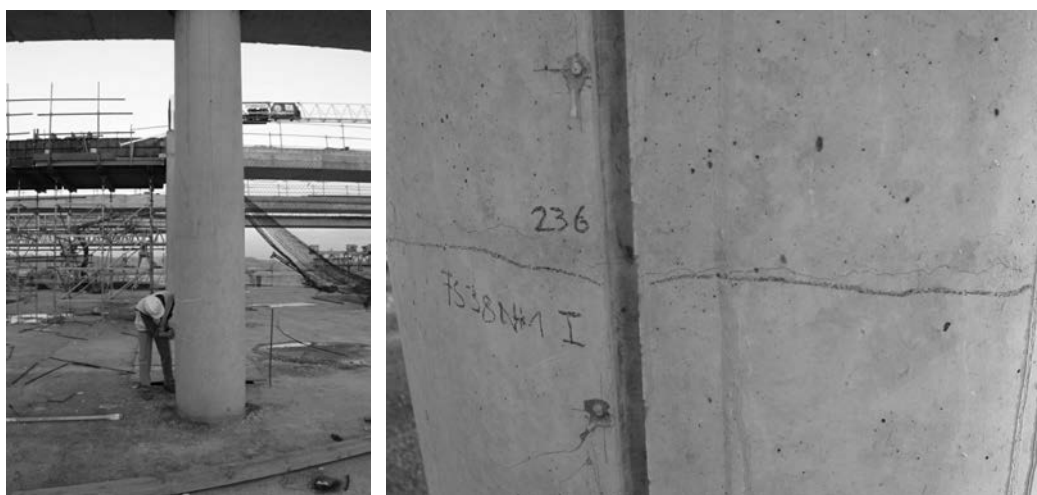
Figura 19. Fisuración horizontal detectada en los pilares extremos del pórtico en la zona de solape de las armaduras verticales.
