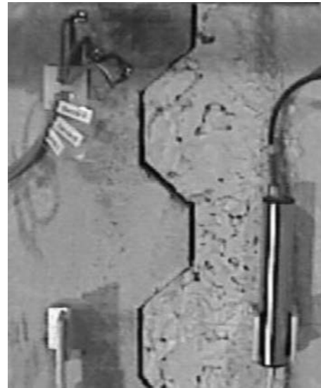
Figura 8. PC-C. Detalle de la junta instrumentada donde se aprecia la separación entre las llaves.
