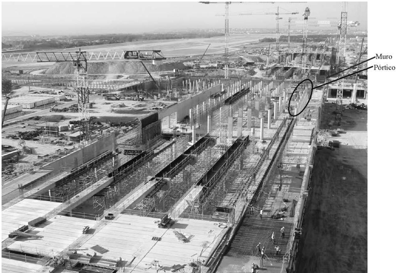
Figura 1. Vista aérea de la construcción del dique Norte del Edificio Satélite de la Nueva ÁREA Terminal del Aeropuerto de Barajas. En la imagen se ha señalado la ubicación de los elementos instrumentados.
