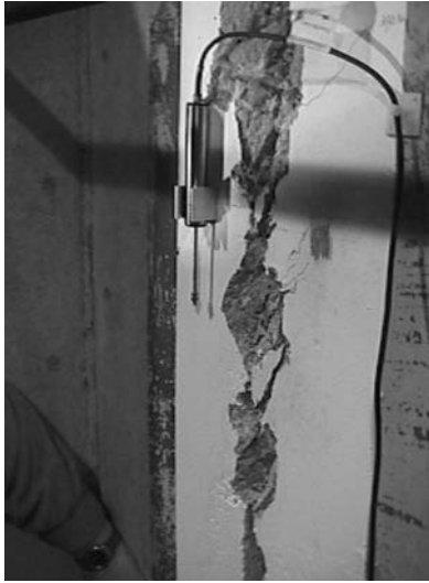
Figura 11. PC-JC. Estado en el que quedó la junta tras la rotura.
