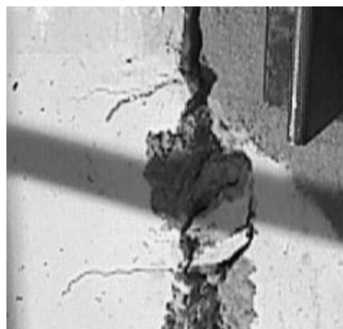
Figura 9. Detalle de la rotura de una llave PC-C.
