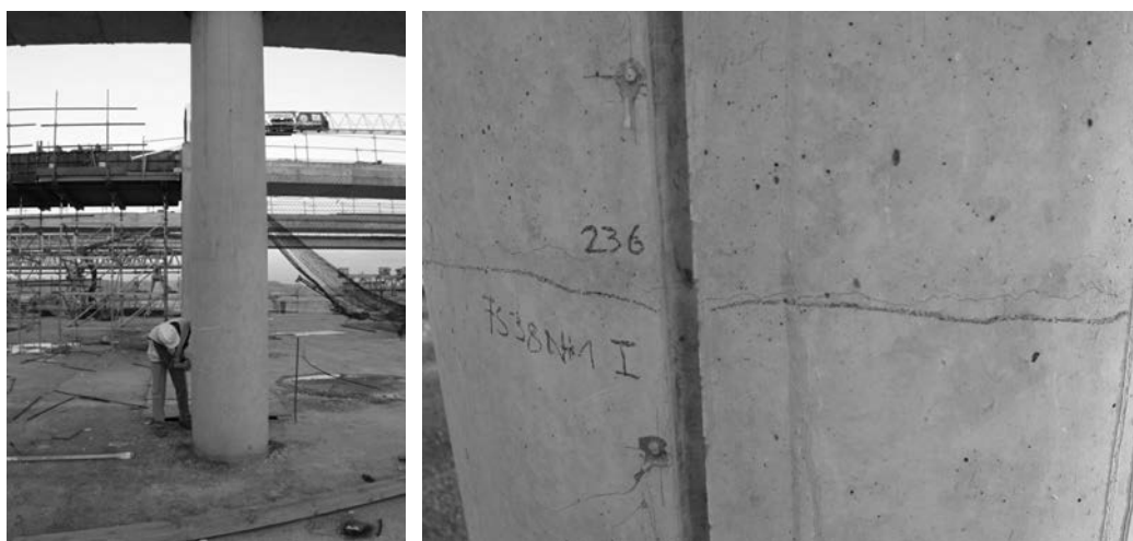
Figura 19. Fisuración horizontal detectada en los pilares extremos del pórtico en la zona de solape de las armaduras verticales.
