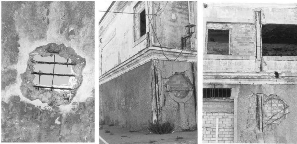
Figura 2. Degradación de estructura en ambiente agresivo.
