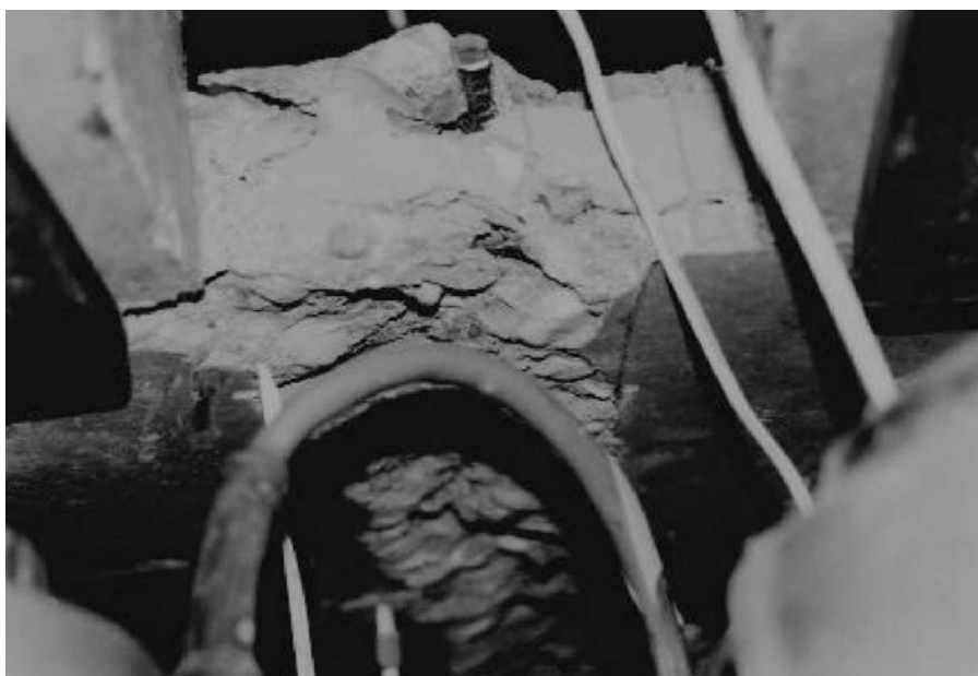
Foto 1. Rotura por compresión de la losa inferior.
