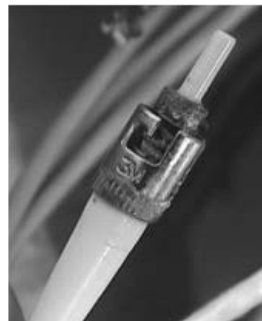
Figura 14. Detalle de un conector exterior del sensor donde se aprecia el ataque.
