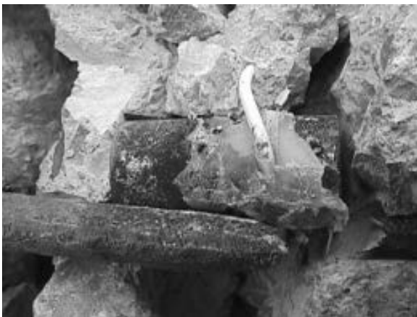
Figura 13. Posición del sensor y estado de las armaduras en una de las vigas ensayadas.
