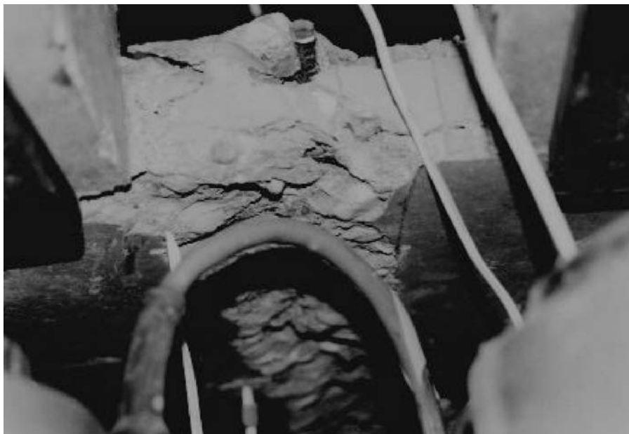
Foto 1. Rotura por compresión de la losa inferior.
