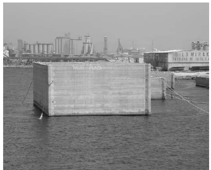
Foto1. Cajón portuario recién construido en el Puerto de Barcelona (UTE Nueva Bocana).
