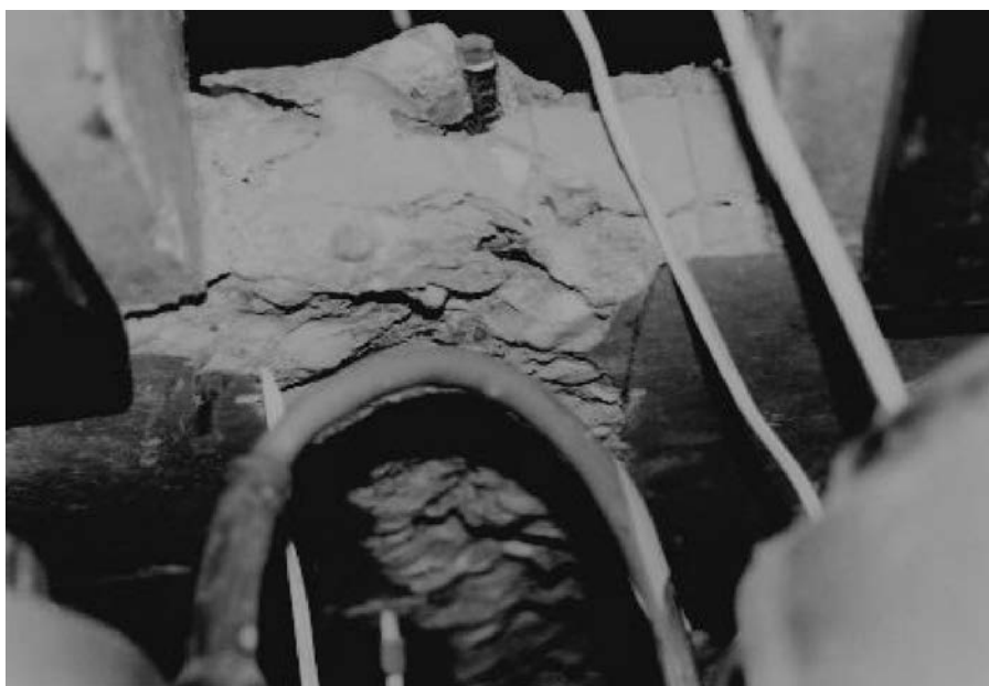
Foto 1. Rotura por compresión de la losa inferior.
