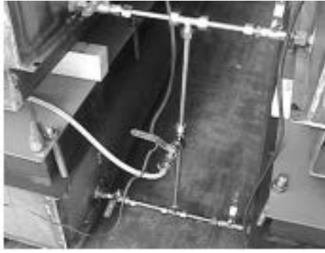
Fotografía 14. Instalación rígida por la que se inyecta el gas.
