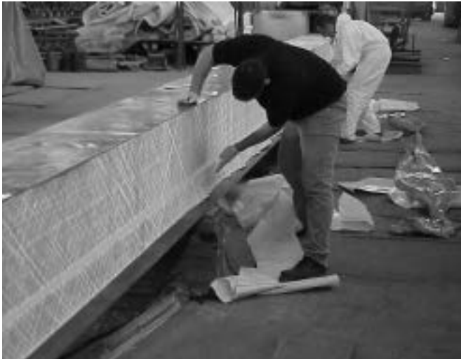
Figura 11: Detalle de la colocación de una banda de GFRP sobre el molde.
