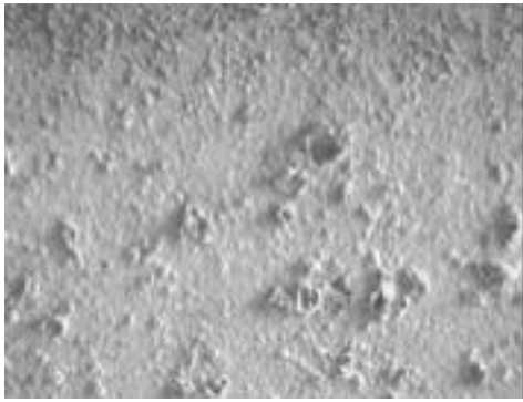
Fotografía 11. Explosiones en la superficie de las vigas.
