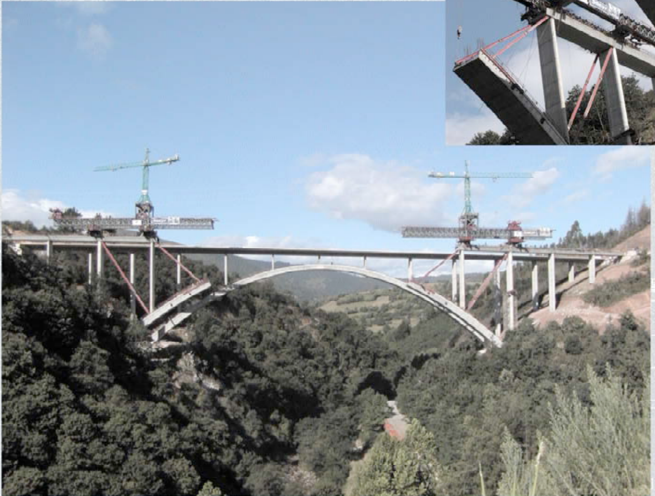
Viaducto de Cieza. Autovía Cantabria - Meseta. Subtramo: Corrales de Buelna (sur) - Molledo
