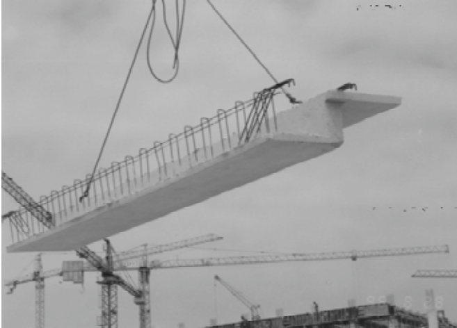
Foto 15. Placa especial pasillos entre aulas.
