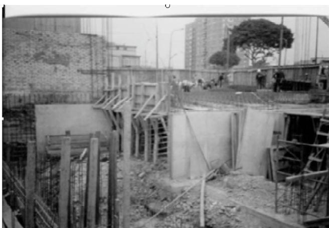
Figura 12(a). Primer edificio con disipadores SL, en la ciudad de Lima, Perú.
