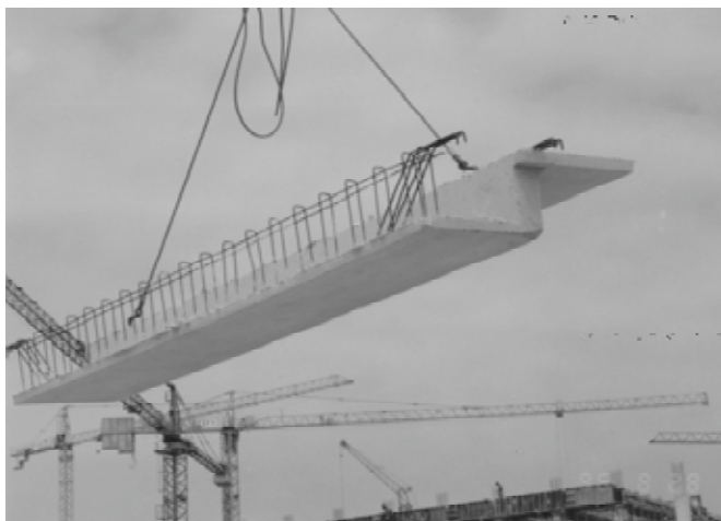
Foto 15. Placa especial pasillos entre aulas.
