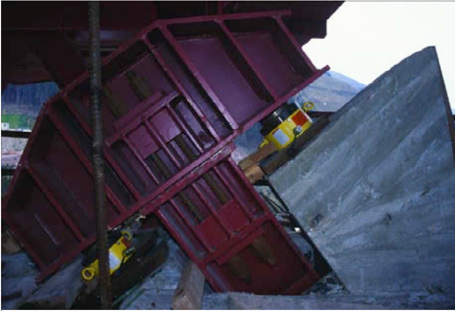
Figura 14. Gatos de retesado de los tirantes sobre el tablero. Figure 14. Hydraulic jacks for the tie rods fixed into the deck.
