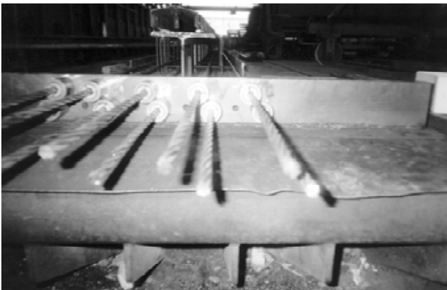
Foto 30. Cables de pretensado. Armaduras activas,
