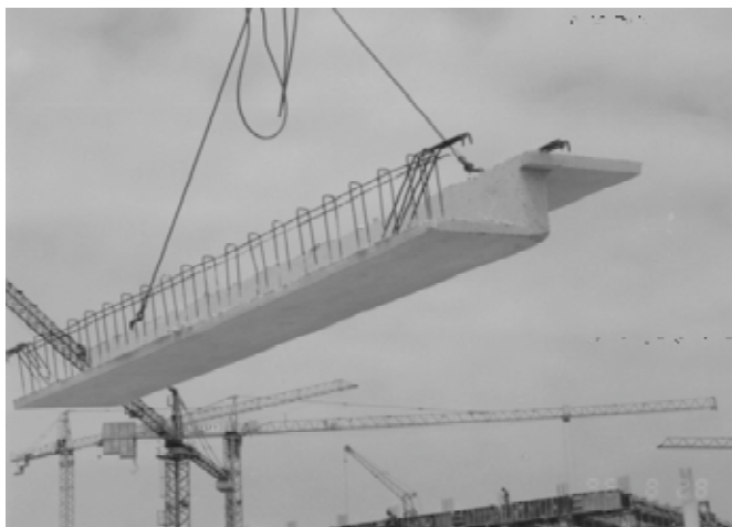
Foto 15. Placa especial pasillos entre aulas.
