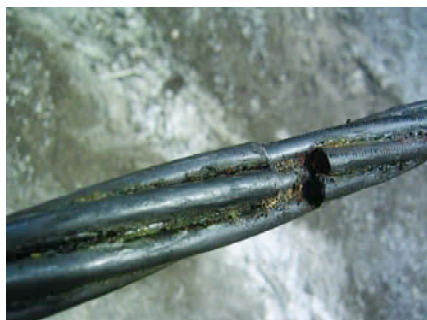
Figura 19. Alambres seccionados. Figure 19. Split wire strands.
