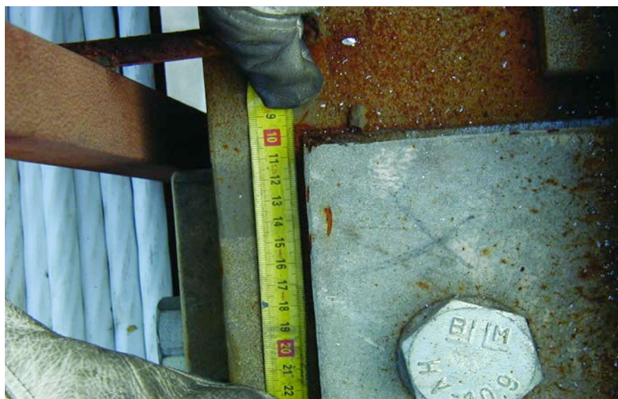
Figura 22. Primer deslizamiento de la unión. Figure 22. Union first sliding.
