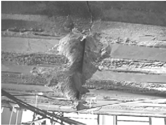
Figura 11. Detalle del desprendimiento del laminado en la zona de junta. Ensayo VD-CFK1.
