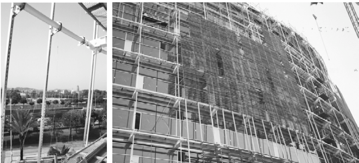
Figura 26. Detalle de tubo perimetral y montantes para sujeción de cerramiento exterior con lamas de madera, y detalle de fachada exterior.
