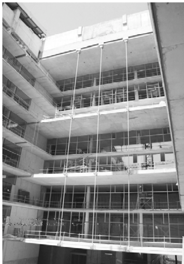
Figura 20. Interior del Sector I colgado con 2 HEM 300, y 3 tirantes de 76 mm de diámetro.
