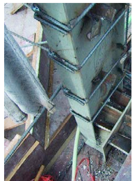
Figura 16. Detalle tipo para la conexión con perfiles tubulares y pletinas de refuerzo.
