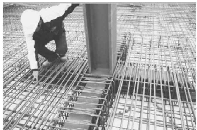
Figura 17. Tirantes interiores de Sectores II, y III. Unión mediante cruceas a forjados.
