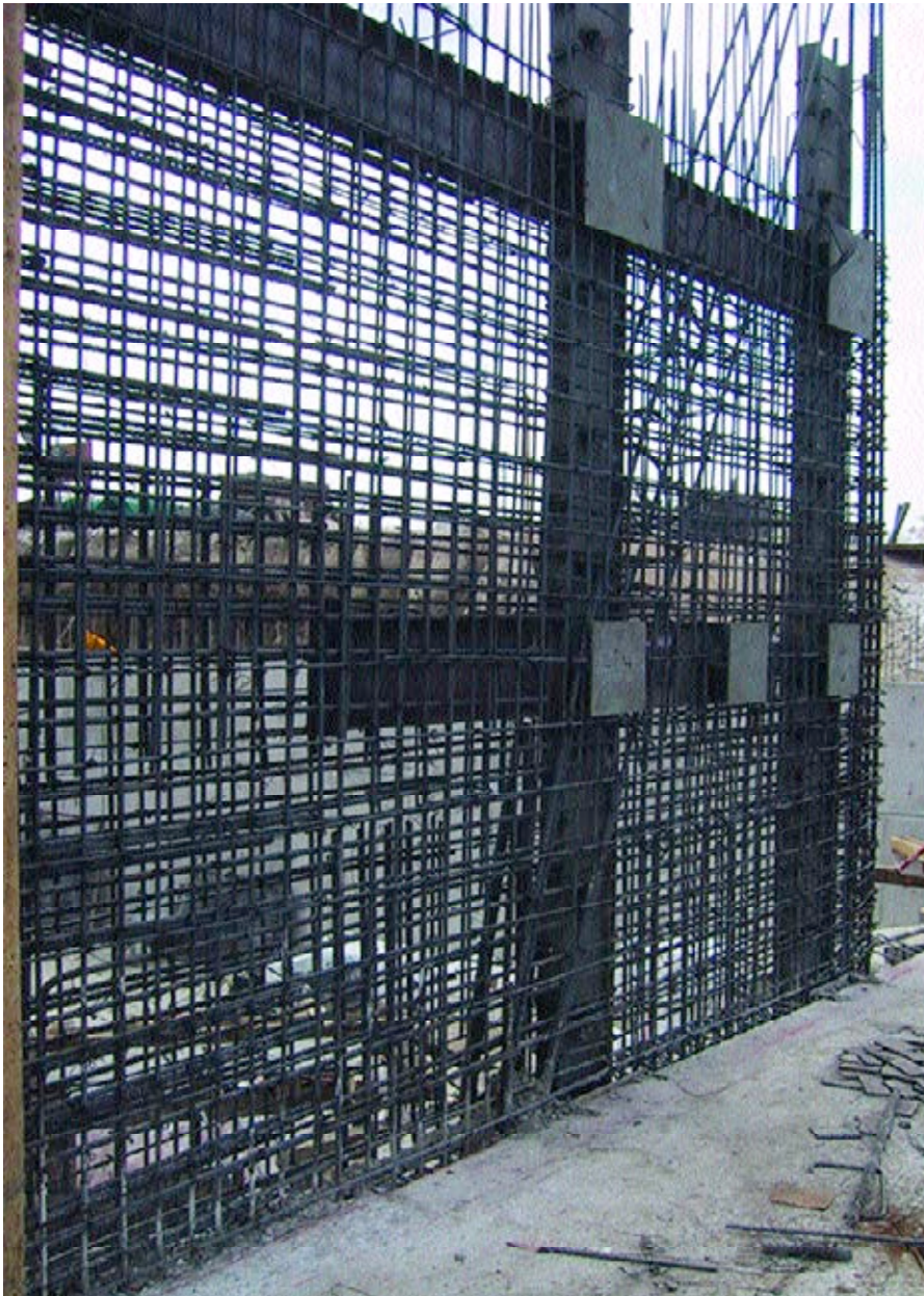
Figura 15. Conexión entre los muros de hormigón y las vigas pared de acero (plantas inferiores suspendidas).
