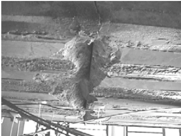
Figura 11. Detalle del desprendimiento del laminado en la zona de junta. Ensayo VD-CFK1.
