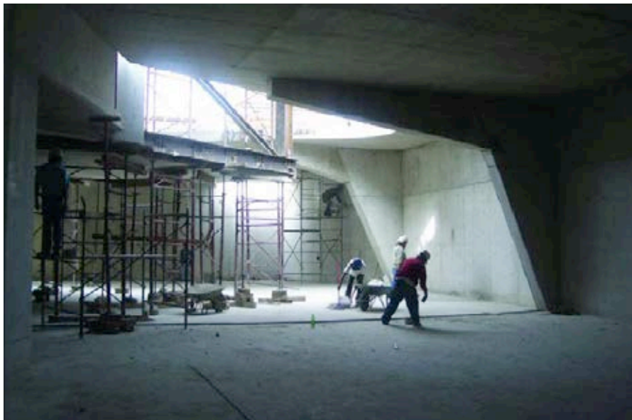
Figura 5. Zona del estacionamiento planta sótano -1 con los apoyos de sección variable y luces libres de aproximadamente 13 m.
