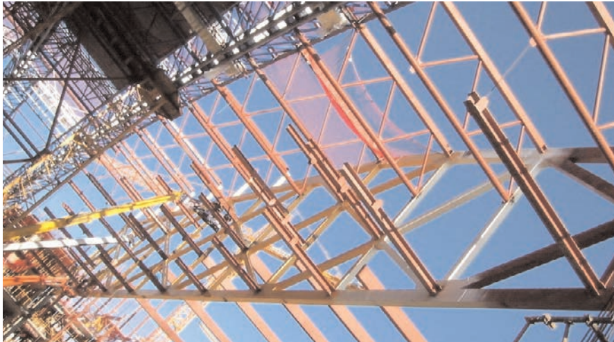
Figura 8. Alzado y foto del tímpano lateral. Figure 8. Front view and foto of the lateral spandrel truss.
