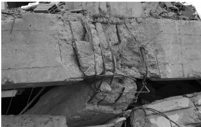
Figura 3. Agotamiento de un nudo de conexión viga-pilar.
