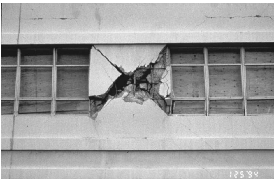
Figura 1. Rotura por cortante de un pilar corto.
