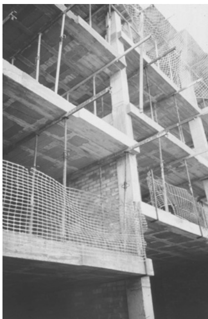
Figura 7. Pilares cortos en todos los pisos de un edificio.
