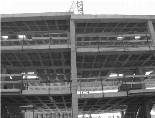
Figura 9. Edificio con zonas de un pilar sometidas a corte directo en caso de sismo.
