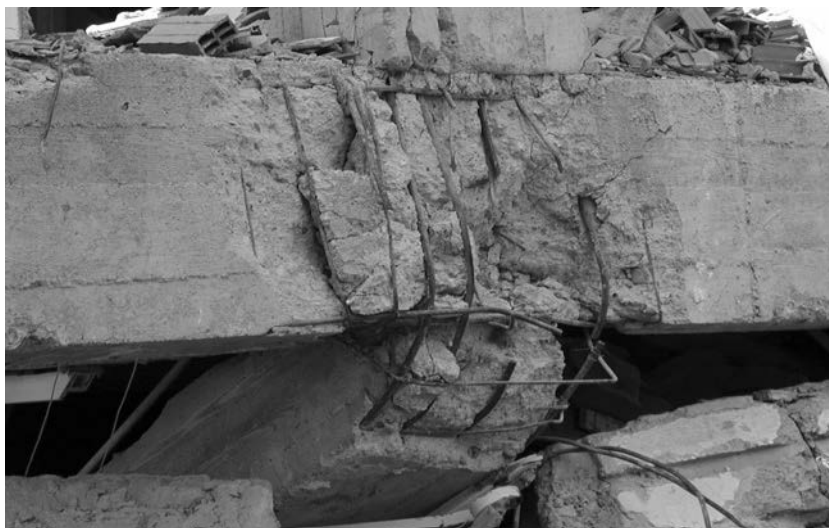
Figura 3. Agotamiento de un nudo de conexión viga-pilar.
