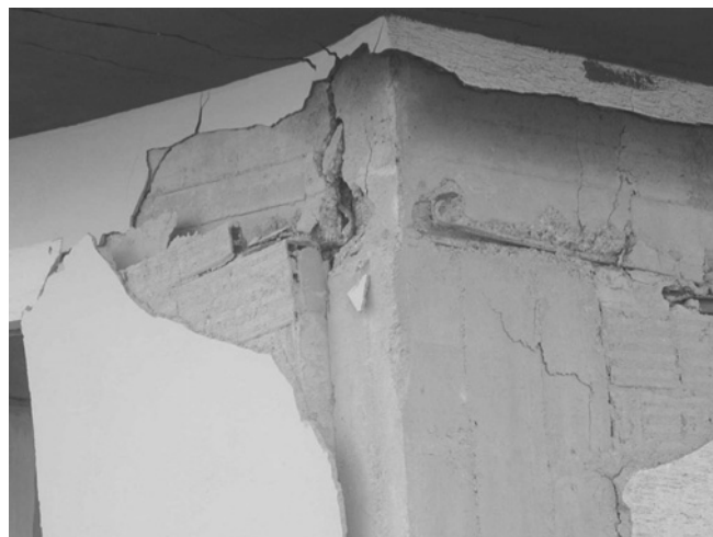
Figura 4. Refuerzos sin conexión en el nudo, con insuficiente recubrimiento.
