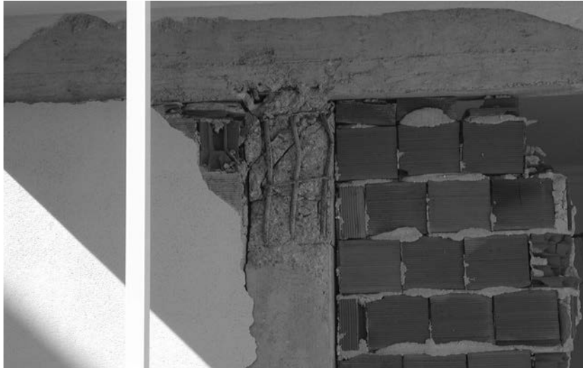
Figura 2. Pandeo de las barras longitudinales por falta de armadura transversal
