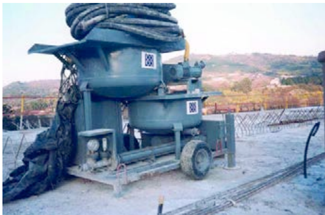
Figura 9. Equipo de inyección.
