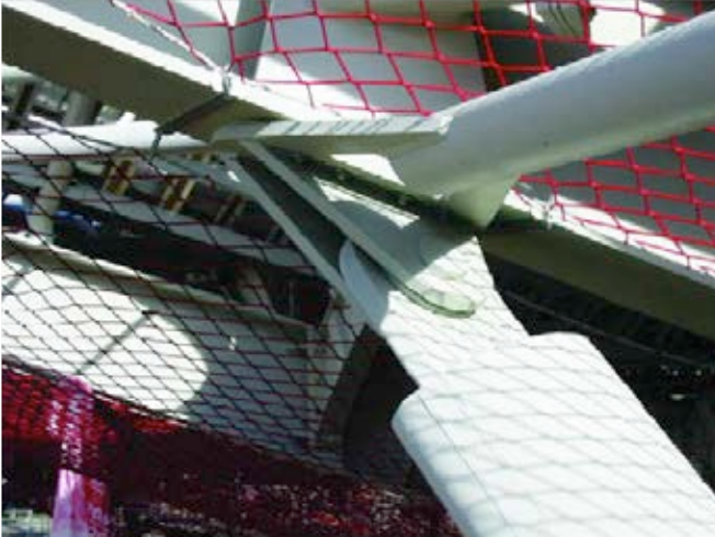
Figura 9. Estructura metálica. Calidad de las soldaduras.
