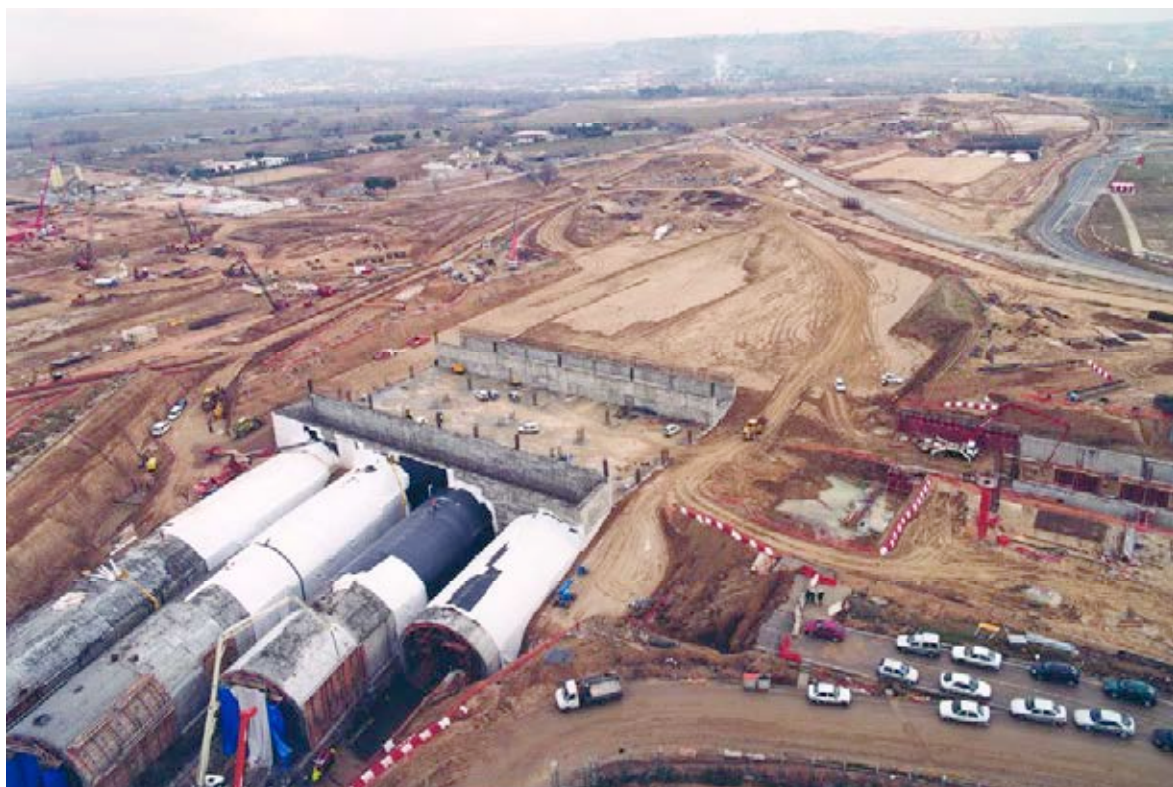
Figura 17. Zona de Dique Sur sobre el Túnel de la M-111. Distintas etapas durante la construcción.
