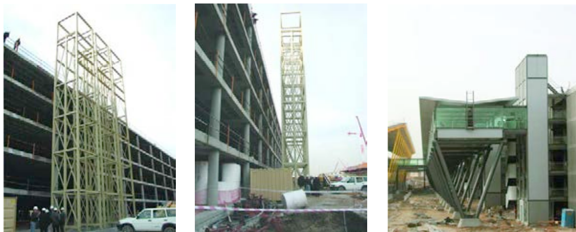
Figura 27. Ascensores y montacargas panorámicos de circulación vertical.
