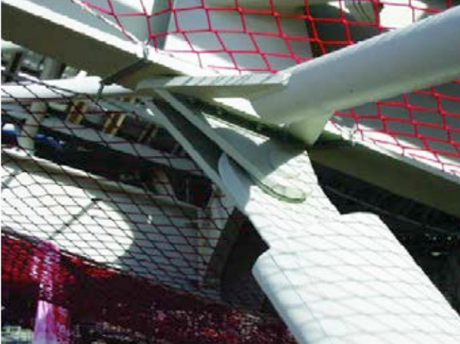
Figura 9. Estructura metálica. Calidad de las soldaduras.
