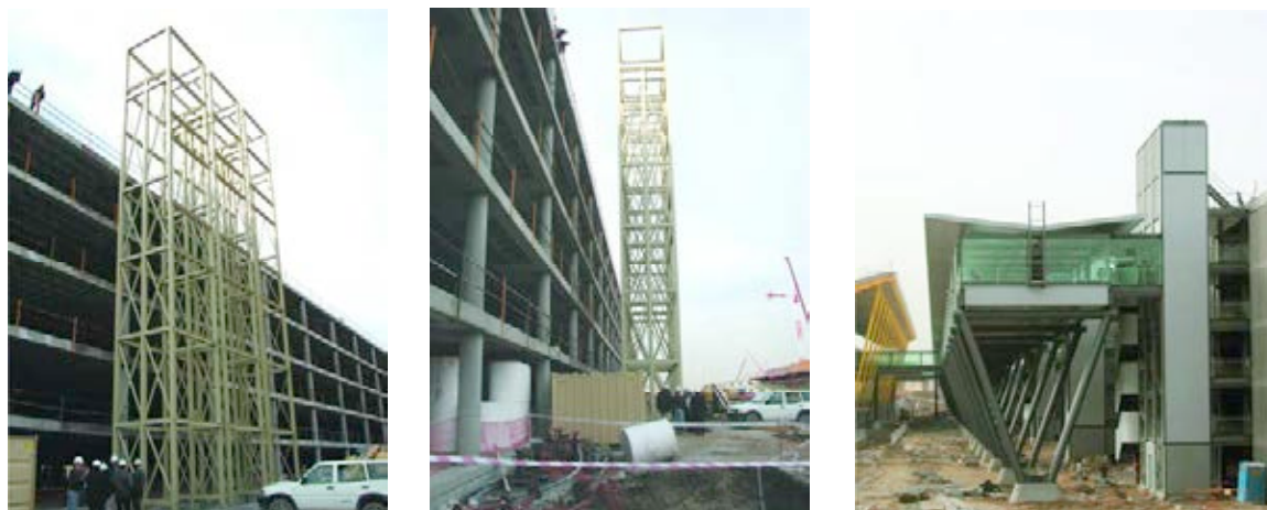
Figura 27. Ascensores y montacargas panorámicos de circulación vertical.
