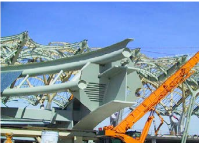
Figura 10. Estructura metálica. Calidad de las soldaduras y uniones atornilladas I.
