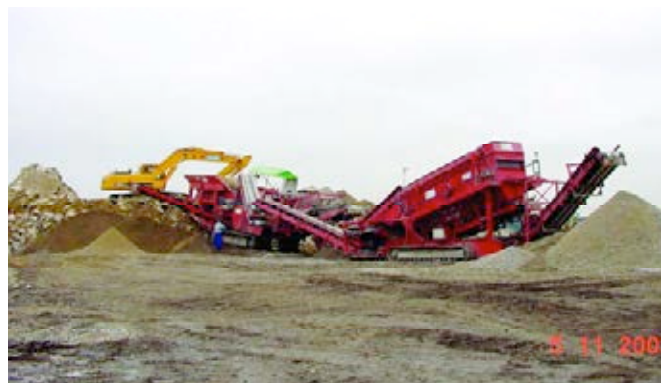
Figura 16. Instalación de tratamiento de áridos.
