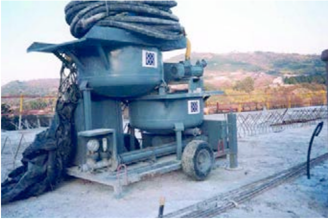
Figura 9. Equipo de inyección.
