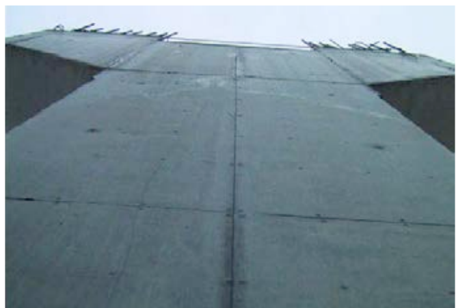
Figura 7. Estructura en zonas no públicas. Acabado de la superficie del hormigón I.
