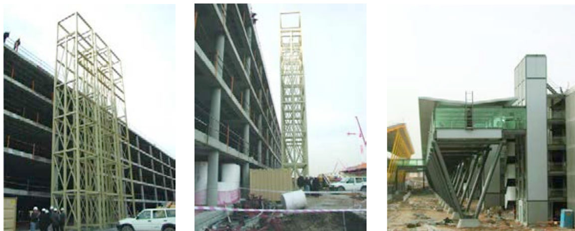
Figura 27. Ascensores y montacargas panorámicos de circulación vertical.
