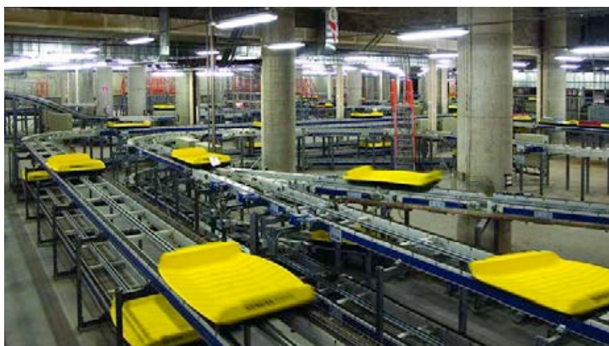
Figura 12. Sistema Automatizado de Tratamiento de Equipajes. Figure 12. Automated Baggage Handling System.
