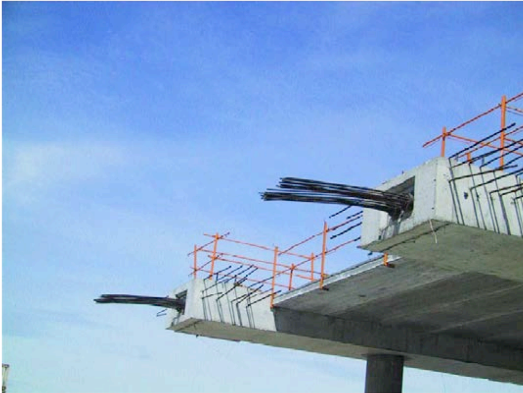
Figura 1. Anclajes de tendones de postesado en vigas.
