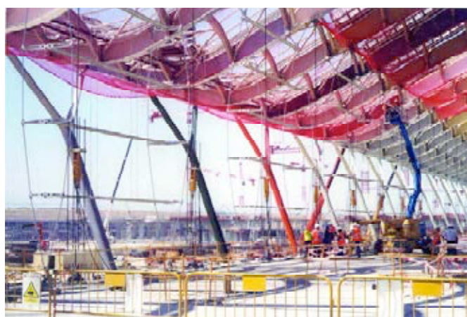
Figura 7. Vista de ocho de los gatos del sistema.
