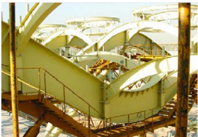
Figura 11. Estructura metálica. Calidad de las soldaduras y uniones atornilladas II.
