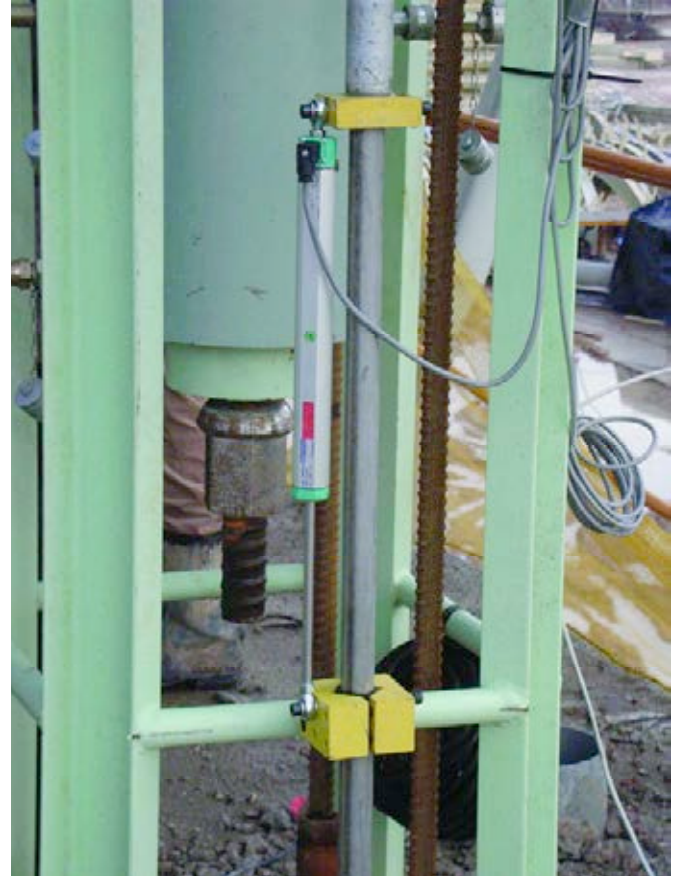
Figura 17. Detalle de transductor lineal de desplazamiento junto al gato de tesado.
