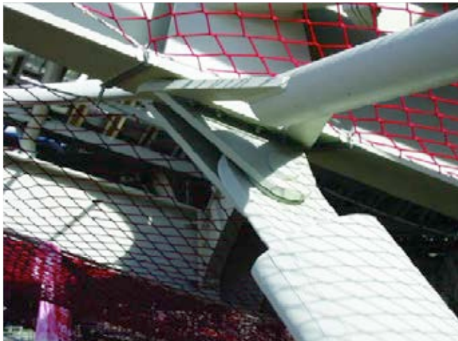
Figura 9. Estructura metálica. Calidad de las soldaduras.
