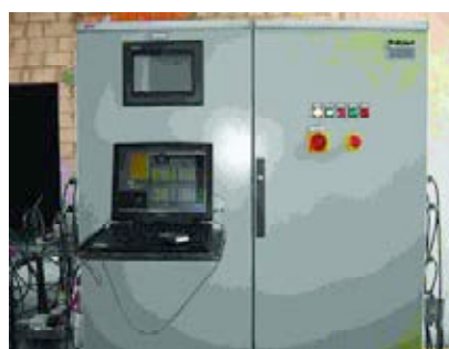
Figura 18. Autómata para la realización y el control del tesado.
