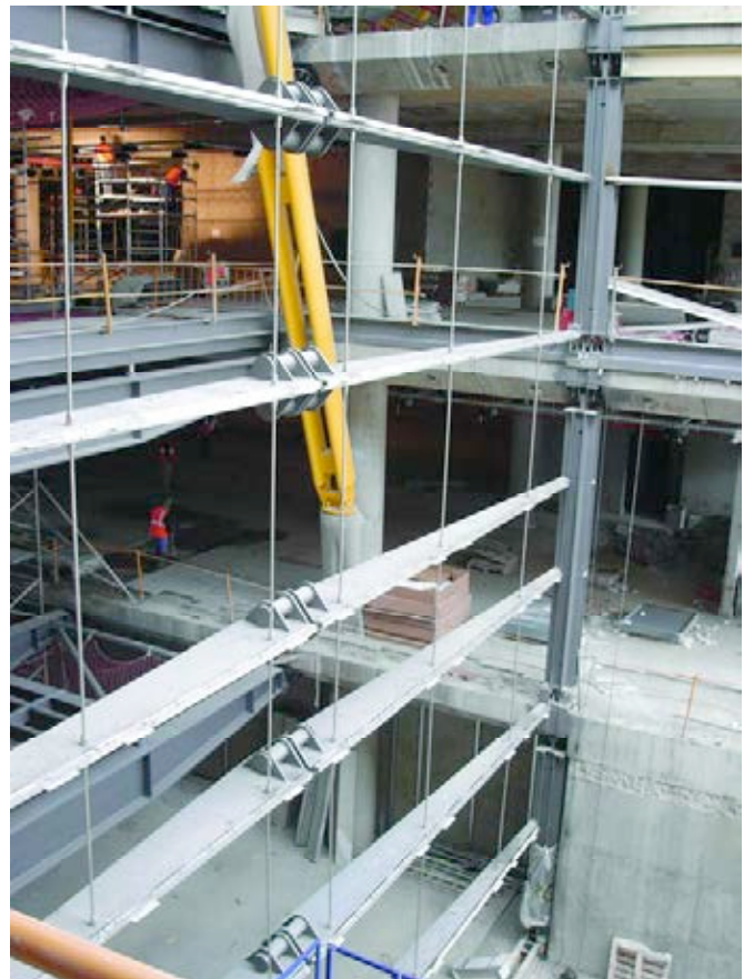
Figura 6. Muro cortina tipo B-2, vista exterior previa a la colocación del vidrio.
