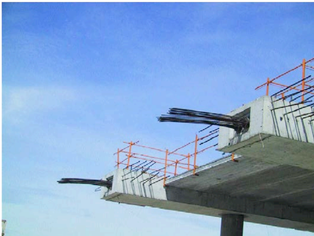
Figura 1. Anclajes de tendones de postesado en vigas.
