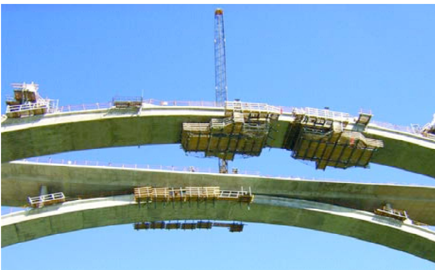
Fig.27. Carros de avance en posición final. Fig.27. Advancing carriages in the final position.
