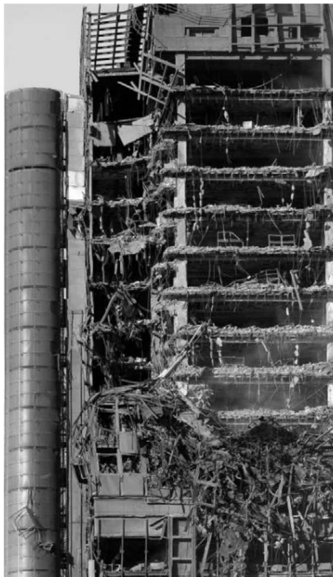
Figura 2. La estructura de hormigón después de resistir el incendio.
