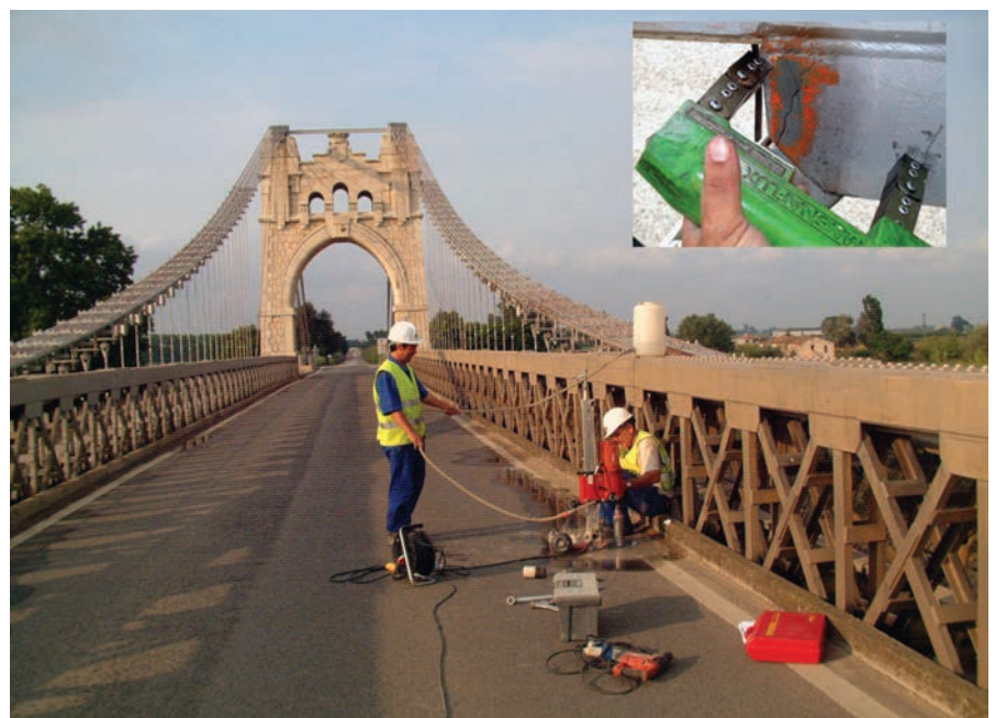
Figura 27. Extracción de testigos de la losa de hormigón y ensayo de partículas magnéticas. Figure 27. Core extraction from the concrete slab and detail of the magnetic particle test.
