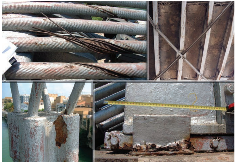
Figura 29. Deterioros: cables principales, forjado de hormigón del tablero, mazarota de una péndola y rodillos y tope transversal de una silla. Figure 29. Damage: main cables, deck's concrete slab floor, a suspender's head block and a saddle's rollers and cross stop.
