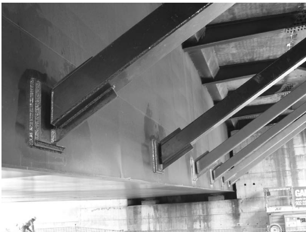
Figura 6. Unión inferior de los jабalcones.
