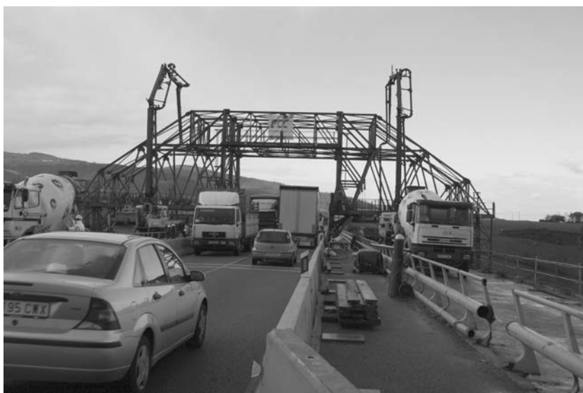
Figura 9. Circulación de camiones sobre la ampliación ejecutada.
