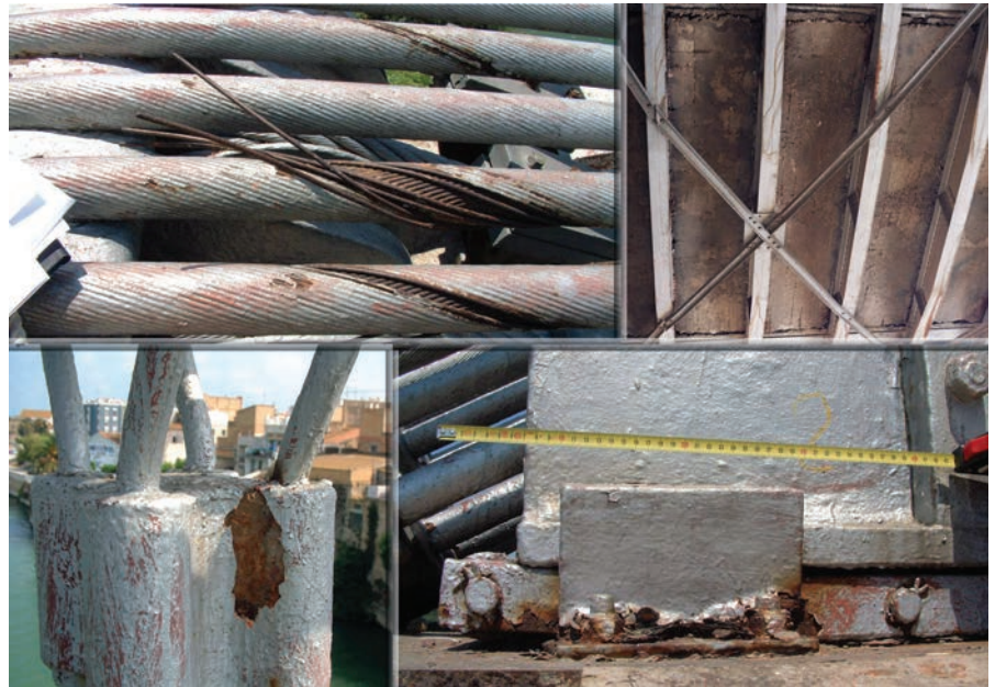
Figura 29. Deterioros: cables principales, forjado de hormigón del tablero, mazarota de una péndola y rodillos y tope transversal de una silla. Figure 29. Damage: main cables, deck's concrete slab floor, a suspender's head block and a saddle's rollers and cross stop.
