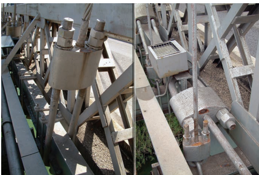
Figura 24. Anclajes del tirante inclinado y del cable horizontal. Figure 24. Inclined stay and horizontal cable elements.
