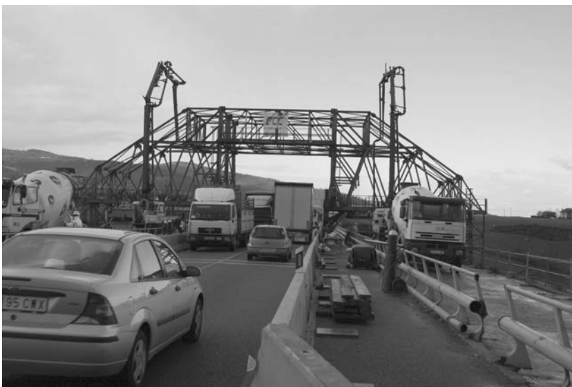
Figura 9. Circulación de camiones sobre la ampliación ejecutada.
