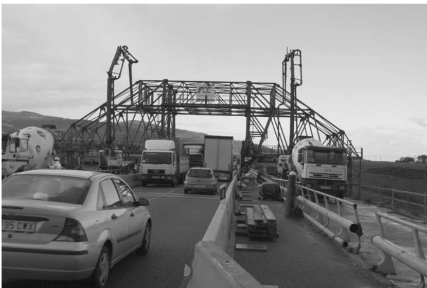
Figura 9. Circulación de camiones sobre la ampliación ejecutada.
