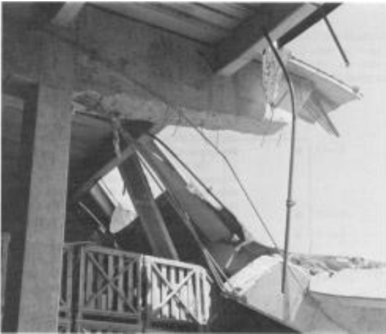
Figura 11. Rotura de una de las vigas en Shelby (Ohio).
