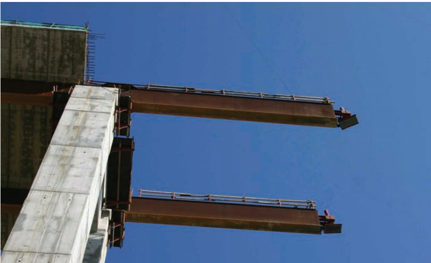
Figura 18. Zona frontal del tablero en fase de empuje. Figure 18. Deck's front area in the pushing phase.
