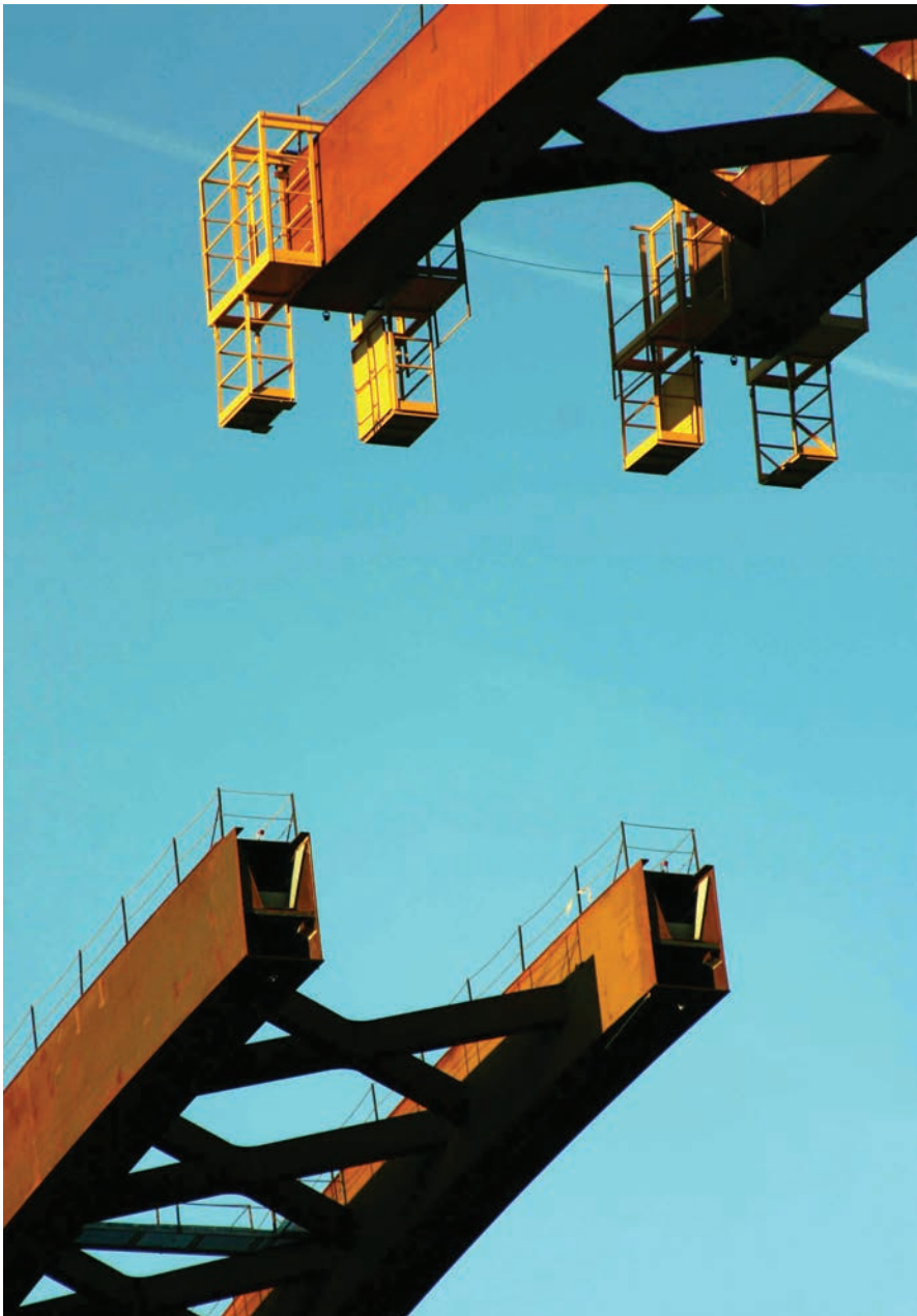
Figura 51. Extremo frontal de semiarcos en posición previa al cierre en clave. Figure 51. Front end of semi-arches prior to crown closure.
