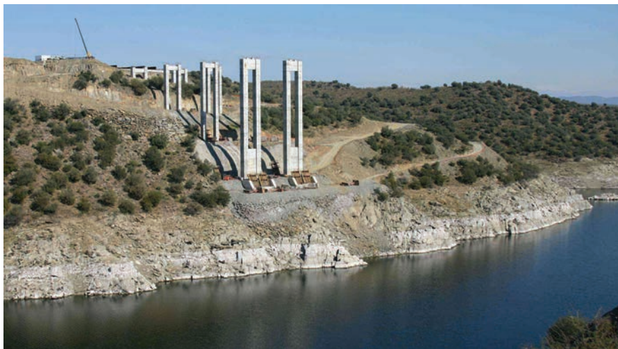
Figura 14. Construcción de macizos de arranque de arcos, pilas de hormigón y estribos. Figure 14. Construction of springing blocks of arches, concrete piers and abutments.
