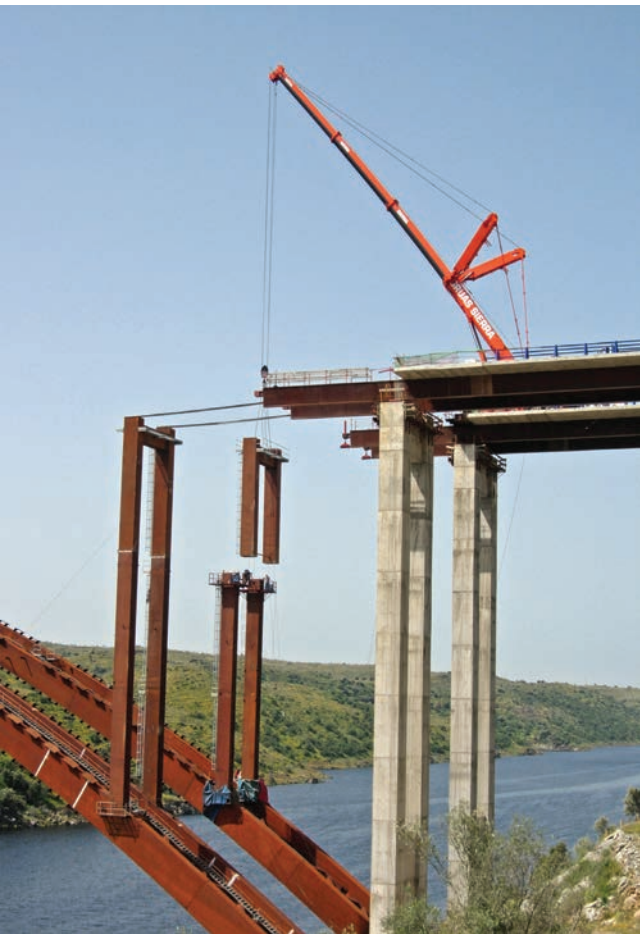
Figura 39. Montaje de pilas metálicas con grúa sobre tablero. Figure 39. Crane mounting metal piers on deck.
