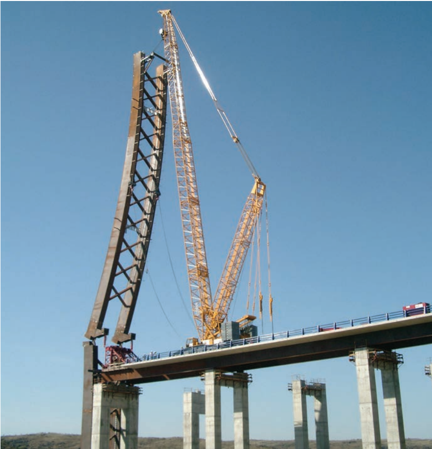
Figura 26. Posición final de izado de tablero con grúa. Figure 26. Final crane deck hoisting position.
