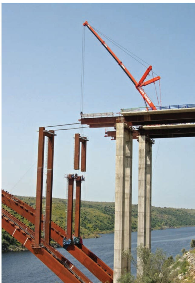
Figura 39. Montaje de pilas metálicas con grúa sobre tablero. Figure 39. Crane mounting metal piers on deck.
