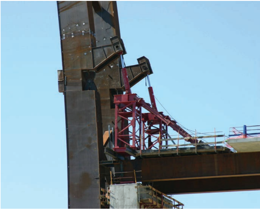
Figura 28. Posición final de basculamiento del segundo cuarto de arco. Figure 28. Final tilting position of the second quarter arch.
