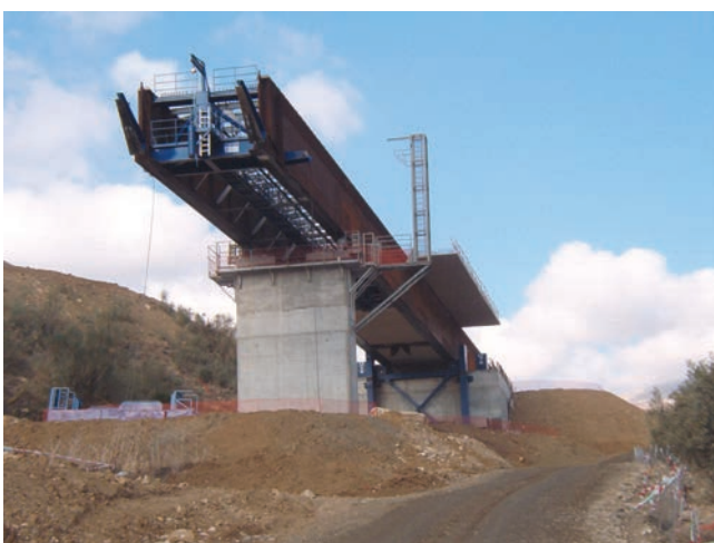
Fig. 19. Vista frontal de los patines de empuje. Fig. 19. Front view of the launching skids
