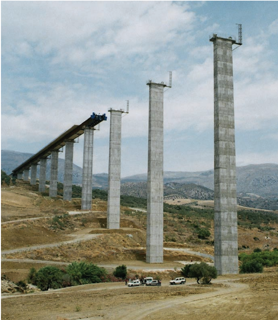
Fig. 2. Vista de las pilas durante el empuje del tablero. Fig. 2. View of the piers during deck launching .
