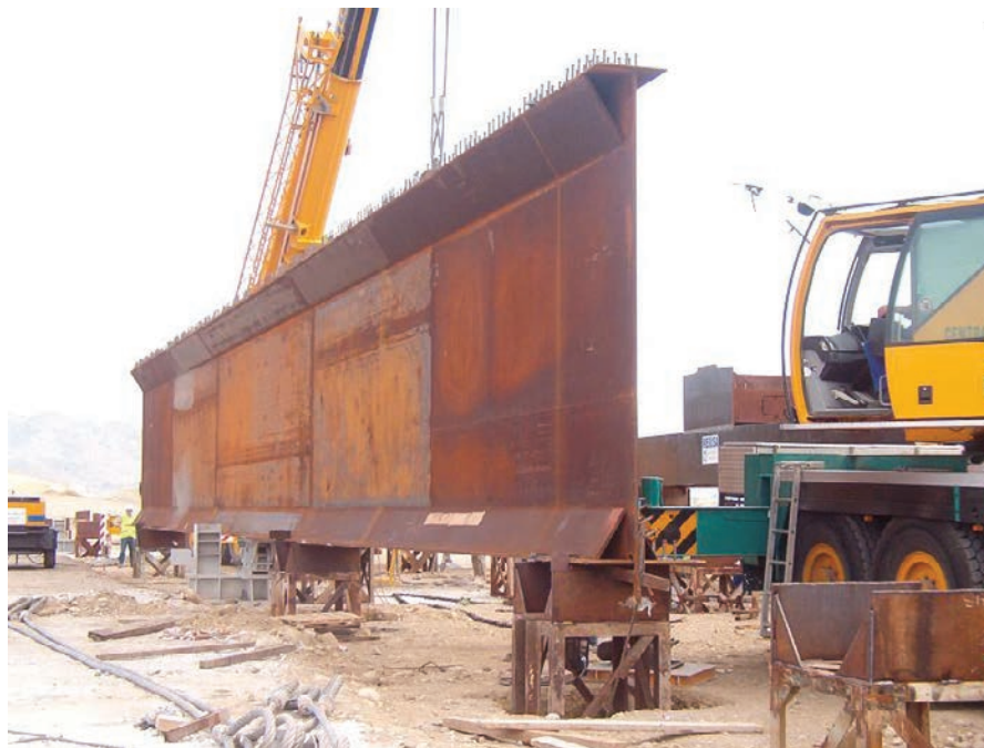
Fig. 9. Transporte y colocación de una viga metálica. Fig. 9. Transporting and placing a metal girder.
