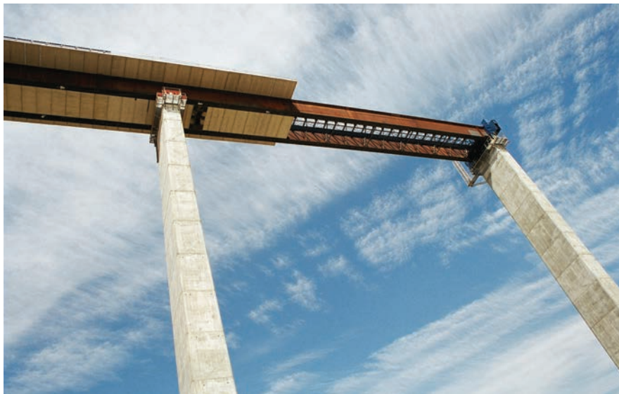
Fig. 14. Vista del primer vano sin prelasas inferiores ni superiores durante el empuje. Fig. 14. View of the first span with no top or bottom pre-slabs during launching
