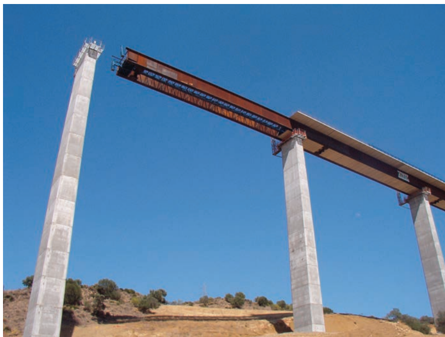
Fig. 23. Vista del voladizo antes de llegar a pila durante el empuje. Fig. 23. View of the cantilever before reaching a pier during launching.
