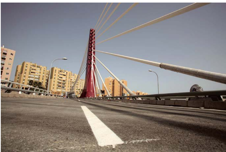
Figura 25. Tirantes con tubo antivandálico. Figure 25. Stays with antivandalism pipe
