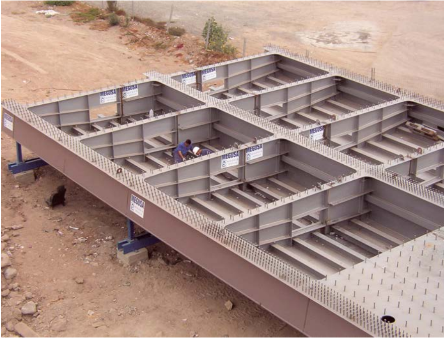
Figura 32. Unión de módulos en obra sobre bancadas de apoyo. Figure 32. Onsite welding of modules on support benches
