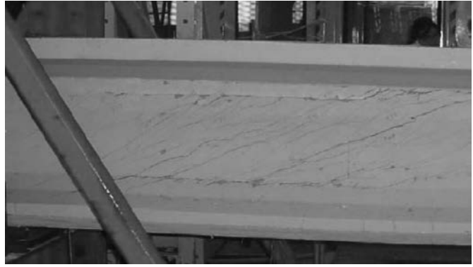
Figura 7. Rotura por cortante de la viga HAP1TE.
