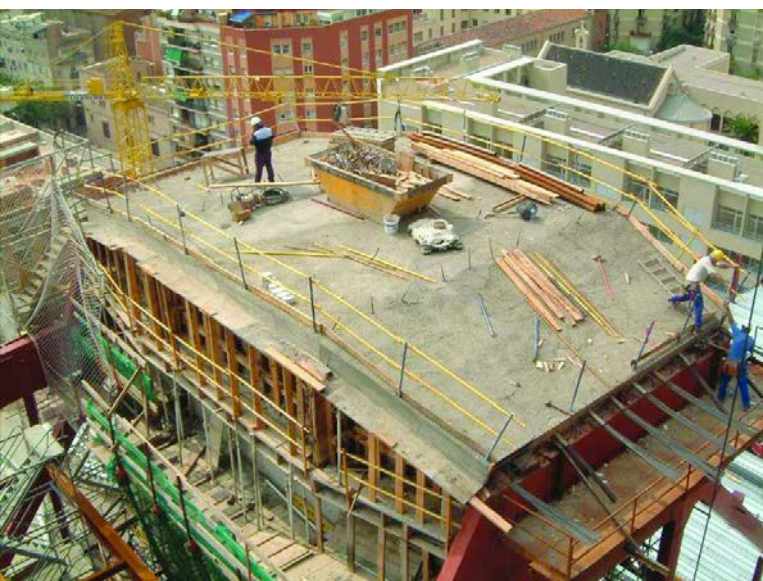
Figura 20. Vista de la estructura del elemento de suspensión durante el pretensado de la losa superior. Figure 20. View of the hanging structure during the prestressing of the upper slab.
