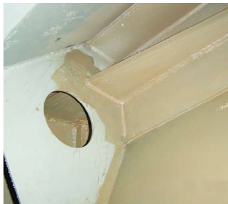
Figura 42. Refuerzo de los rigidizadores en puntos de concentración de fuerzas. Figure 42. Reinforcement of the stiffeners at stress concentration points.
