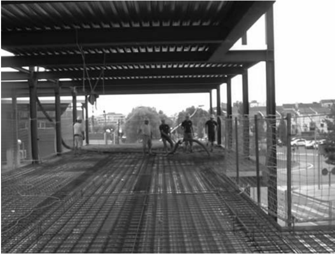
Figura 46. Hormigonado del forjado colaborante, conectado a los pórticos transversales mediante tornillos autoroscantes.
