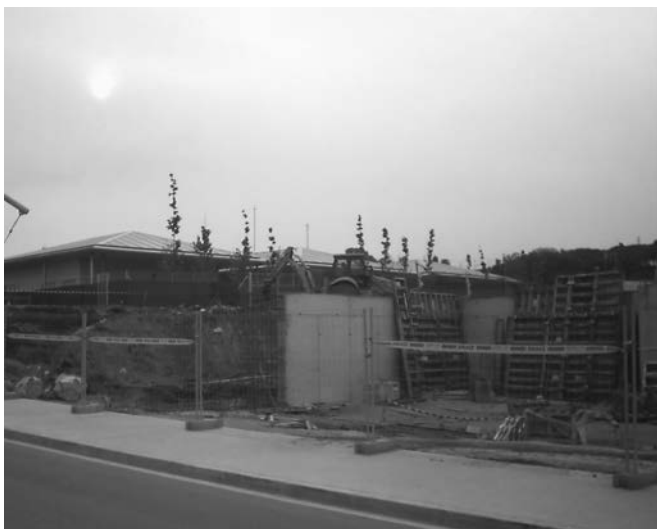
Figuras 38 y 39. Muros de contención recalce de la cimentación de la primera fase de Infantil (caracolas con cubiertas piramidales) del CEIP, para construir el edificio contiguo de Primaria.
