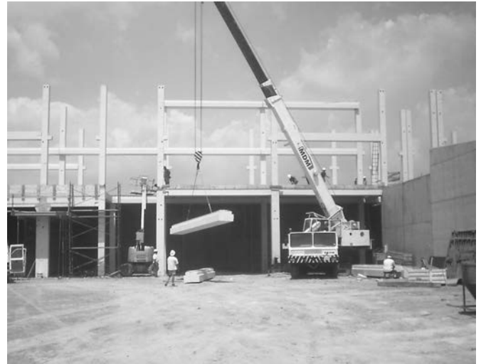
Figura 11. Montaje de la estructura con los nudos pilar-jácena resueltos con ménsulas en escalón embebidas y armadura pasante por pilar.
