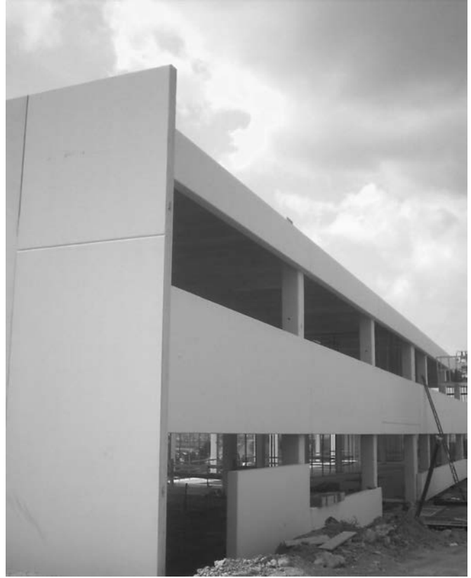
Figura 14. Fachada de entrada al C.E.I.P. con los cerramientos colgados de la estructura y testero de placas prefabricadas
