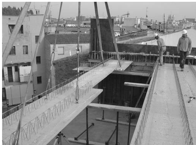
Figura 7. Edificio de Viviendas en Manresa. Estructura semiprefabricada de pilares y jácenas de hormigón armado y prelasas ATEFOR. Arquitectura: Fargas-Rovira arqs. Estructura: PBX.
