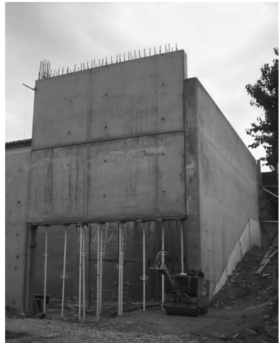
Figura 2. C.E.E. Palau (Girona) Estructura y cerramientos de hormigón in situ. Arquitectura: J.Fargas arq. Estructura: PBX
