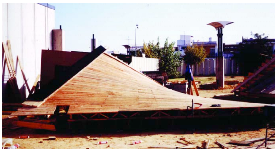
Figura 52. Confección de los encofrados de madera. Figure 52. Preparation of the wood formwork.
