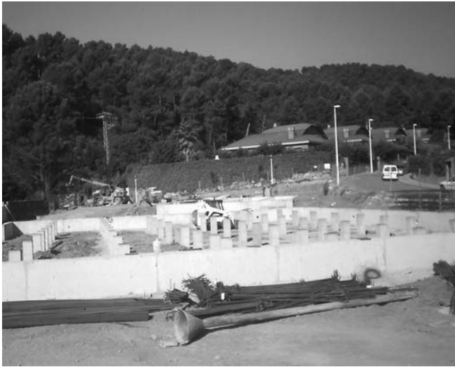
Figura 31. Pilares enanos del sanitario coronados por placas metálicas, a la espera de la llegada de los módulos integrales.
