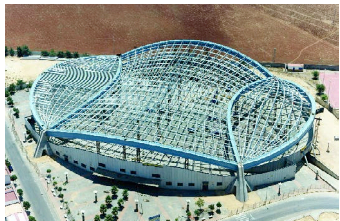
Figura 58. Vista aérea donde se ve la malla terminada, los puntales y el inicio del montaje de los elementos de la cubierta. Figure 58. Aerial shot showing the finished mesh, the struts and the first stages of the erection of the roof elements.
