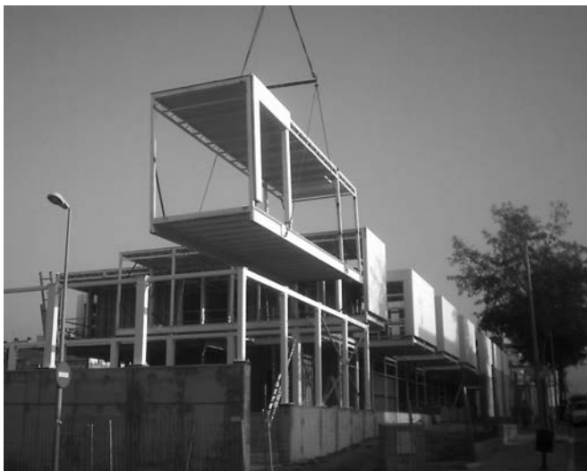
Figura 22. Gimnasio: módulos de 2,70 m.x 10,80 m. encima de pórticos de 4,50 m.de altura con perfiles tubulares. Se aprovecha la diferencia de nivel entre calles.
