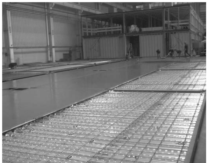
Figura 28. Factoría MODULTEC C (Asturias). Interior de la nave con el hormigonado de las placas base de chapa colaborante.
