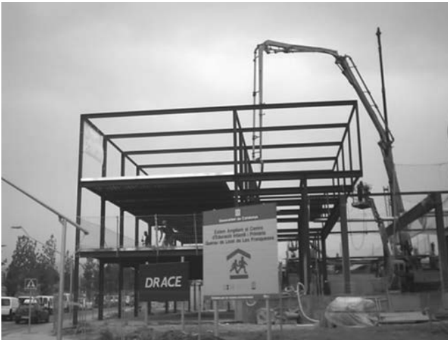
Figura 44. Esqueleto de la estructura del testero singular, en su fase inicial de montaje y hormigonado con bomba del forjado intermedio.
