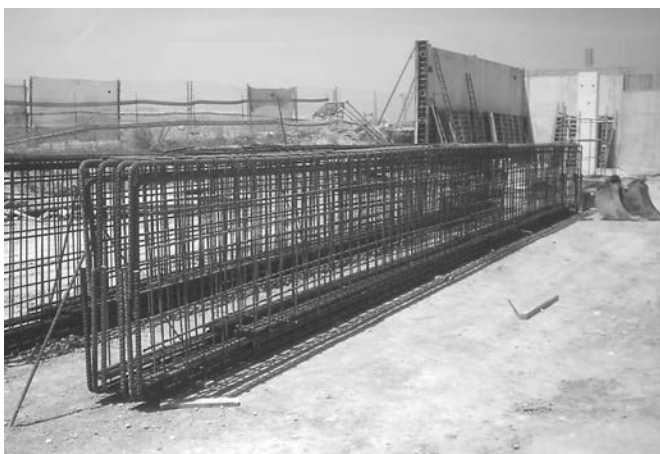
Figura 8. Jácena "in situ" de apeo de dos pilares centrales de la estructura prefabricada, para solucionar el gimnasio libre de obstáculos.
