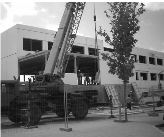
Figura 47. Montaje de los cerramientos ligeros de GRC (Microhormigón reforzado con fibras de vidrio).
