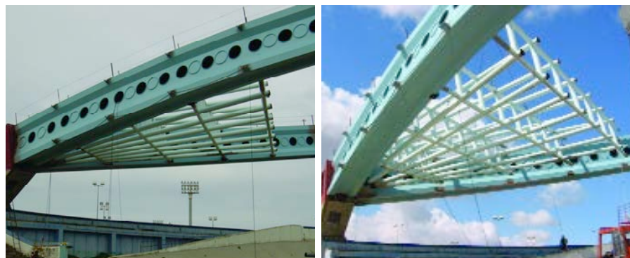
Figura 56. Aspecto de la malla durante el montaje en la zona de voladizos. Figure 56. Appearance of the mesh during erection in the jut area.
