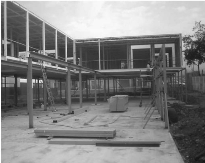
Figura 19. Montaje de los módulos encima la estructura de apeo de planta baja, para conseguir espacios diáfanos en vestíbulo y comedor.
