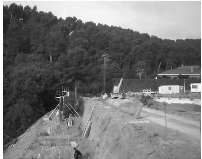
Figura 27. Muro de hormigón armado empotrado en el terreno natural de gravas, mediante elementos pantalla. Perímetro de la nueva edificación.
