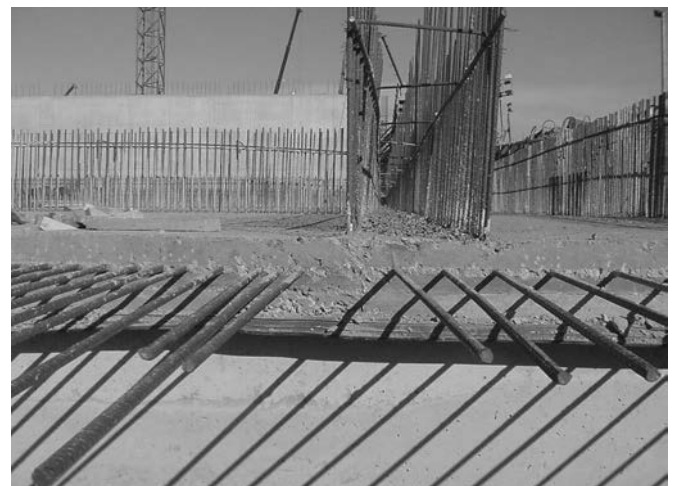
Figura 10. Vista del canto de la losa D-2-1 Mar con algunas esperas de armadura.
