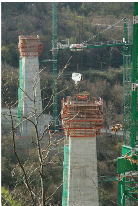
Figura 24. Ejecución de alzados de pilas 2 y 3. Figure 24. Execution of piers 2 and 3 elevations.
