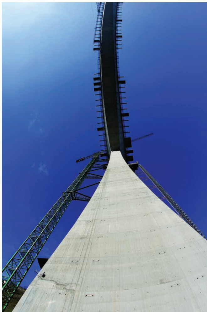
Figura 15. Vista inferior de fondo de tablero desde pila 2. Figure 15. Underneath view of the deck bottom from pier 2.
