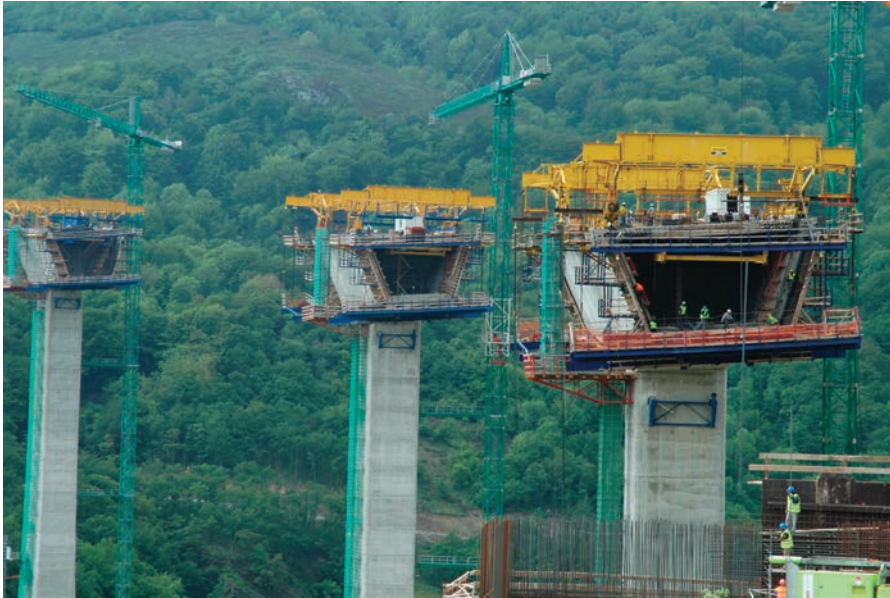
Figura 27. Ejecución de dovelas tipo mediante carros de avance. Figure 27. Building standard segments with travellers.
