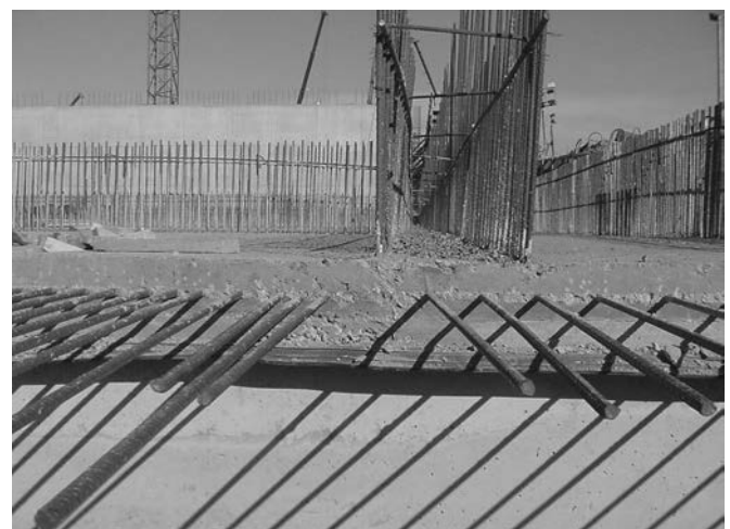
Figura 10. Vista del canto de la losa D-2-1 Mar con algunas esperas de armadura.
