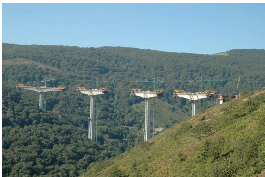
Figura 29. Vista general de las "Ts" de las cuatro pilas. Figure 29. General view of the four piers' "Ts".
