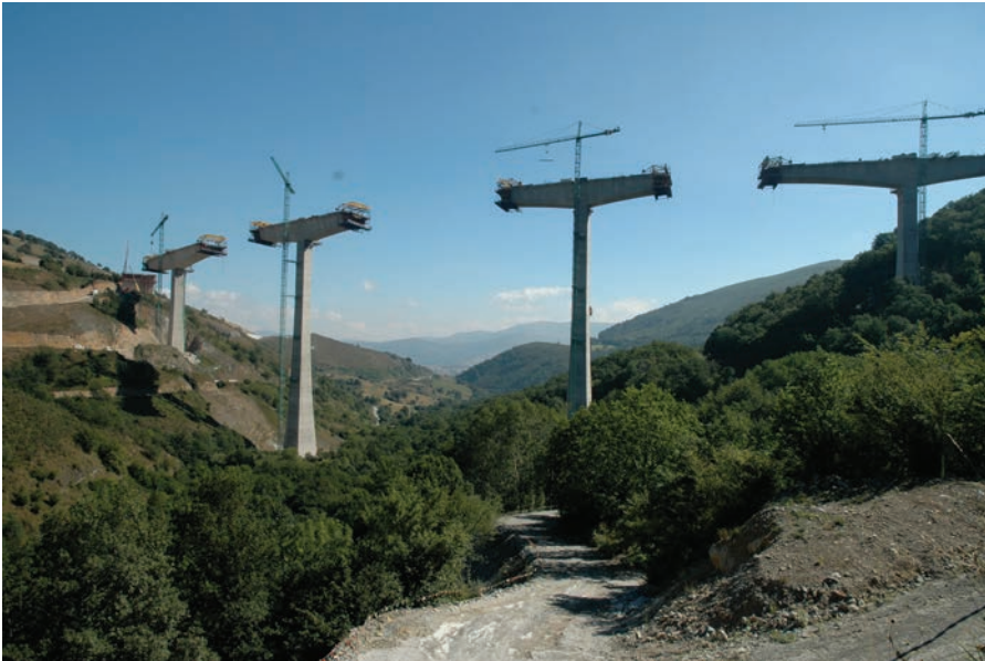
Figura 28. Avance progresivo de las "Ts" de la estructura. Figure 28. Progressive advance of the structure's "Ts".
