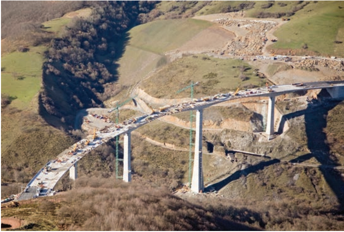
Figura 33. Vista aérea de la estructura durante la ejecución de los voladizos laterales.
