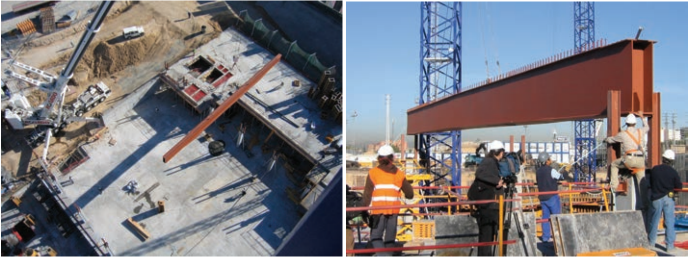
Figura 26. Montaje de las vigas metálicas para el cubrimiento del salón de convenciones. Figure 26. Erection of the steel beams to cover the convention centre.
