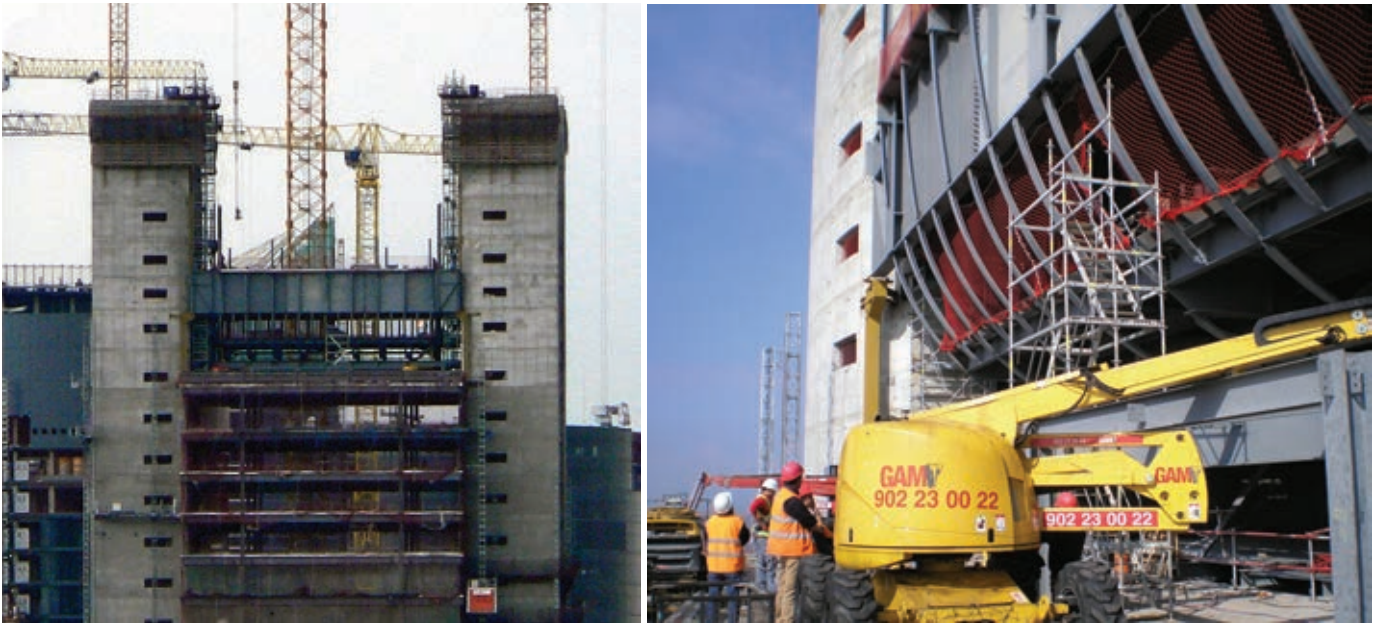
Figura 27. Vistas del arco previo a su izado. Figure 27. Arch prior to positioning.
