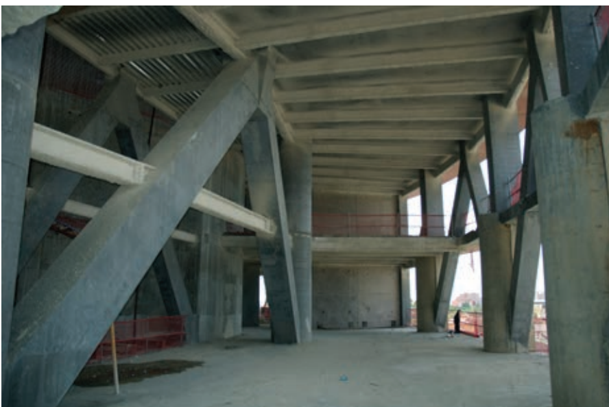
Figura 11. Piezas de desvío de soportes entre los Niveles N04 y N06. Figure 11. Support bypass parts between levels N04 and N06.
