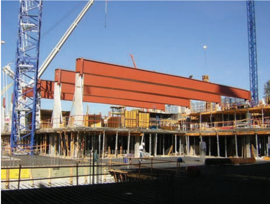
Figura 27. Estructura de forjados de hormigón armado en las plantas bajo rasante y vigas metálicas del salón de convenciones.
