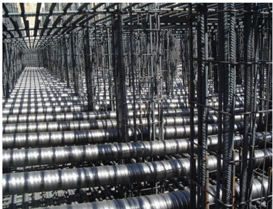
Figura 2. Tendones de postensado en losa de cimentación de Torre Espacio. Figure 2. Post-stressing tendons in the Torre Espacio foundation slab.
