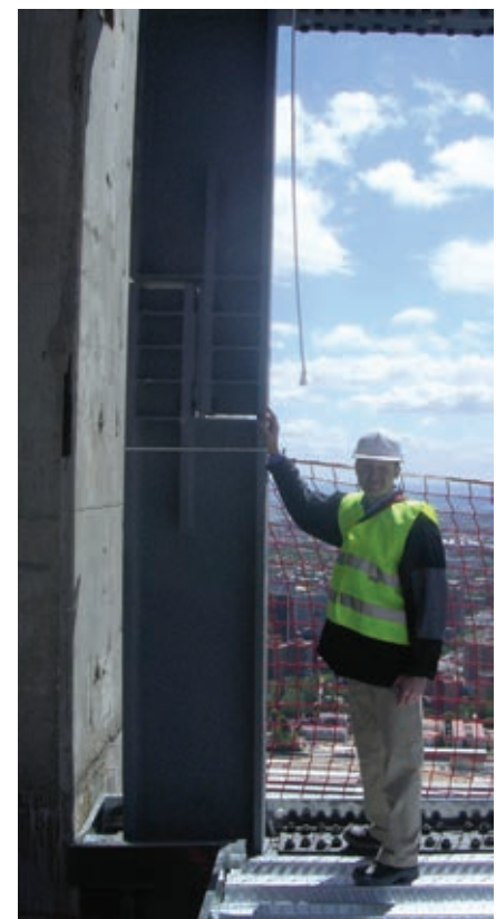
Figura 19. Columna adyacente al núcleo. Figure 19. Column adjacent to the core.
