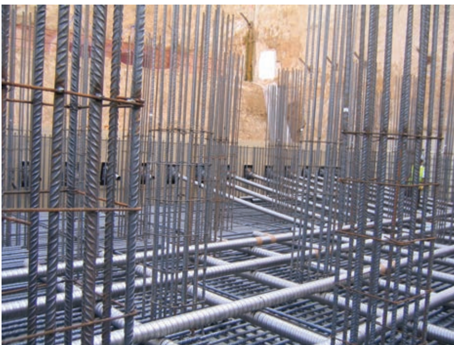
Figura 4. Detalle de la interferencia entre la armadura pasiva de flexión, los cables de pretensado y la armadura de cortante.
