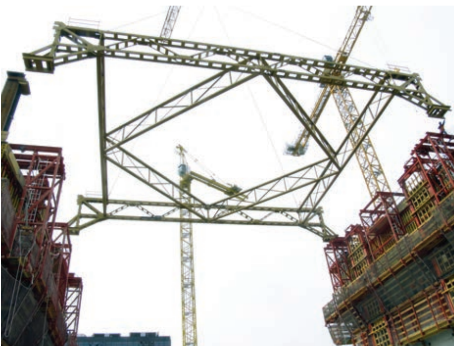
Figura 23. Escantillón para replanteo de pilares embebidos. Figure 23. Template for staking out embedded columns.
