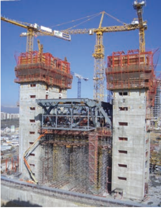
Figura 23. Cercha de transferencia del primer nivel próxima a su finalización. Figure 23. First transfer truss level nears completion.
