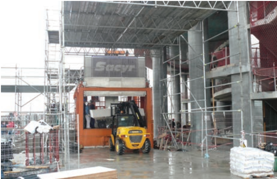
Figura 18. Muelle de carga de los montacargas. Figure 18. Loading bay of the hoists.
