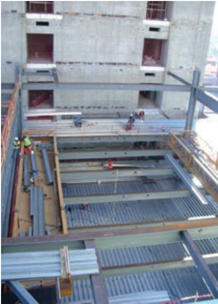
Figura 24. Batea de acopio intermedio en montaje de estructura de plantas. Figure 24. Stockpiling tray on intermediate storeys.
