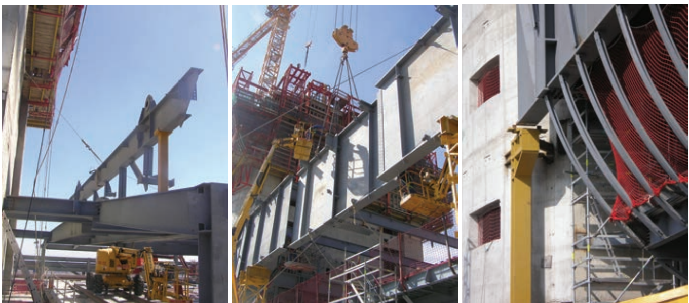
Figura 25. Fases de montaje de las jácenas y la estructura del arco. Figure 25. Girders and arch - three construction stages.
