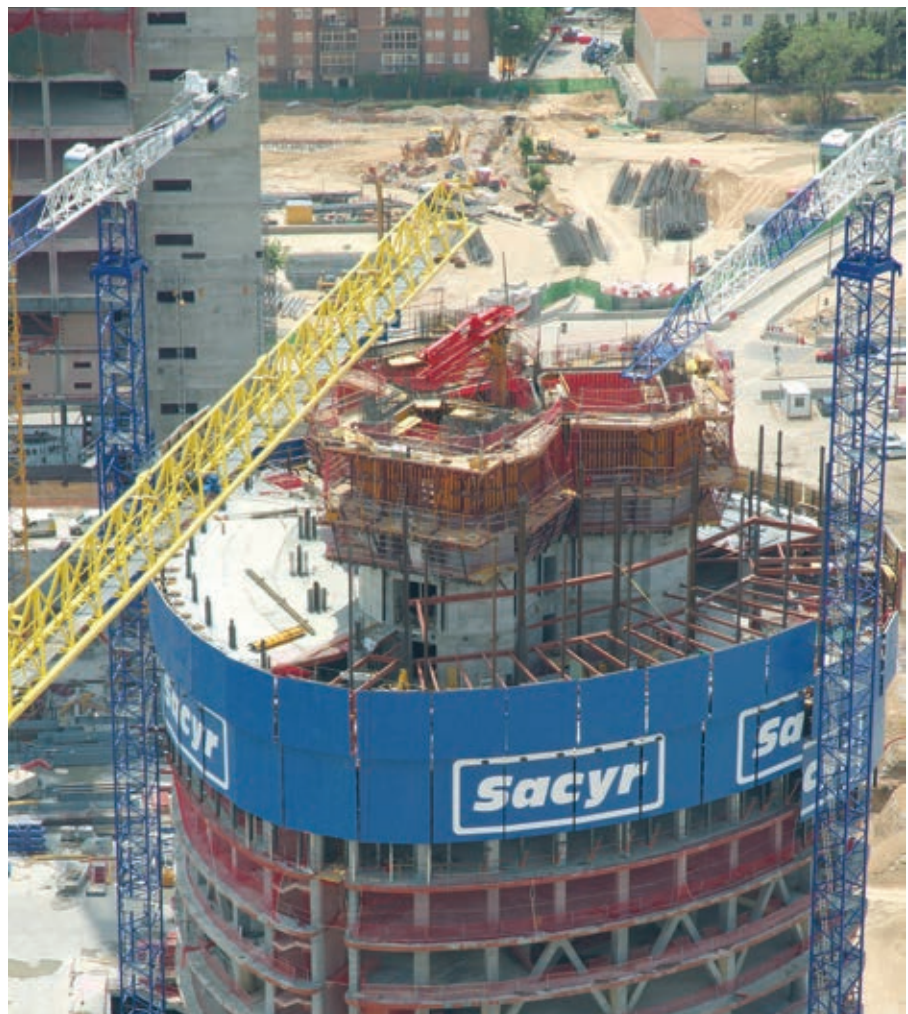
Figura 24. Vista general de la obra en una de las plantas tipo en la que se muestra la superposición de las actividades de construcción del núcleo mediante autotropa y de la estructura metálica de la planta.
