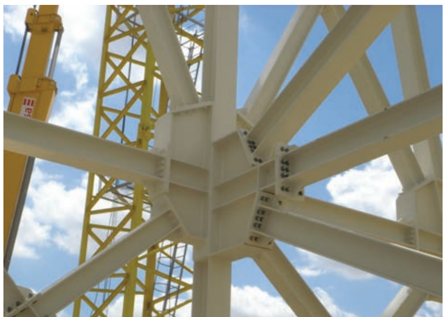
Figura 14. Nudo atornillado en la estructura de coronación. Figure 14. Bolted junction in the crown structure.
