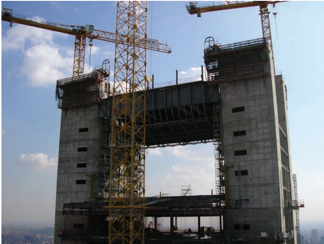
Figura 25. Elevación del entramado de vigas pared y arco de coronación a su posición final. Figure 25. Plate girder and arch level framing lifted into final position.
