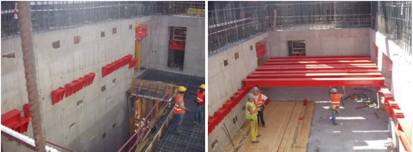
Figura 15. Estructura soporte del encofrado de losa de 1,90 m. Figure 15. Shoring for the 1.90-slab formwork.
