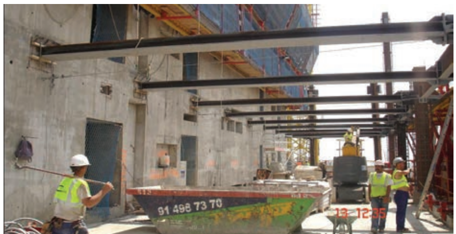
Figura 11. Vigas de soporte del forjado. Figure 11. Beams that support the floor slab.
