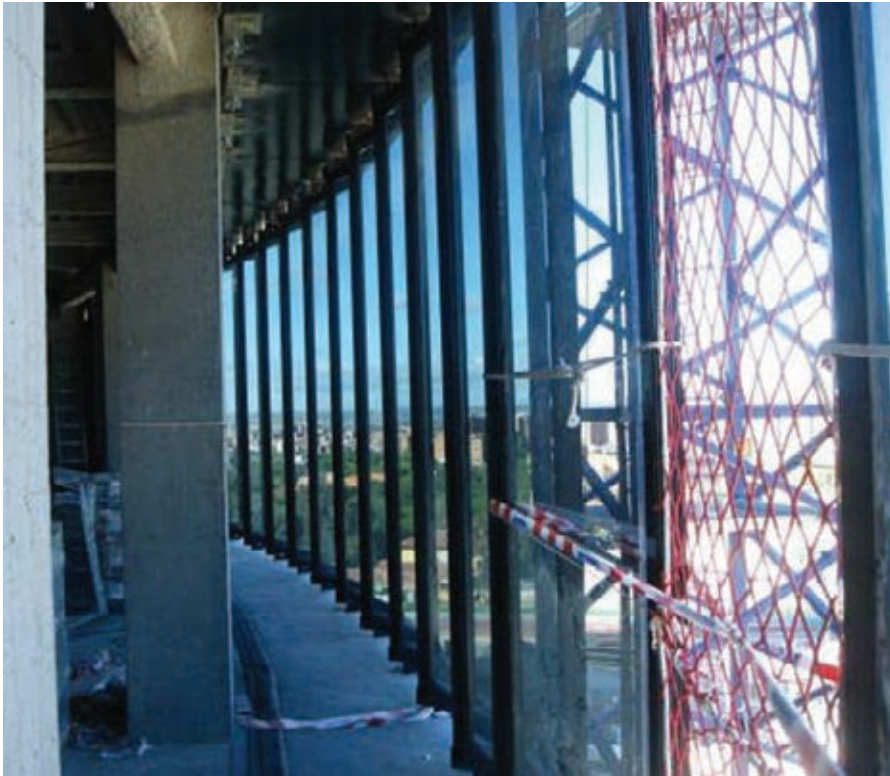
Figura 12. Espacio comprendido entre las fachadas interior y exterior. Figure 12. Gap between the inner and outer façades.
