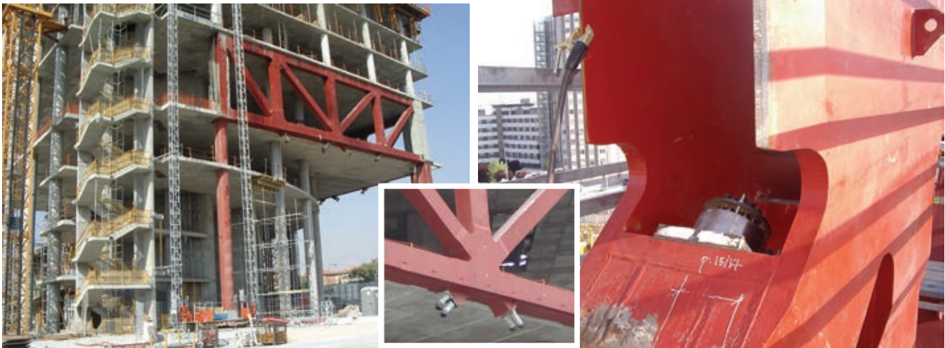
Figura 19. Vigas cargaderas en la zona de accesos al edificio (en el sentido de las agujas del reloj): vista general antes de la instalación de la fachada; detalle con los anclajes inferiores; detalle con los anclajes superiores durante el montaje.
