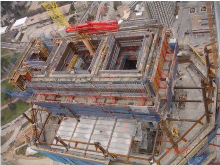
Figura 10. Vista general de núcleo y forjados de oficinas. Figure 10. General view of core and office floor slabs.
