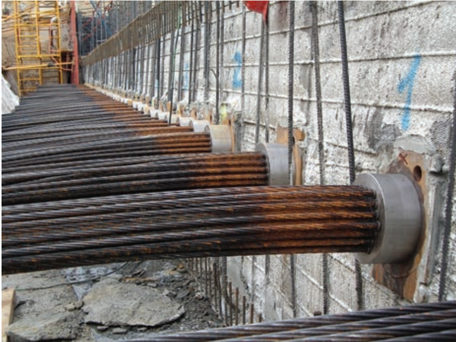
Figura 3. Anclajes activos después del tesado en losa de cimentación de Torre Espacio. Figure 3. Active anchorages after tensile stressing in the Torre Espacio foundation slab.
