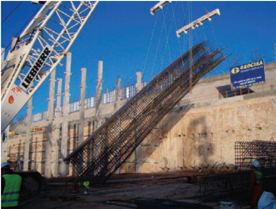
Figura 5. Izado de la ferralla de un panel de pantalla. Figure 5. Hoisting a diaphragm wall rebar panel.
