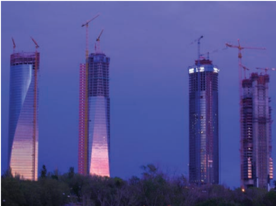
Figura 15. Avance de la ejecución de las obras de las cuatro torres. Figure 15. Progress of the work on the four towers.
