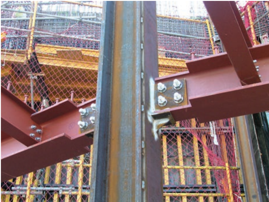
Figura 20. Unión atornillada de vigas principales con los soportes metálicos y embrochamiento de viguetas en vigas principales.
