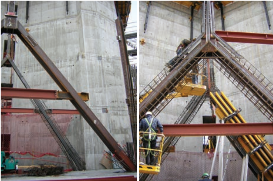
Figura 14. Montaje de la triangulación de la estructura de apeo de soportes. Figure 14. Assembly of the shoring structure of the supports.
