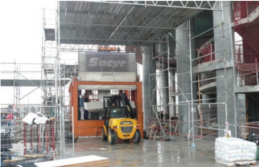
Figura 18. Muelle de carga de los montacargas. Figure 18. Loading bay of the hoists.
