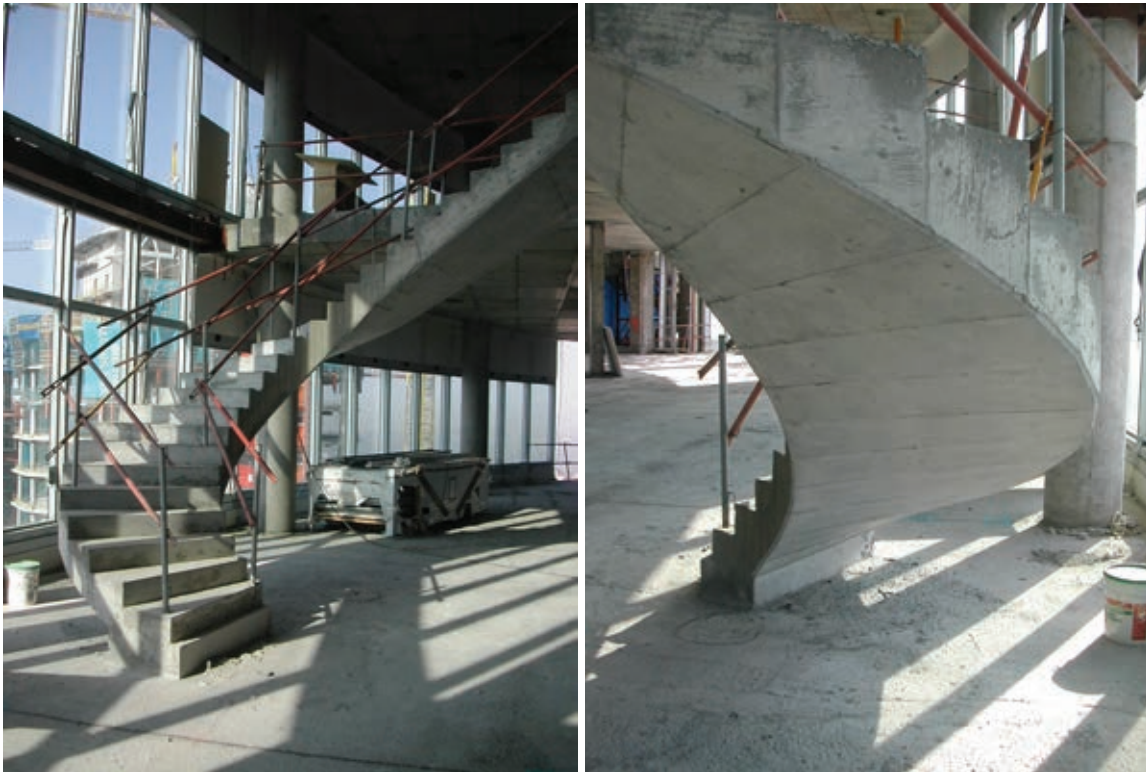
Figura 23. Escalera de caracol en la zona de Dirección del edificio (Plantas 44 y 45). Figure 23. Winding staircase in the building's Management area (44th and 45th floors).
