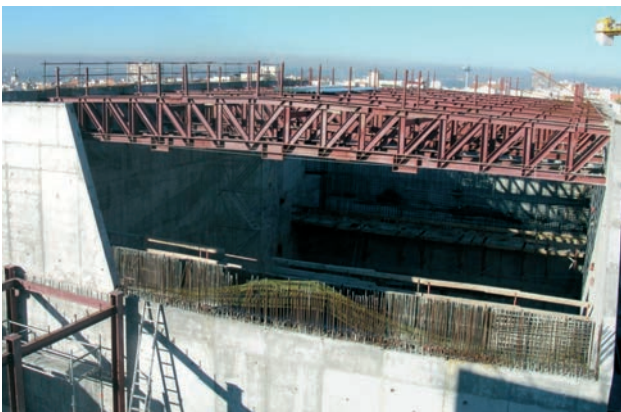
Figura 16. Celosías mixtas de la cubierta de la caja escénica. Figure 16. Composite trusses for the stage house roof.
