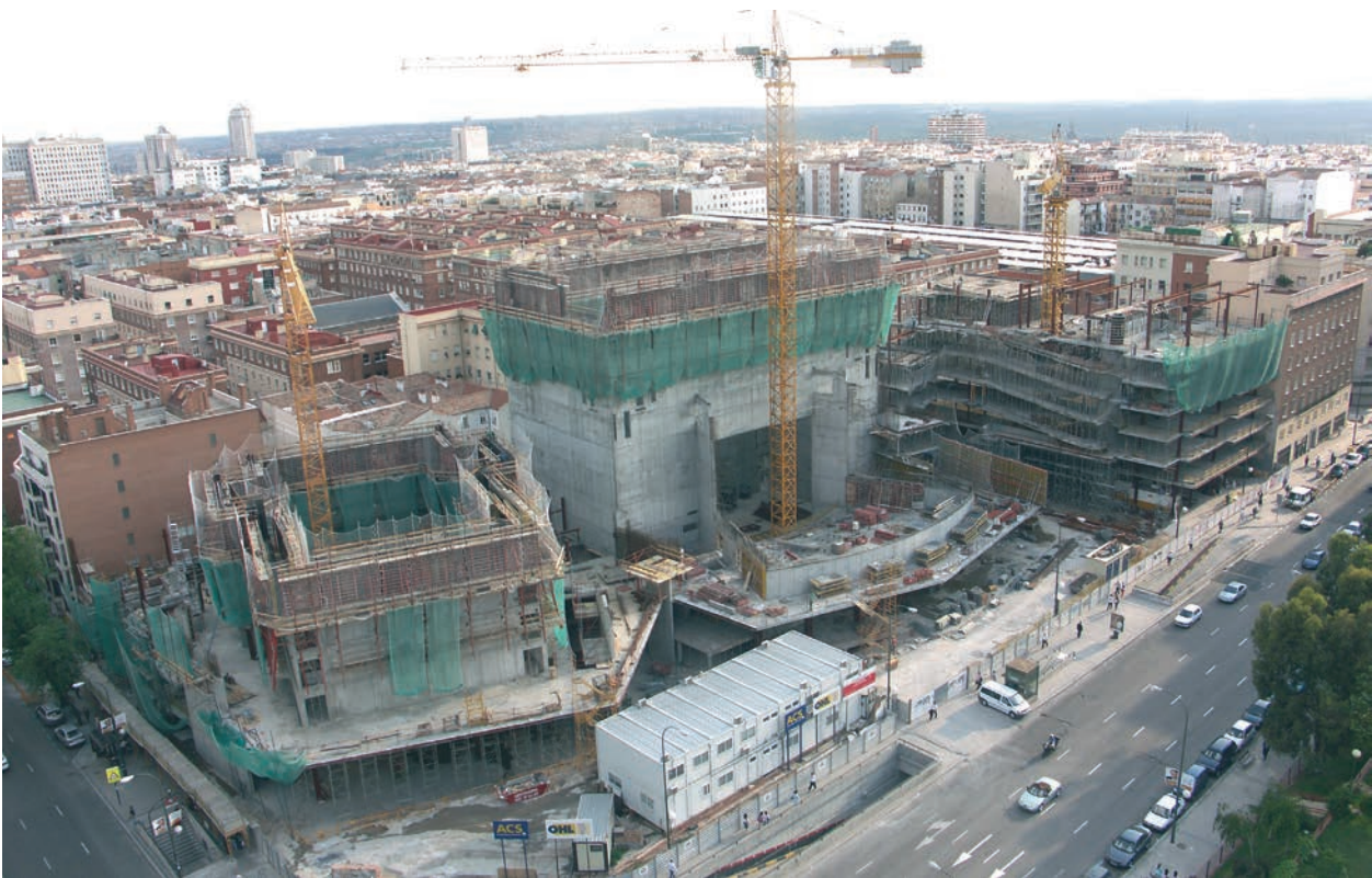
Figura 35. Estructura de los teatros en fase de construcción Figure 35. Theatres structure under construction.
