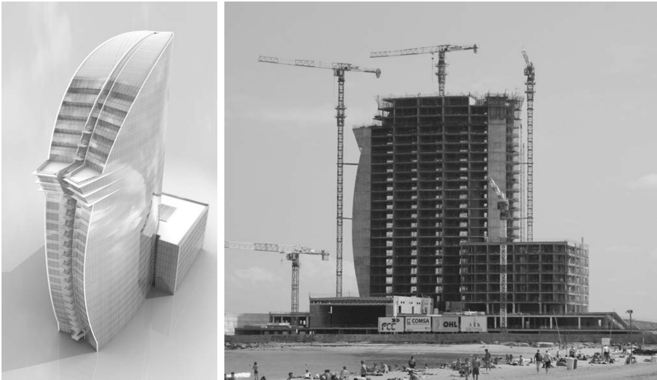
Figuras 13a y 13b. Fotomontaje, y vista del Hotel Vela en construcción.
