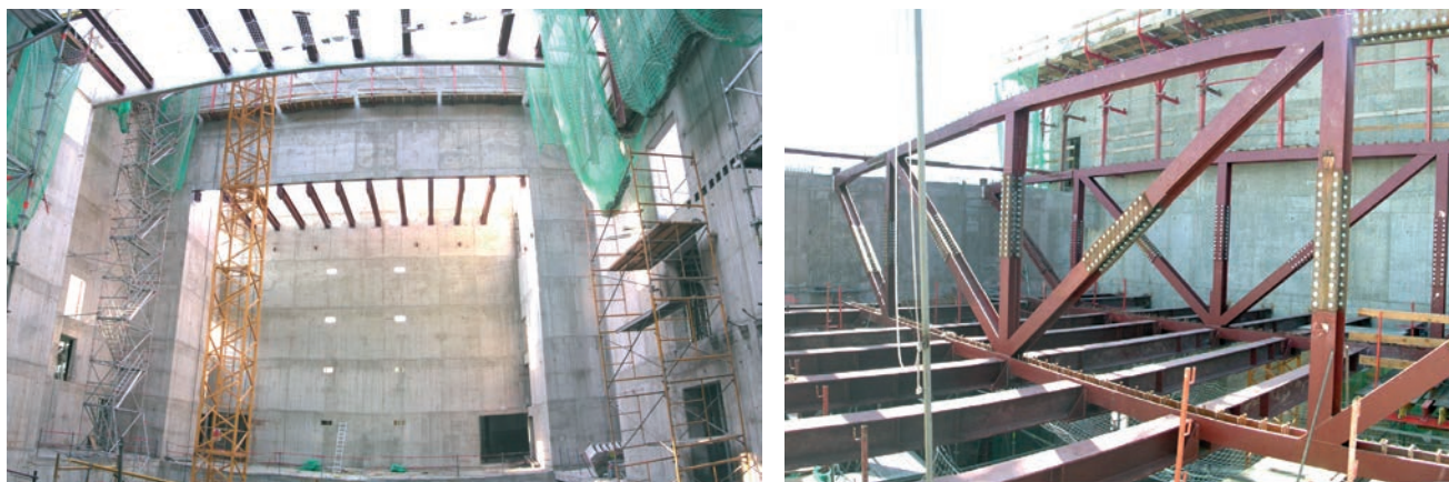
Figura 19. Interior de la caja escénica del Teatro Configurable. Estructuras mixtas.
