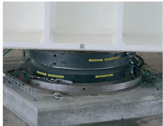
Figura 18. Rótula esférica en estructura. Figure 18. Turntable after assembly.
