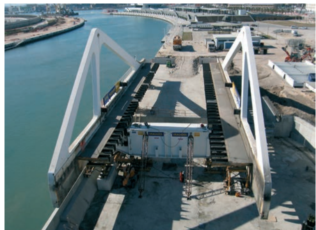
Figura 34. Semihojas en posición antes de incorporar los nuevos tramos centrales de 10 m. de anchura. Figure 34. Half-laves in position before inserting the new 10-m central sections.
