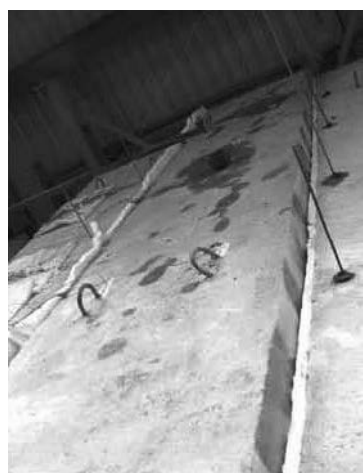
Figura 35. Estado de la cara superior de la pieza tras el ensayo piloto.
