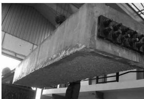
Figura 36. Estado de la cara inferior de la pieza tras el ensayo piloto. No se aprecian signos de spalling .
