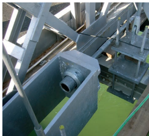
Figura 29. Nuevo cable horizontal y su terminal activo.
