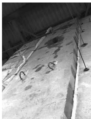
Figura 35. Estado de la cara superior de la pieza tras el ensayo piloto.
