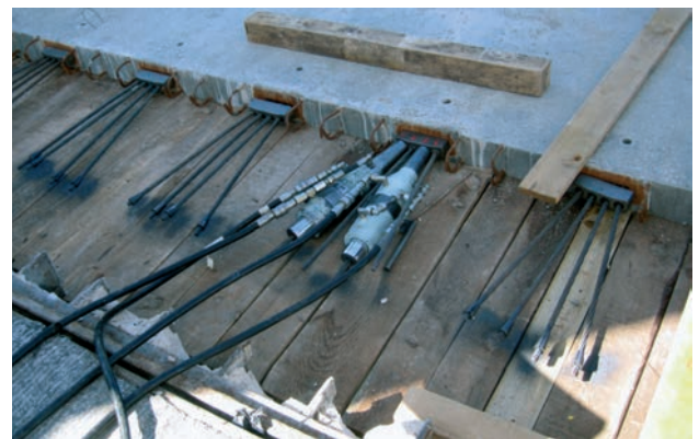
Figura 5. Tesado de la losa de calzada con juntas entre tramos prefabricados ya hormigonadas.
