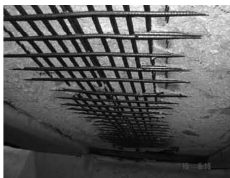
Figura 37. Spalling en la cara inferior.
