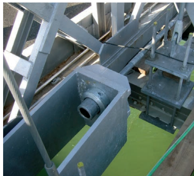
Figura 29. Nuevo cable horizontal y su terminal activo.
