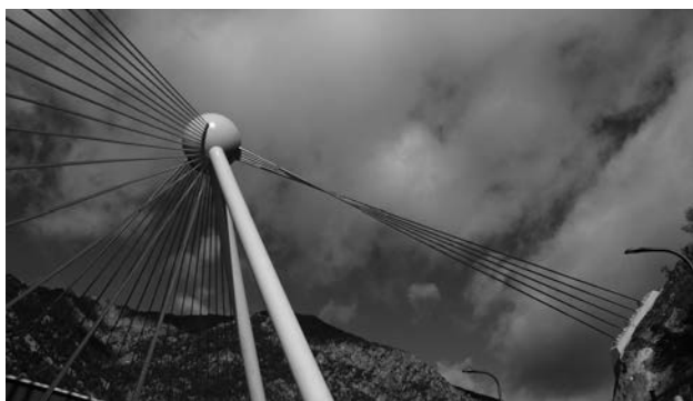
Figura 15. Tirantes anclados en la roca.
