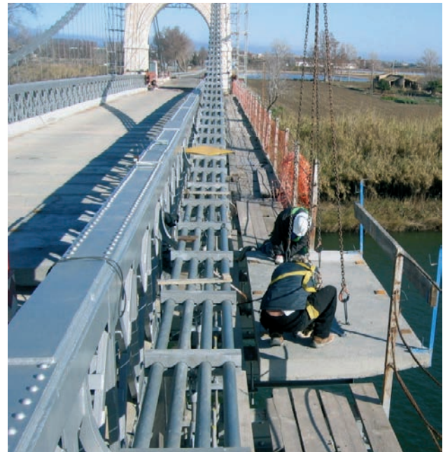
Figura 6. Trabajos de colocación de las aceras prefabricadas. Figure 6. Laying precast walkway slabs.
