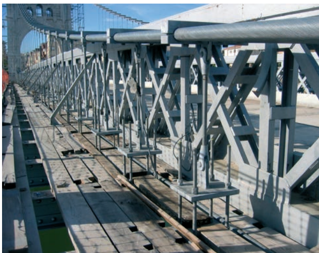
Figura 24. Nuevas péndolas y sus sistemas de unión. Figure 24. New suspenders and joining systems.
