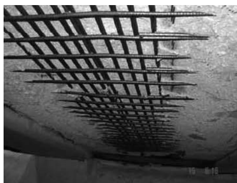
Figura 37. Spalling en la cara inferior.
