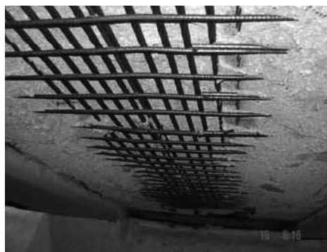
Figura 37. Spalling en la cara inferior.
