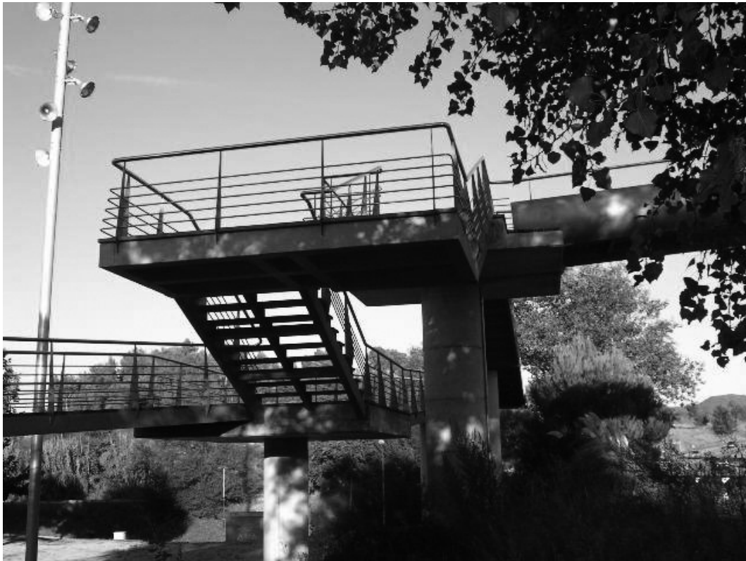
Figura 7. Pasarela de La Triola: detalle de la escalera en voladizo entre las pilas 2 y 6.
