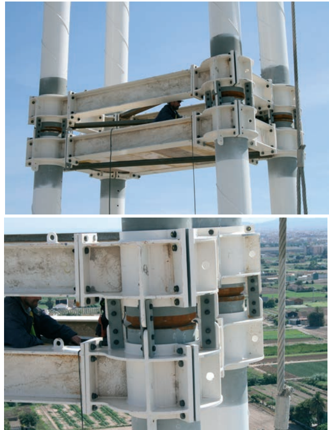
Figura 29. Unión para posicionado y soldadura de tubos de retenida. Figure 29. Connection for geometrical reference prior to welding of back stay tubes.
