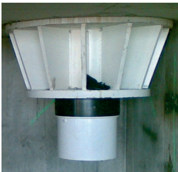
Figura 31. Anclaje retenida en cámara de contrapeso. Figure 31. Back stay anchorage in the counterweight chamber.
