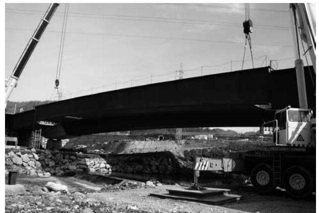
Figuras 27a y 27b. Izado y colocación del tramo central del segundo viaducto.
