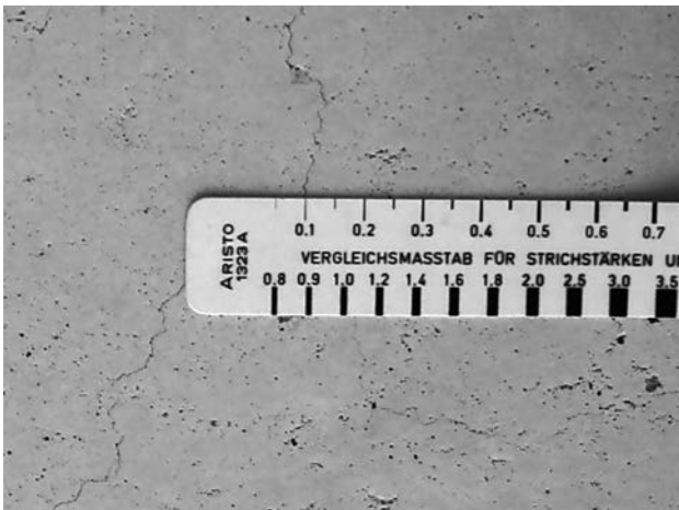
Figura 19. Apertura de fisura máxima pasado un año.
