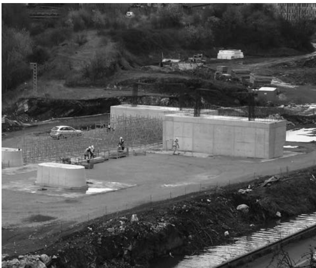
Figura 11. Vista de las pilas y la primera fase de estribos ejecutada e inicios de colocación de la cimbra del cajón de hormigón.
