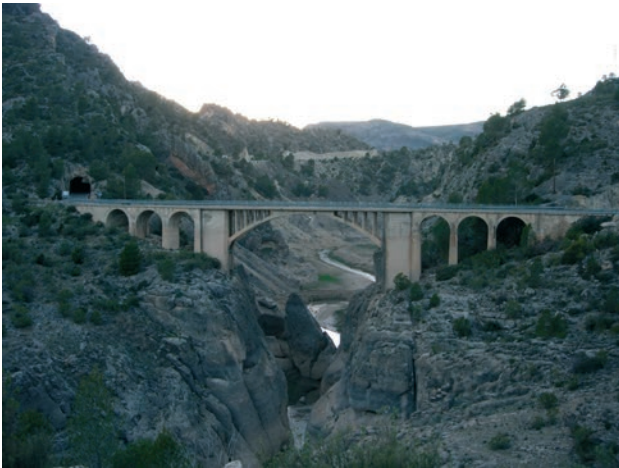
Figura 2. Carretera de acceso a Yeste, sobre el Tus Figure 2. Road to Yeste, bridge over the Tus River
