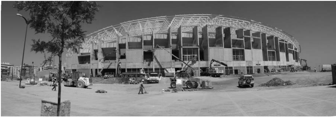
Figura 1. Estructura inicial que hubo que sustituir por daños irreparables
