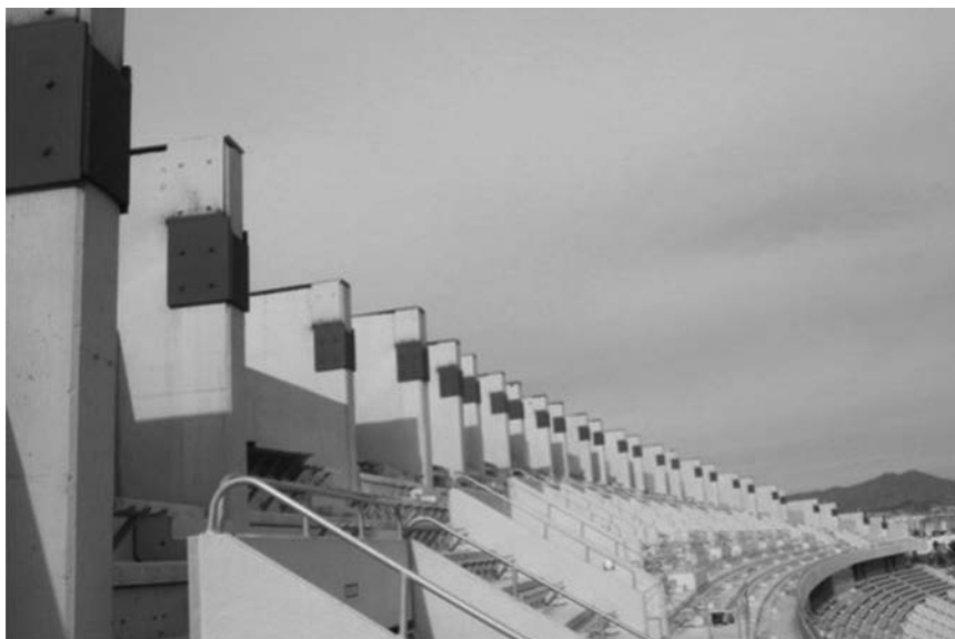
Figura 7. Anclajes preparados para el encuentro de la malla con los machones. La parte suplementada se muestra en tono oscuro hasta totalizar 1.50 m de canto
