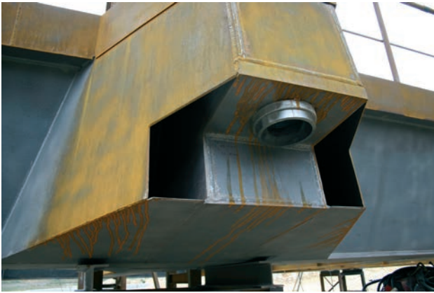
Figura 42. Anclaje péndola en tablero, en construcción Figure 42. Hanger anchorage on deck, under construction
