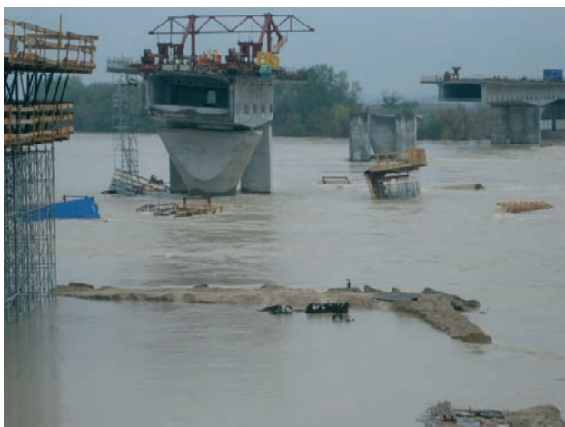
Figura 35. Riada durante construcción
