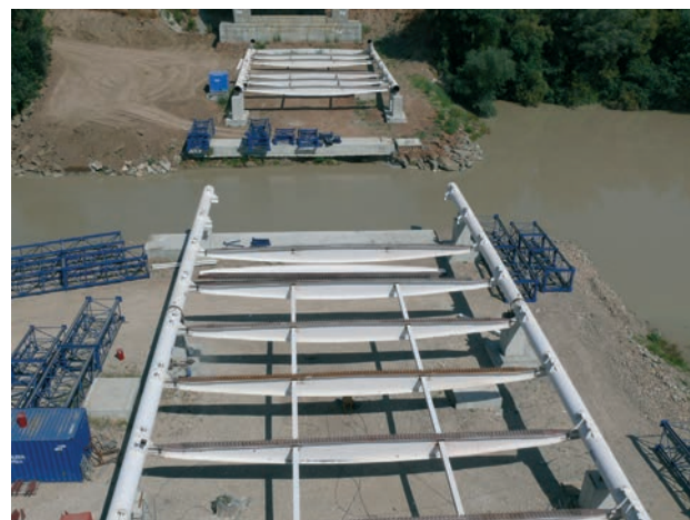
Figura 39. Vista de las penínsulas artificiales y de las labores de ensamble de la estructura metálica del tablero Figure 39. Artificial embankments and steel deck assembly operations
