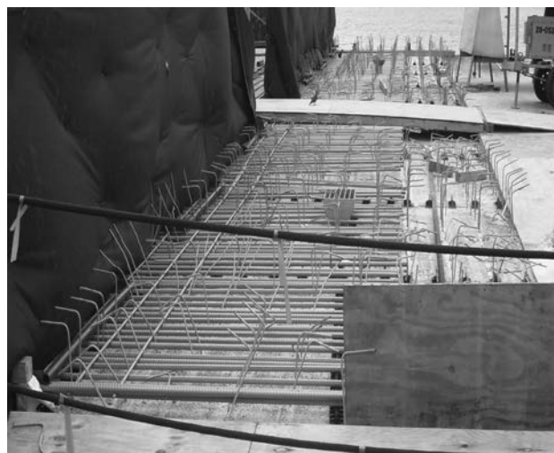
Figura 1. Barras corrugadas recubiertas de resina epoxi en el puente de los Dos Hermanos, San Juan de Puerto Rico
