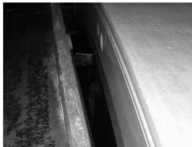
Figura 18. Acabado superficial de la cara lateral de la dovela de la dosificación 1
