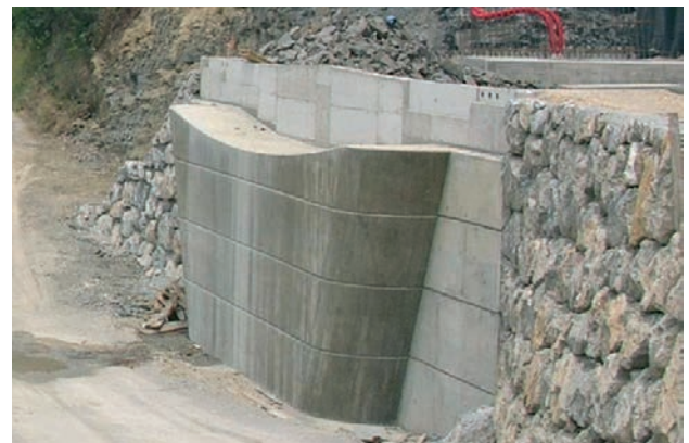
Figura 26. Estribo 2 del lado del puente arco antes del túnel Figure 26. Arch bridge abutment 2 before the tunnel
