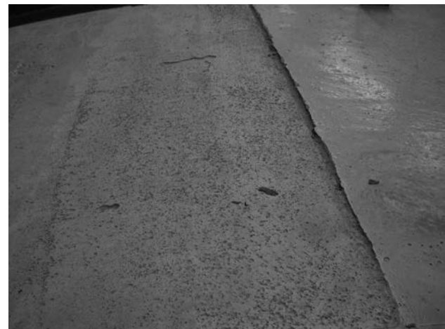
Figura 15. Discontinuidad en la curvatura, por la zona sin contraencofrado
