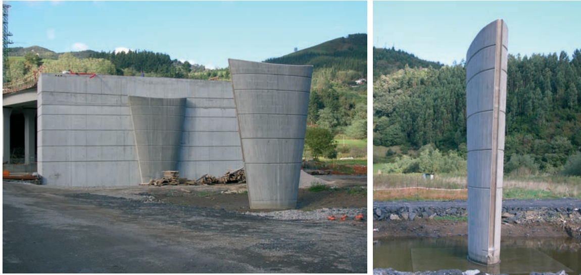
Figuras 24a y 24b. Pilas de los vanos de acceso (estribo 1 al fondo) Figures 24a and 24b. Access viaduct piers (abutment 1 on the background)
