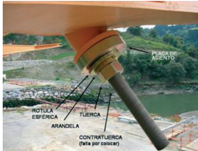
Figura 23. Anclaje inferior de las péndolas a las costillas transversales del tablero Figure 23. Lower (hanger-deck rib) anchorage
