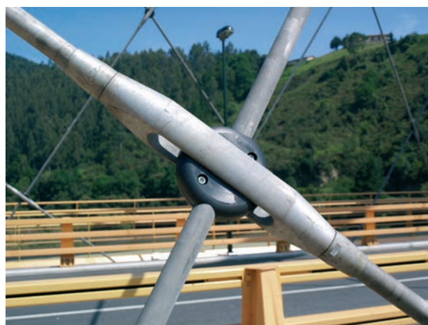
Figura 21b. Detalle de dispositivo de cruce de péndolas Figure 21b. Hanger crossing device close-up
