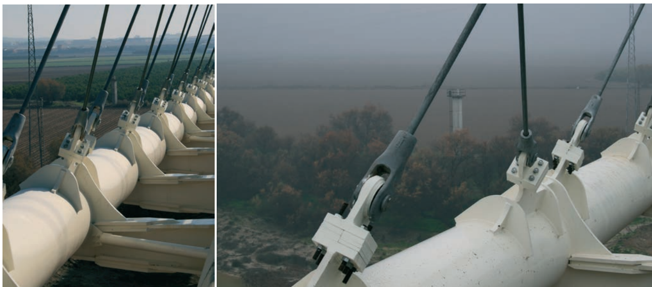
Figuras 33a y 33b. Detalles de anclajes de péndolas inferiores y arranques de vigas transversales dispuestas cada 5 m en el tablero Figures 33a and 33b. Details of hanger anchorage and transverse girders ends at 5 m intervals along the bridge
