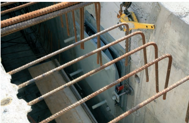
Figura 26. Apoyo POT instrumentado en estribo E1
