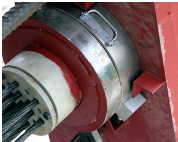
Figura 24. Célula de carga en anclaje pasivo de un tirante
