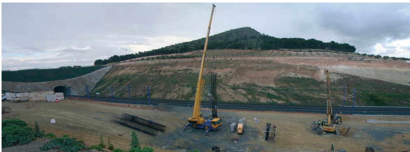
Figura 7. Ejecución de pilotes de cimentación de pilas del vano central en obra
