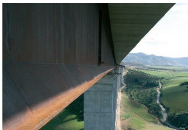
Figura 5. Vista de la viga del lado oeste al caer el sol al inicio del atardecer, con la parte inferior de la viga expuesta al sol y el resto de la viga todavía en sombra (fotografía de enero-09)
