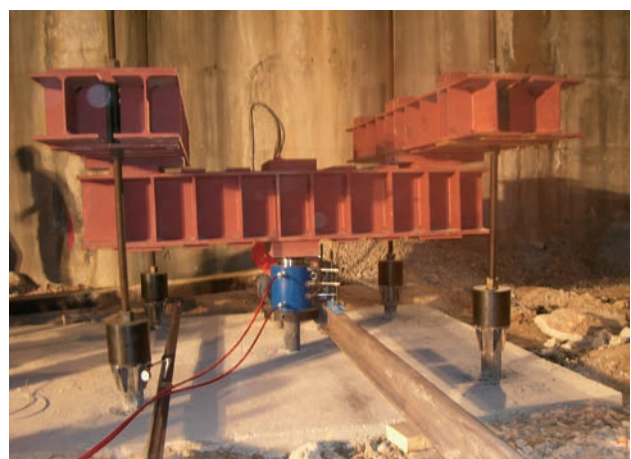
Figura 36. Prueba de carga de micropilote
