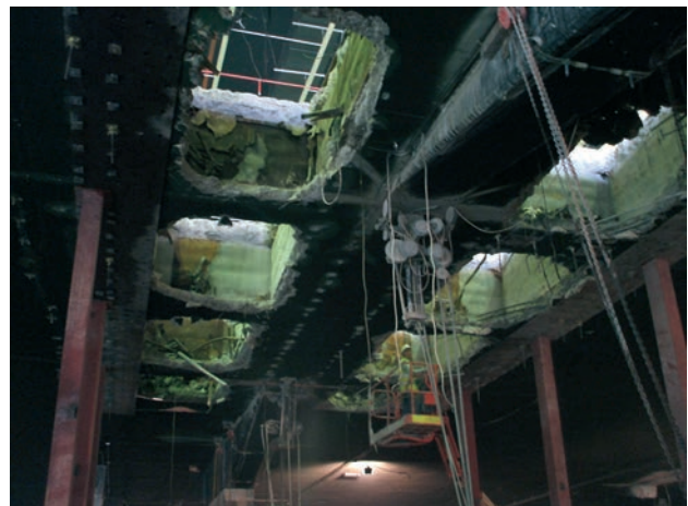
Figura 5. Huecos en la losa vista inferior
