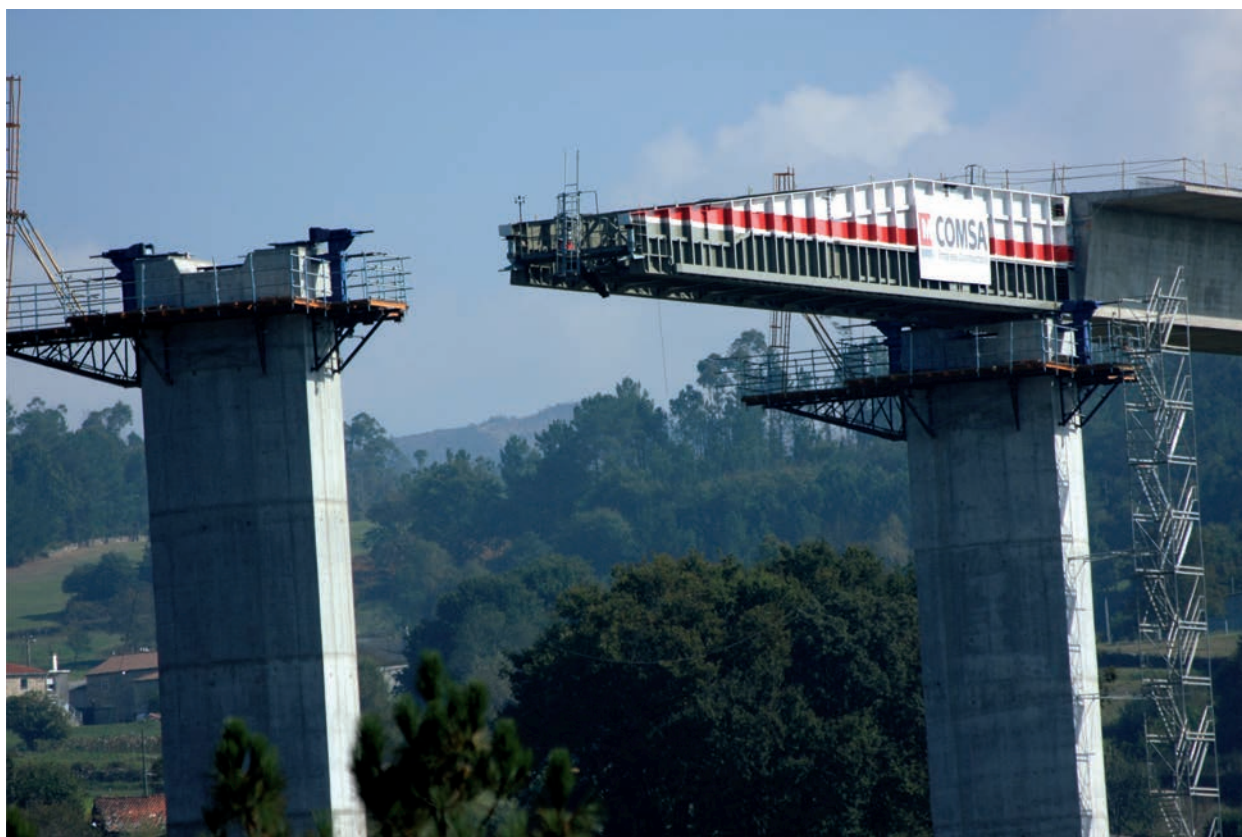
Figura 23. Empuje del viaducto sobre Río Deza
