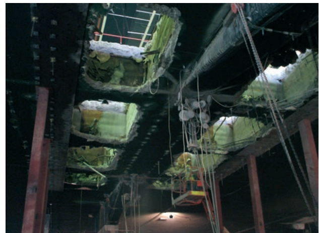
Figura 5. Huecos en la losa vista inferior
