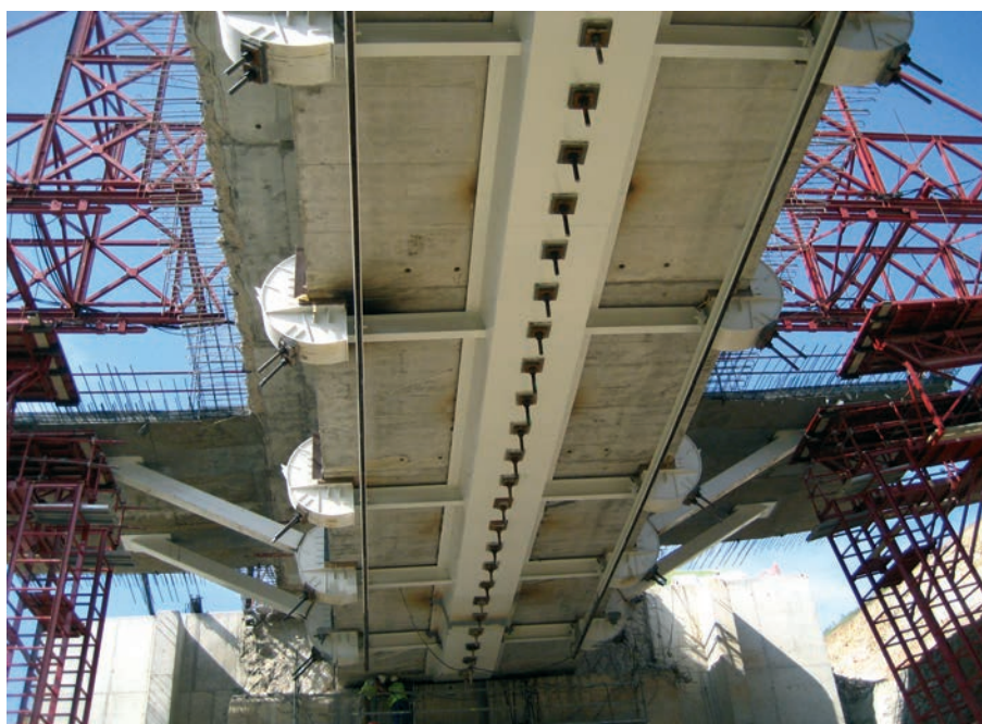
Figura 16. Refuerzo de tablero: núcleo mixto, travesaños, nudos, jabalcones y nuevo forjado de ampliación
