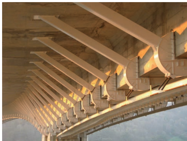
Figura 19. Jabalcones, nudos metálicos y forjados de ampliación Figure 19. Inclined struts, steel connections and upper widened slab
