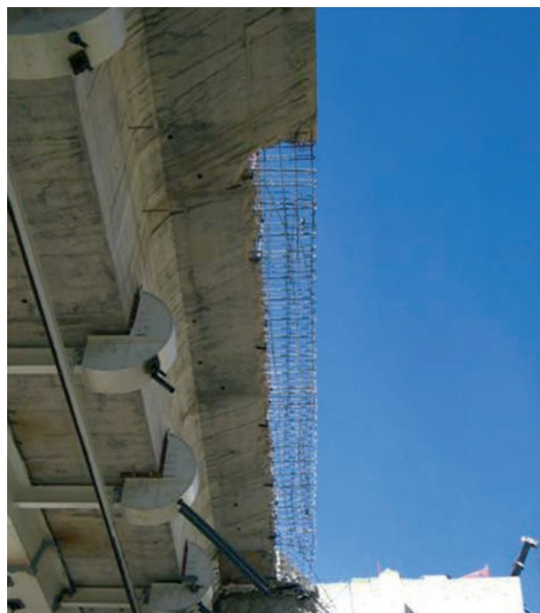
Figura 37. Demolición del último metro de voladizo original Figure 37. Demolishing of the edge of the existing transverse cantilever
