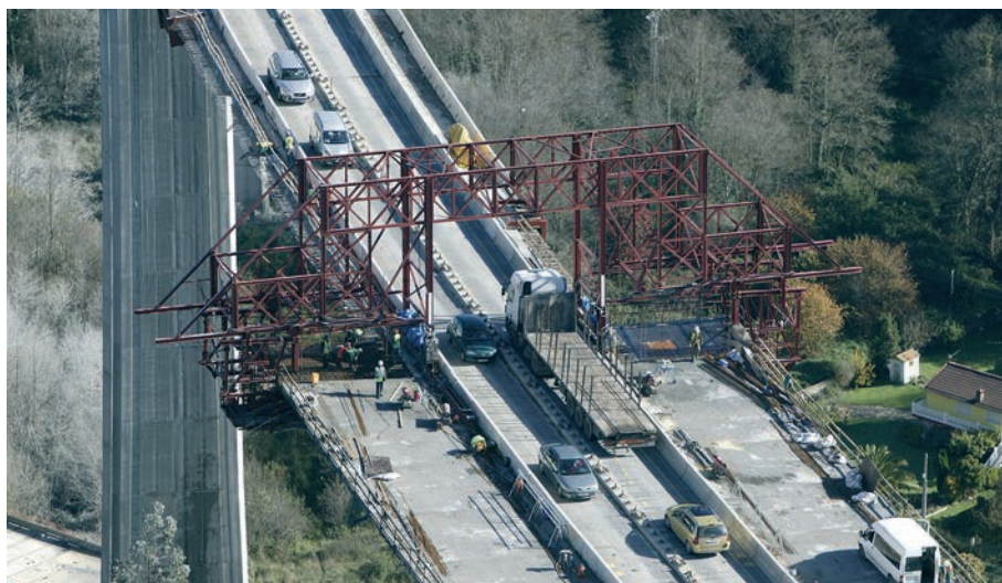
Figura 4. Tráfico por el puente existente durante el proceso de ampliación Figure 4. Temporary diversion of the traffic while widening the deck
