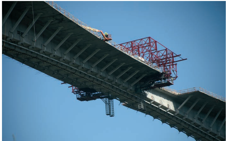
Figura 39. Ejecución del último tramo de ampliación Figure 39. Construction of the last section of the widened transverse cantilever
