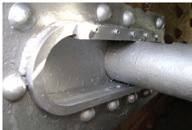
Figura 18. Nuevos bulones con guías y pista de desgaste Figure 18. New pins in slotted holes
