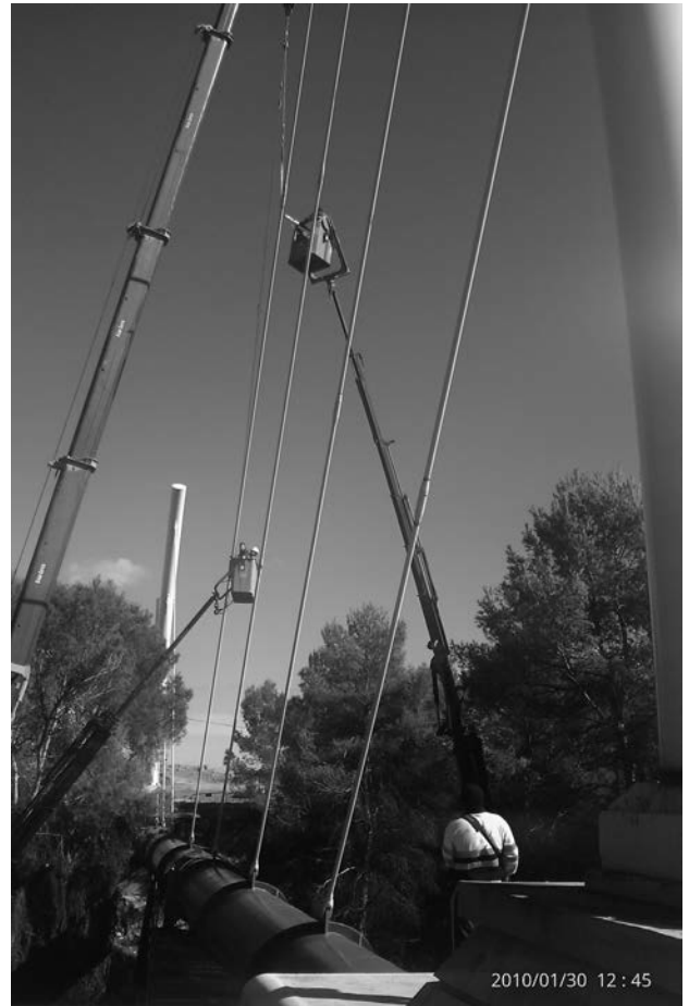
Figura 10. Roscado de las barras
