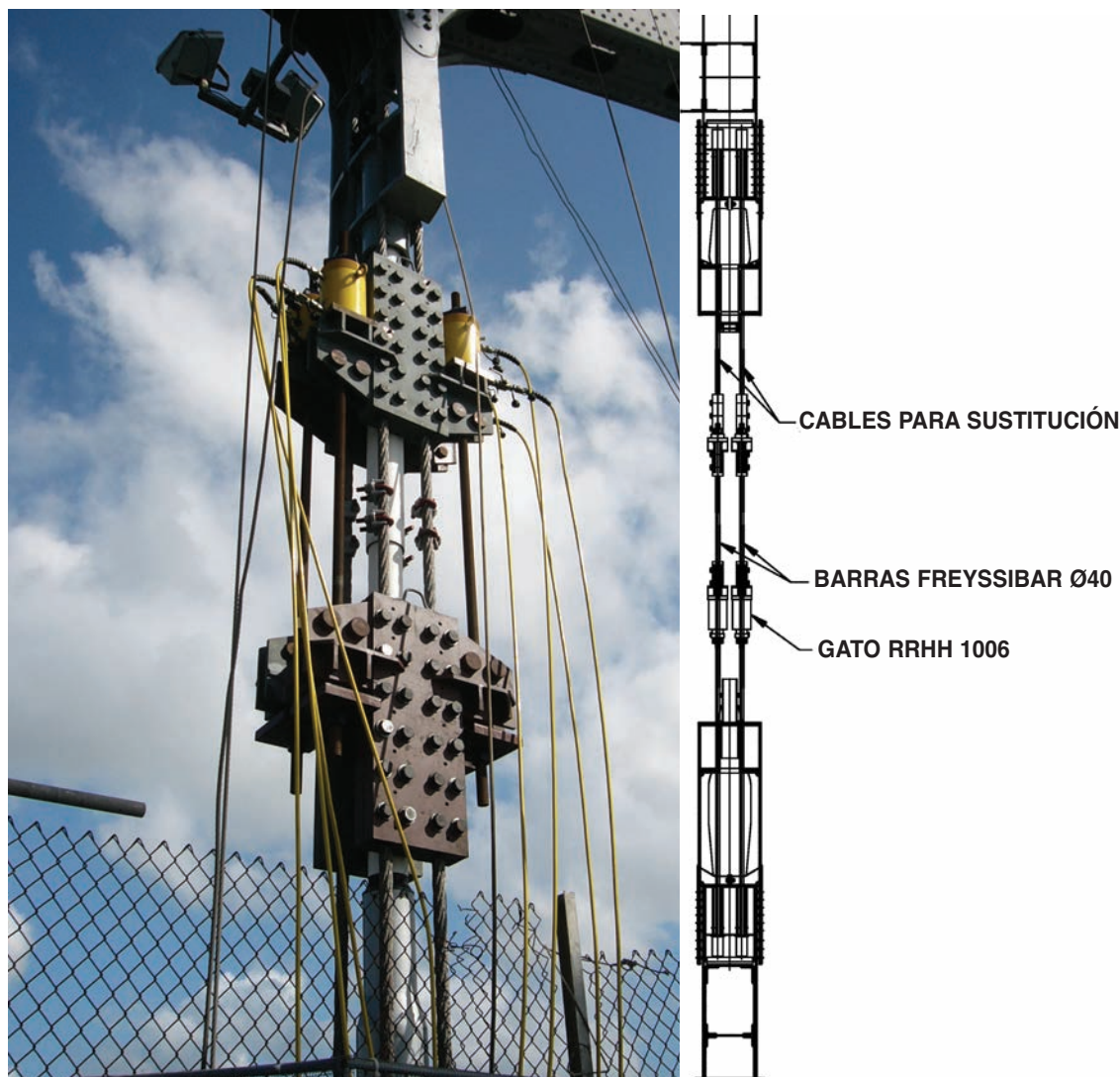
Figura 38. Mordaza durante el proceso de sustitución de péndolas Figure 38. Clamp during replacement of hangers
