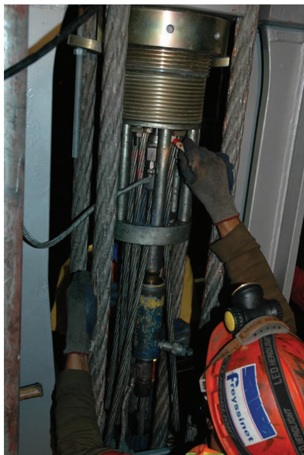
Figura 37. Tesado de las nuevas péndolas cordón a cordón Figure 37. Strand by strand stressing of the new hanger
