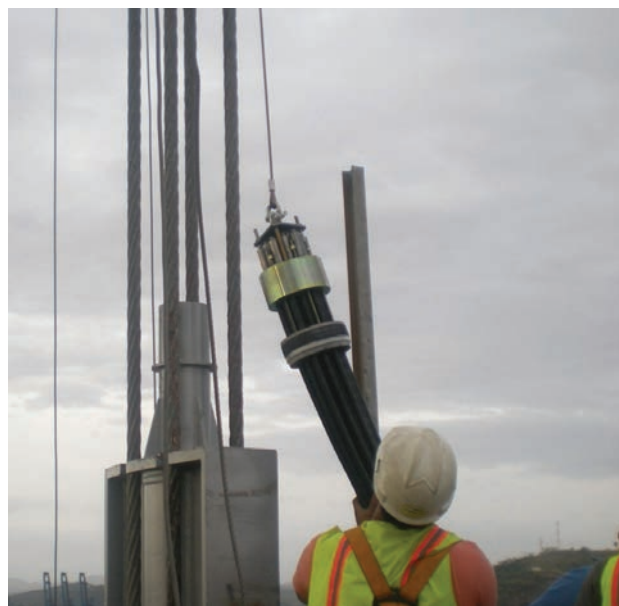
Figura 35. Izado del nuevo tirante H-1000 Figure 35. Raising the new stay cable H-1000
