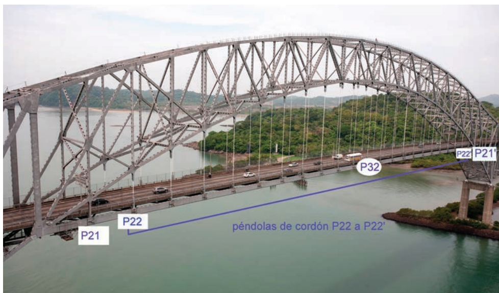
Figura 48. Vista del puente con la numeración de las péndolas extremas y medias Figure 48. View of the bridge with the number of the central and end hangers
