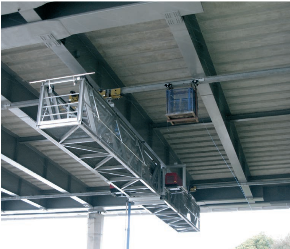
Figura 35. Carro de mantenimiento Figure 35. Maintenance gantry
