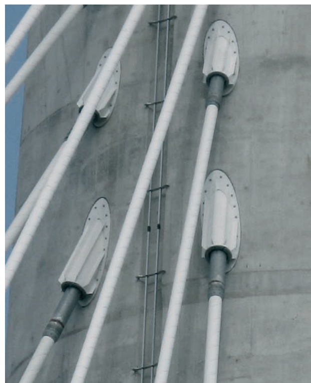
Figura 12. Tubos de tirantes en el exterior de la torre Figure 12. Cable tubes outside the pylon
