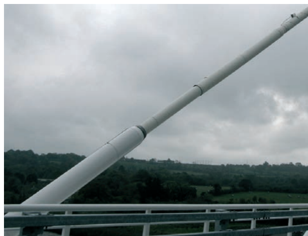
Figura 30. Tubo antivandálico y acelerómetro colocado en un tirante Figure 30. Anti-vandalism tube and accelerometer installed on a cable
