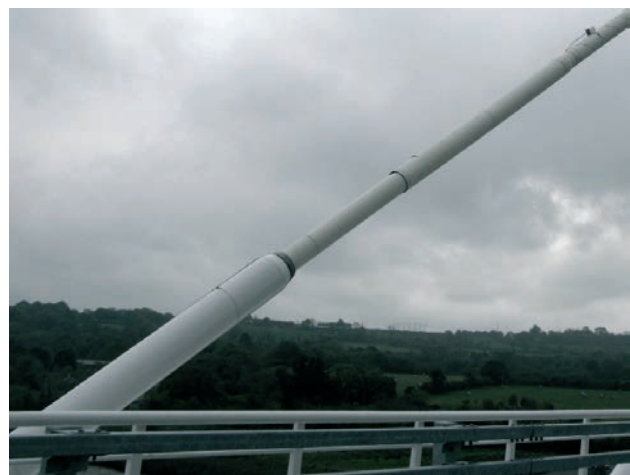
Figura 30. Tubo antivandálico y acelerómetro colocado en un tirante Figure 30. Anti-vandalism tube and accelerometer installed on a cable
