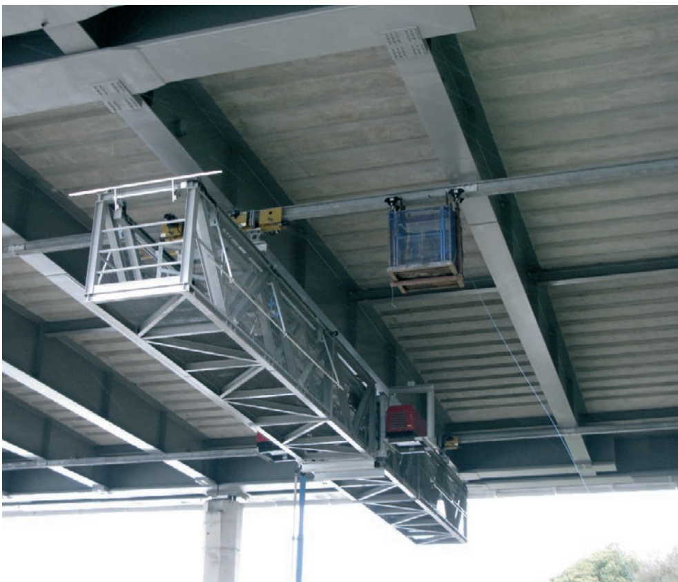
Figura 35. Carro de mantenimiento Figure 35. Maintenance gantry
