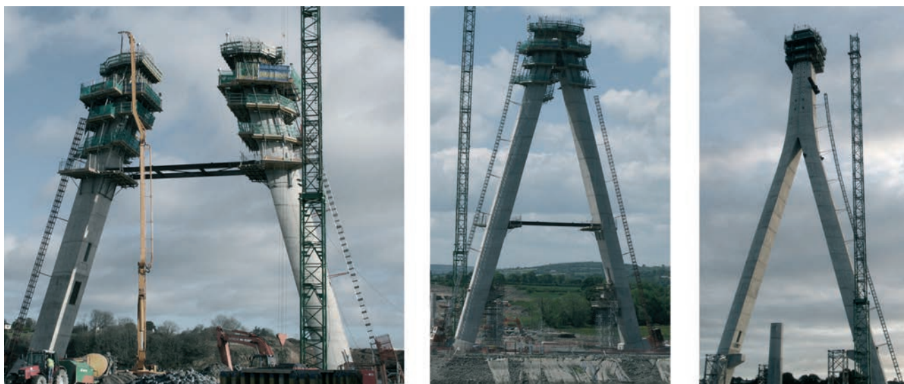
Figura 13. Distintas fases de construcción de la torre Figure 13. Different stages in the construction of the pylon
