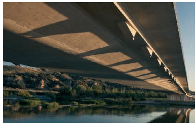
Figura 10. Vista inferior del tablero terminado. Al fondo, la pila P1 y el viaducto de acceso Figure 10. Finished bridge soffit with pier P-1 and the approach viaduct in the background
