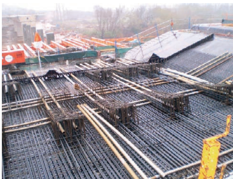
Figura 7. Colocación de vainas de pretensado longitudinal en el último tercio del tablero
