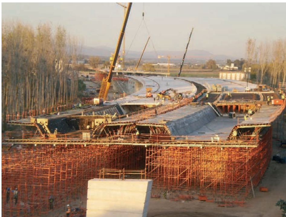
Figura 37. Frente de avance de los tableros gemelos del viaducto. Construcción por vanos sucesivos Figure 37. Construction front for the twin decks on the viaduct: span-by-span construction
