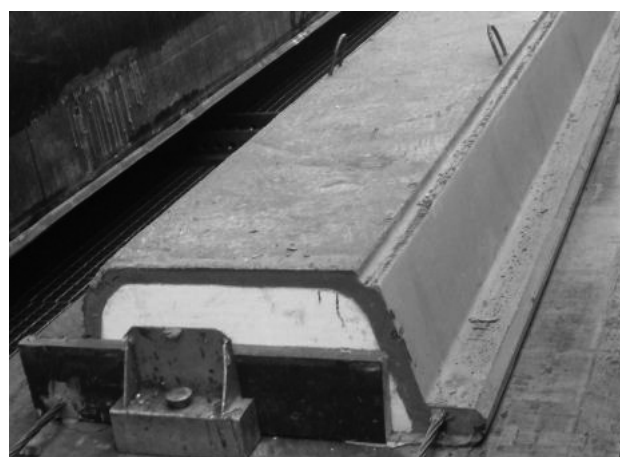
Figura 14. Sección del elemento pretensado, en la que se aprecia el poco recubrimiento del cordón en su parte superior
