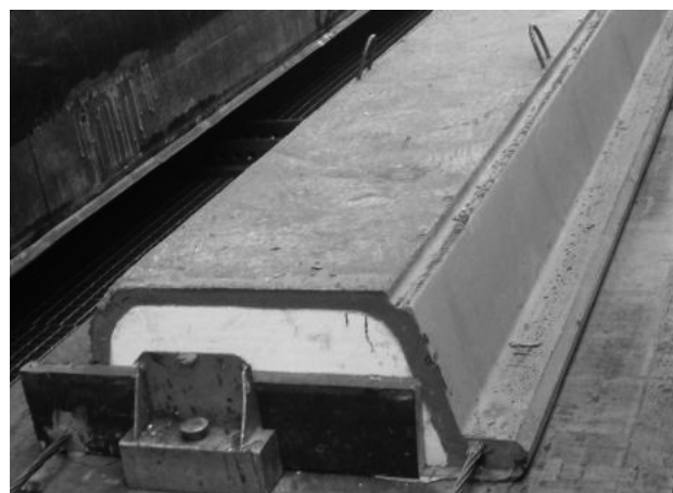
Figura 14. Sección del elemento pretensado, en la que se aprecia el poco recubrimiento del cordón en su parte superior
