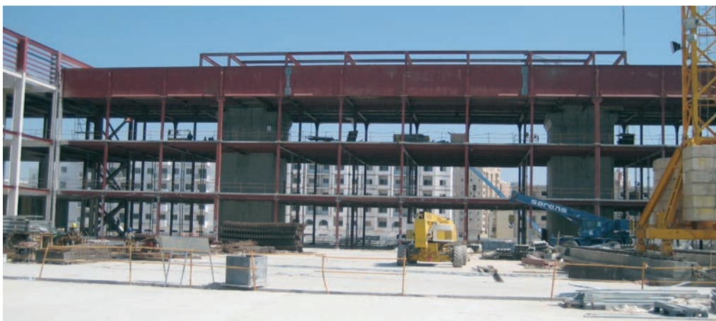
Figura 8. Vista del edificio de entrada apeado con las vigas de cuelgue del nivel 3 ejecutadas
