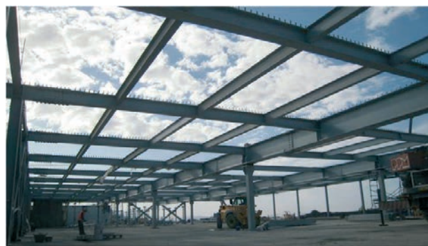
Figura 4. Vista de la estructura metálica de la cubierta del restaurante, apoyada en 6 pilares centrales
