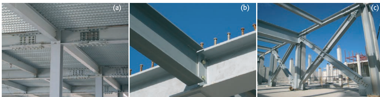
Figura 10. Detalle de uniones atornilladas en vigas principales (a), articulación de una correa en su extremo (b) y uniones atornilladas de arriostramientos sísmicos (c)
