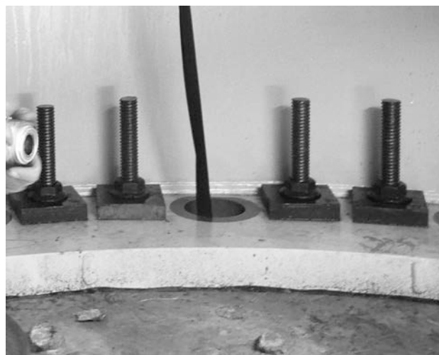
Figura 17. Torre de Hamina. Brida de conexión
