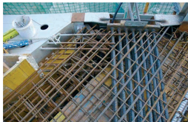
Figura 26. Detalle del encuentro entre viga descolgada postesada, viga de patio y cajetín de recepción de un bambú Figure 26. Intersection detail among post-tensioned downstand beam, patio beam and steel box for bamboo connection
