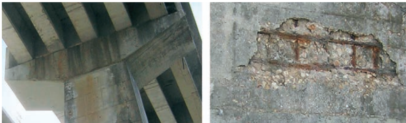
Figura 8. Viaducto de La Jarosa. Daños en armaduras por corrosión (sales fundentes)
