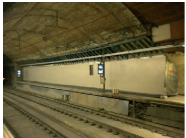
Figura 14. Vista del andén prolongado. Se aprecia la bóveda, la viga de reparto y las cartelas
