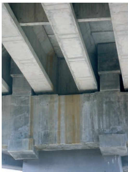
Figura 48. Vista de las vigas de cuelgue (entre las vigas del tablero) y la parte central del dintel nuevo. Se aprecian los regruesamientos correspondientes a los anclajes del pretensado
