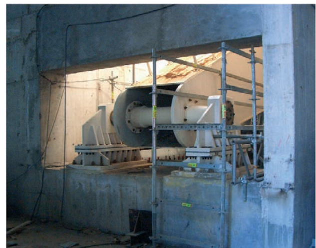
Figura 28. Cojinete principal ya instalado en el foso de mecanismos Figure 28. Main bearing already installed
