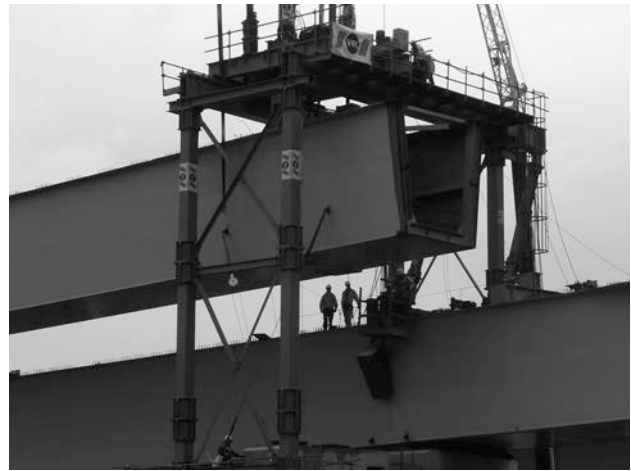
Figura 31B. Pórtico de izado (Vista 2)
