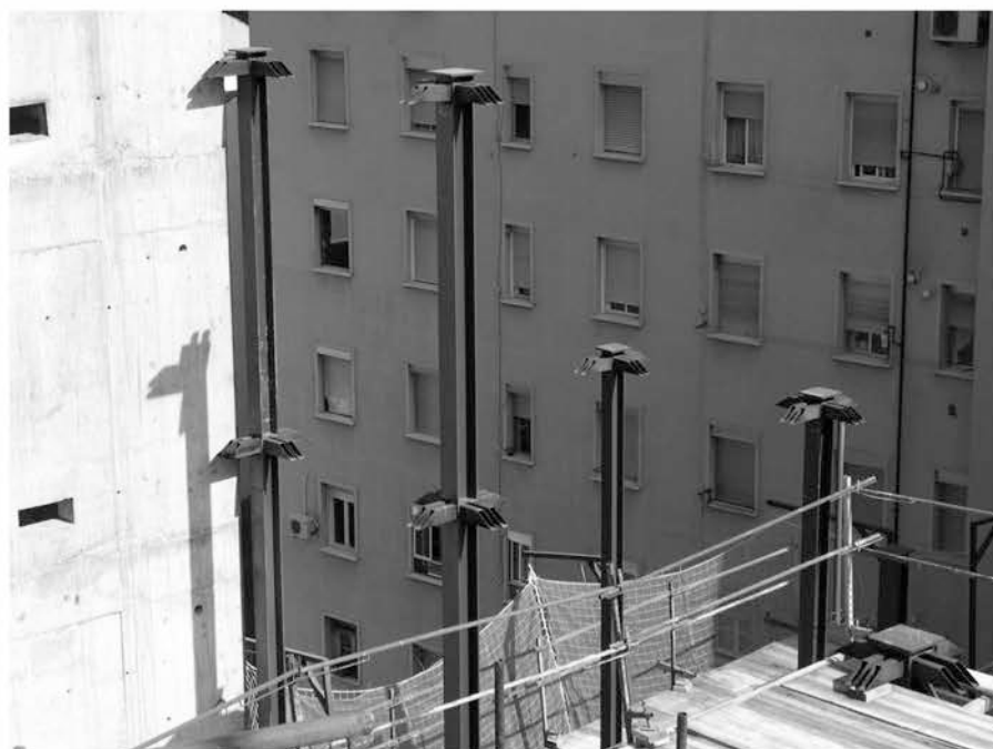
Figura 12. Esquema de protopropuesta de protocolo de ejecución en obra para el aplomado de soportes de tres o más plantas
