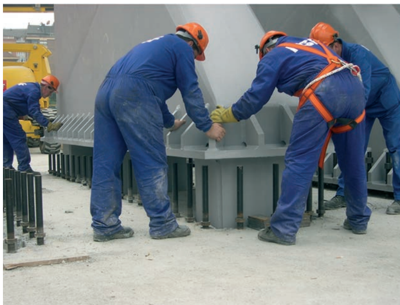
Figura 35. Proceso de montaje de una de las bases de los pórticos principales Figure 35. Mounting work of one of the bases of the main portals
