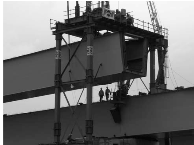
Figura 31B. Pórtico de izado (Vista 2)
