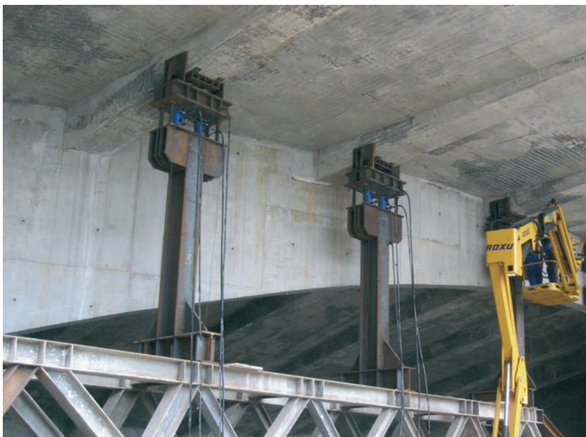
Figura 48. Soportes de acero utilizados en el apeo de la losa del graderío, instrumentados con células de carga y apoyados sobre celosías auxiliares Figure 48. Steel columns monitored with load cells and supported on auxiliary trusses, used to support the grandstand slab
