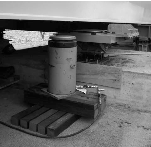
Figura 9. Sistema de deslizamiento en apoyos deslizantes y gato de desapeo
