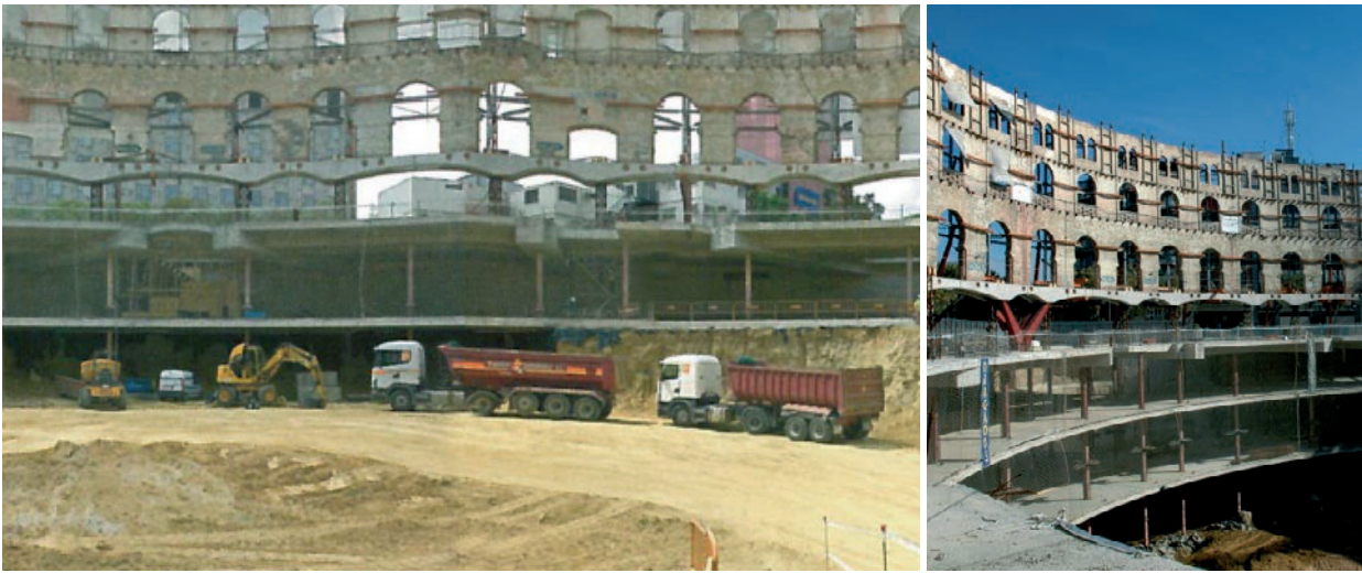
Figuras 28 y 29. Fases de excavación descendente hasta sótanos -3 y -5, respectivamente Figures 28 & 29. Top-down excavation stages to basement levels -3 and -5, respectively.
