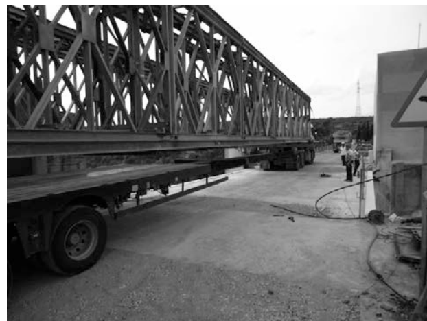
Figura 15. Movimiento de viga principal entre tableros
