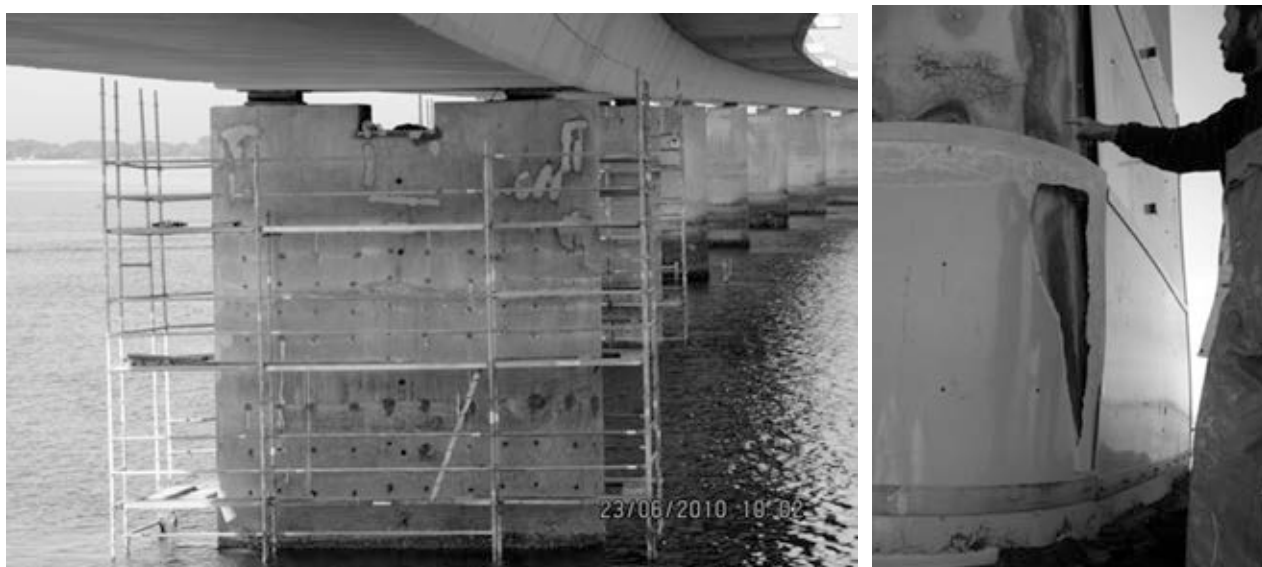
Figura 16. Aplicación de diferentes sistemas de protección en las pilas del puente de la isla de Arosa. El sistema probado para la pila, e incluido inicialmente en el proyecto, a base de una camisa impermeable y una malla de ánodo dispuesta en su interior, en la periferia de la pila, no pudo instalarse correctamente
