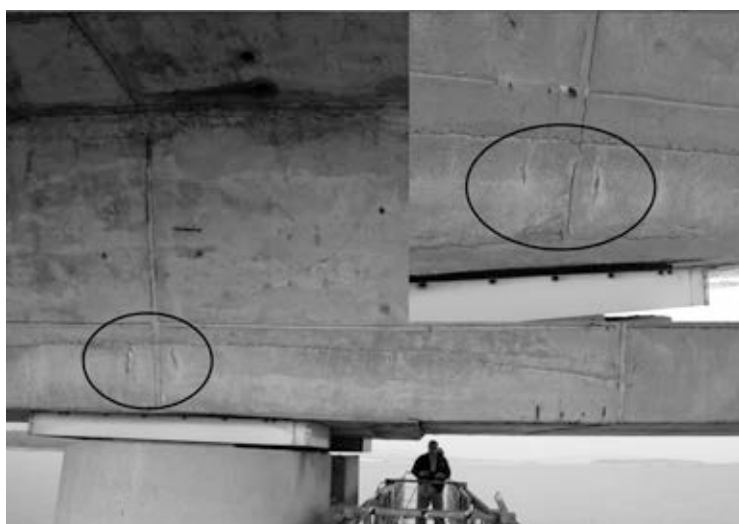
Figura 7. Fisuras de "negativos" en lo que fue zona superior de la solera, sobre apoyos, durante el proceso constructivo en los primeros tramos, lado continente, debido a la deformabilidad de dicha solera y de la cimbra, y luego corregido en los tramos siguientes
