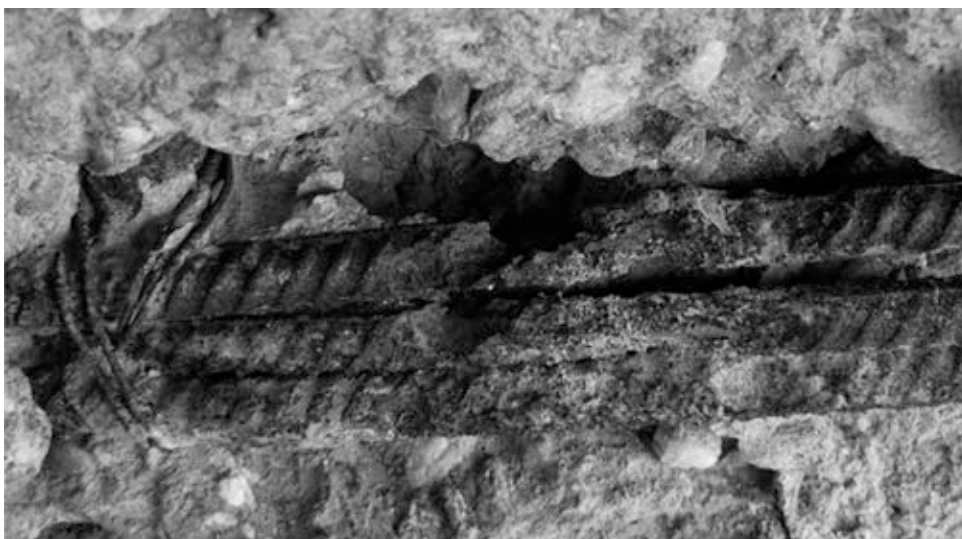
Figura 14. Picaduras de corrosión en la armadura transversal de una de las pilas del puente de la isla de Arosa, con pérdida casi total de la sección. La fotografía fue tomada ya en la fase de ejecución de las obras y muestra un ejemplo claro de disolución del hierro que, por desgracia para los inspectores, no da lugar a síntomas en forma de pérdida del recubrimiento o de fisuraciones de aviso. La detección de estos daños confirma que, para contenidos de cloruro tan elevados en la masa de hormigón, se había iniciado ya el período de propagación y la actuación estaba plenamente justificada
