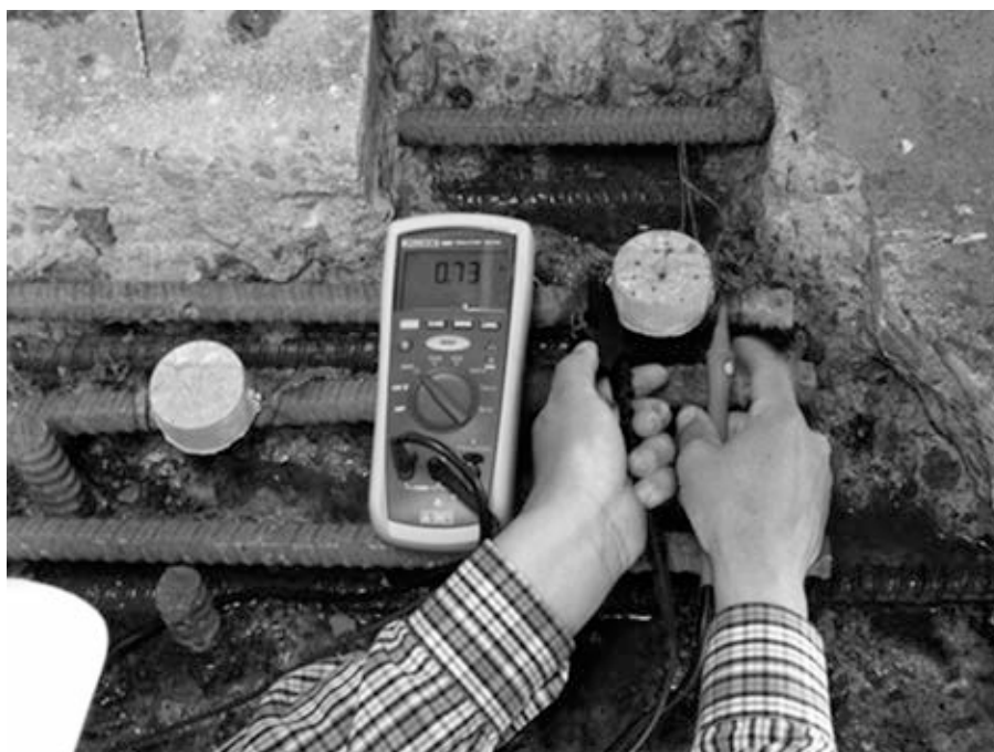
Figura 13. Control de la efectividad de la instalación de los ánodos de sacrificio (la foto no corresponde al puente de la isla de Arosa), que deben ubicarse en la periferia del parche, no en su zona interior, ya protegido por un micro-hormigón de calidad excelente
