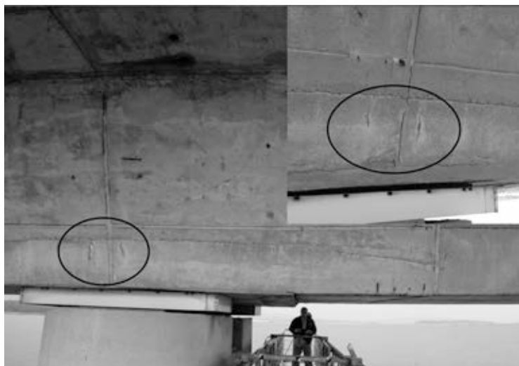
Figura 7. Fisuras de "negativos" en lo que fue zona superior de la solera, sobre apoyos, durante el proceso constructivo en los primeros tramos, lado continente, debido a la deformabilidad de dicha solera y de la cimbra, y luego corregido en los tramos siguientes
