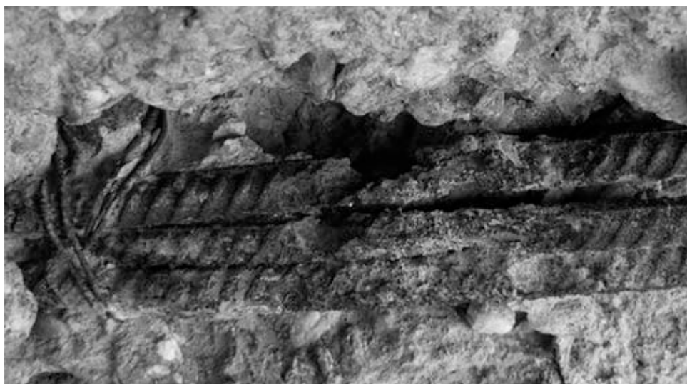
Figura 14. Picaduras de corrosión en la armadura transversal de una de las pilas del puente de la isla de Arosa, con pérdida casi total de la sección. La fotografía fue tomada ya en la fase de ejecución de las obras y muestra un ejemplo claro de disolución del hierro que, por desgracia para los inspectores, no da lugar a síntomas en forma de pérdida del recubrimiento o de fisuraciones de aviso. La detección de estos daños confirma que, para contenidos de cloruro tan elevados en la masa de hormigón, se había iniciado ya el período de propagación y la actuación estaba plenamente justificada
