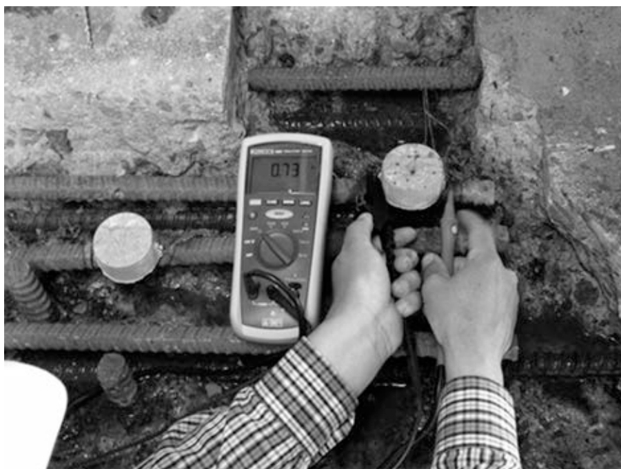
Figura 13. Control de la efectividad de la instalación de los ánodos de sacrificio (la foto no corresponde al puente de la isla de Arosa), que deben ubicarse en la periferia del parche, no en su zona interior, ya protegido por un micro-hormigón de calidad excelente
