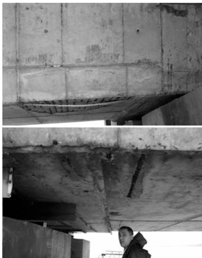
Figura 3. Desprendimiento del recubrimiento en la cara inferior del cajón junto al estribo lado isla (2005, foto superior) y vista del estado sobre una pila intermedia (2006, foto inferior)
