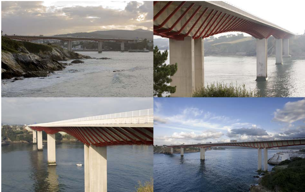
Figura 45. Vista del puente de Los Santos con las obras de ampliación terminadas.
