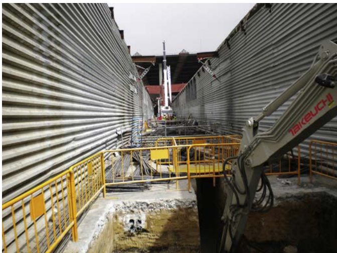
Figura 43. Ejecución de micropilotes y encepados entre túneles provisionales para la protección de vías.
