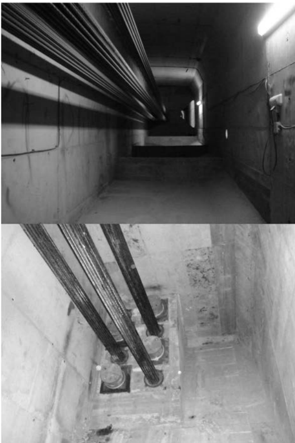
Figura 35. Arriba: fotografía del pretensado exterior en el interior del cajón con vista de uno de los desviadores. Abajo: vista de los anclajes activos y pasivos del pretensado exterior situado en el interior del cajón, en las riostras de pila.
