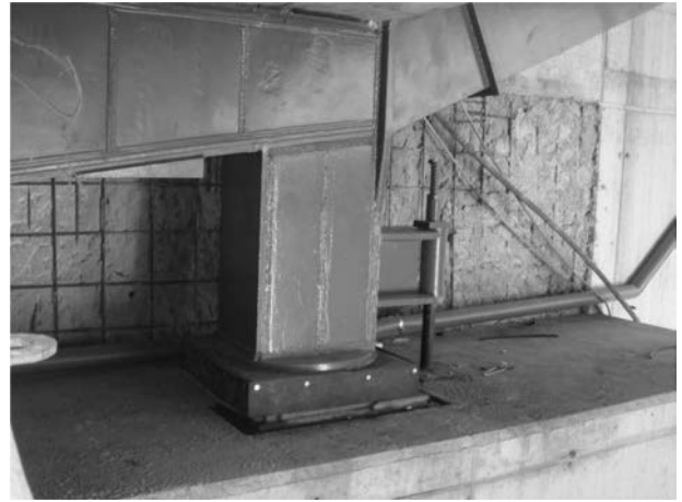
Figura 44. Fotografía de una de las nuevas patas de apoyo dispuestas en los estribos. Se puede ver una de las barras del sistema antivuelco del tablero y el faldón de protección dispuesto en el POT.
