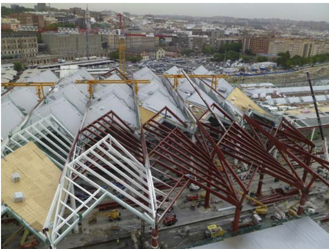
Figura 51. Puentes grúa sobre la cubierta alta.
