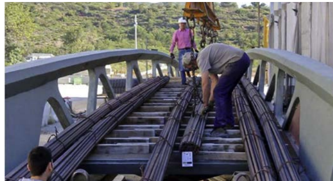
Figura 30. Paquetes de barras apoyados sobre maderas para la prueba de carga estática.
