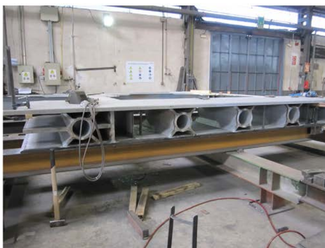
Figura 5. Análisis por elementos finitos del elemento de anclaje y fabricación del mismo.
