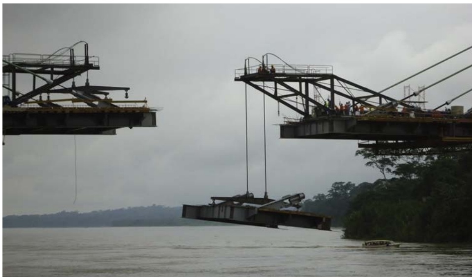
Figura 3. Construcción de tablero de dovelas con carro en voladizo (puente sobre el río Napo, Ecuador).
