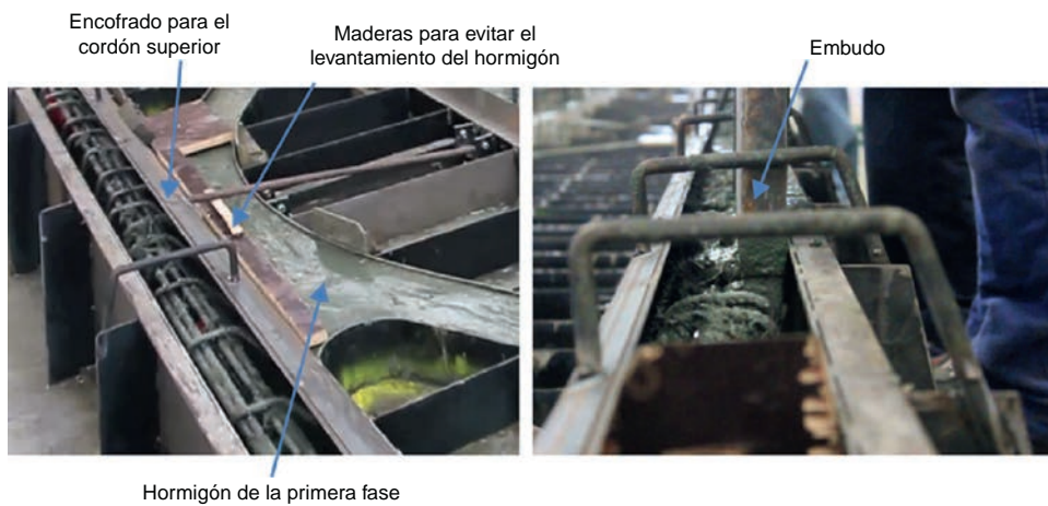
Figura 23. Preparación del encofrado del cordón superior (izquierda) y vertido con embudo (derecha).
