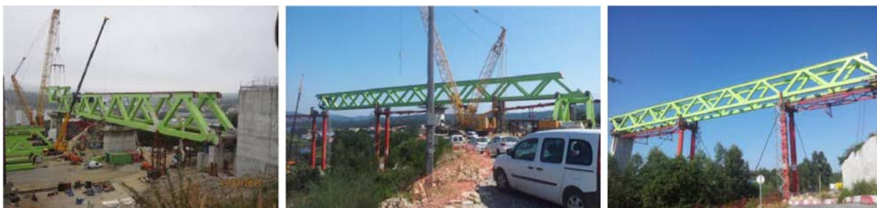
Figura 23. Izado de dovelas, imagen del primer lanzamiento y tramo lanzado entre P-2 y P-3.
