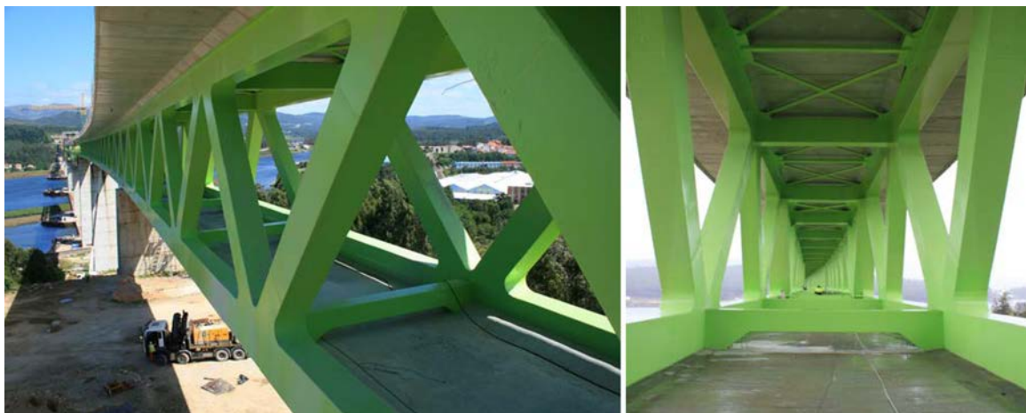
Figura 4. Vista lateral y del interior de la sección transversal desde el hormigón inferior.
