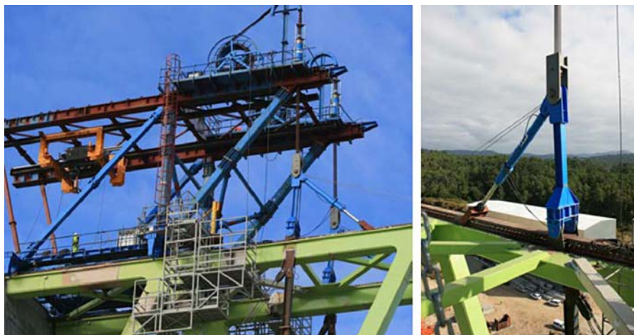
Figura 35. Izado de una dovela desde carro fijo y detalles de balancín de ajuste.
