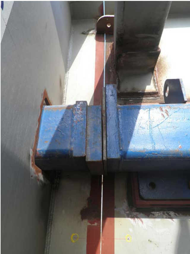
Figura 13. Sistema de acople de dovelas con la galga de corrección (en gris).
