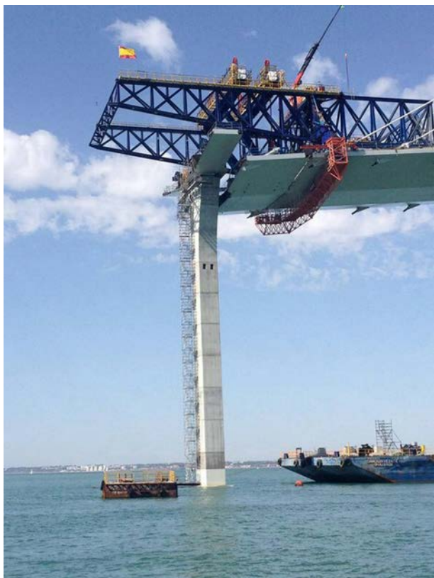
Figura 2. Desnivel entre dovelas de tablero a la llegada a la pila del vano de compensación.
