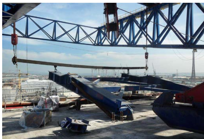
Figura 7. Pescante de bloqueo en el momento del abatimiento sobre la dovela de pila.
