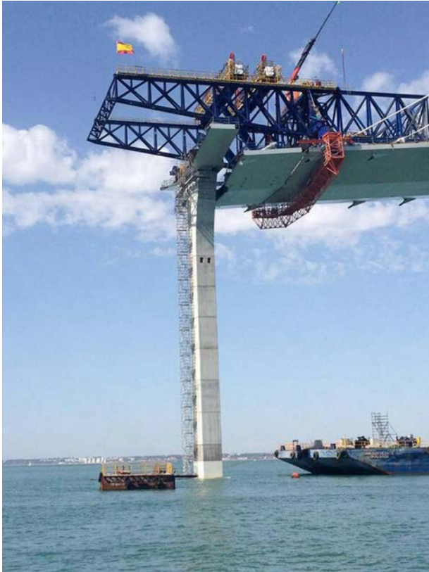
Figura 2. Desnivel entre dovelas de tablero a la llegada a la pila del vano de compensación.
