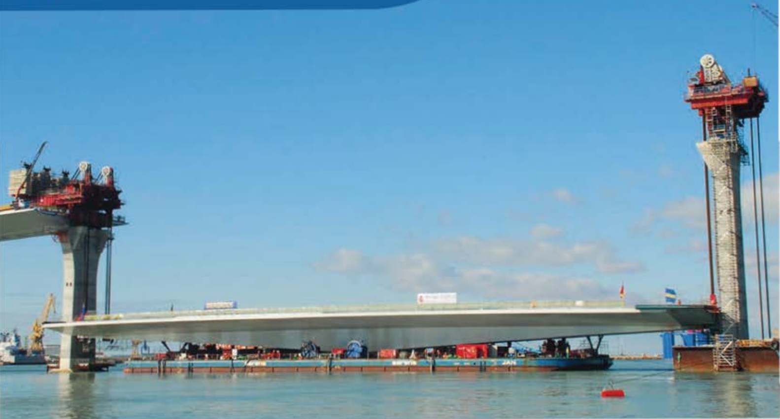
Puente La Pepa: Traslado marítimo tramo desmontable. Barcaza JAN (100x33x7,6 m) para 5.000 T incluyendo vano de 150 m, carros y vigas de transporte. La Pepa Bridge: Sailing of the removable span. Barge JAN (100x33x7,6 m) up to 5.000 T including 150 m span, SPMTs, and transport beams.
