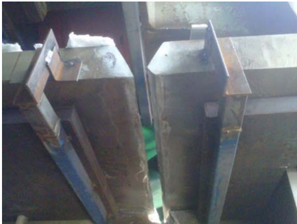
Figura 3. Maniobra de alineamiento de chapas en altura. Unión de dovelas. Espesores de 110 mm.
