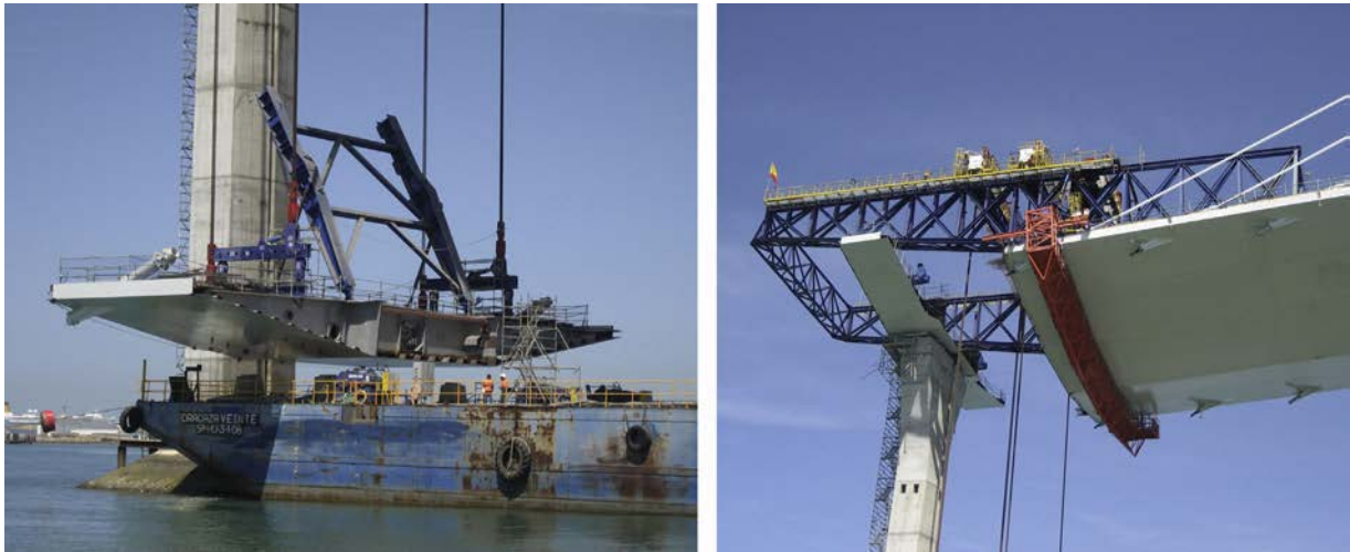
Figura 4. Izado de la última dovela del voladizo (11IP12) con la dovela de pila (0P11) ya colocada.
