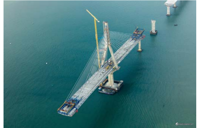
Figura 3. Voladizo máximo de la torre de la Bahía (cortesía de Objetivo Aéreo).
