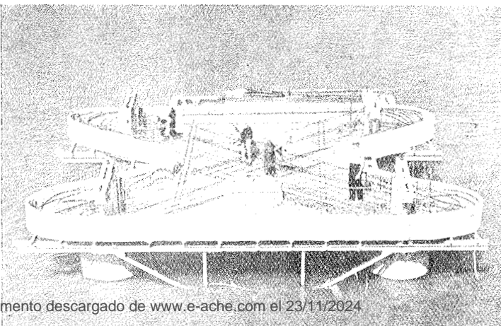
Construcción de una de las placas de hormigón armado, de 60 cm de espesor, que enlaza las cabezas de los pilotes de cimentación de las pilas.
