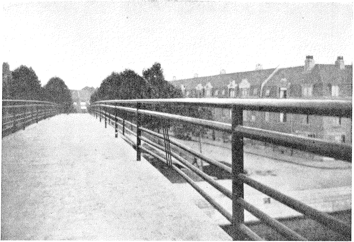
Fig. 18.—Pasarela de «Bois Blancs». Pandeo de la barandilla.
