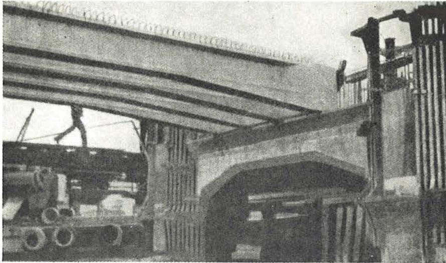
Fig. 3. Muelle de Erith, sobre el Támesis. Vigas de hormigón pretensado enlazadas entre sí, dos a dos, los pilotes, asegurándose de esta forma la estabilidad transversal de la estructura contra los choques de los barcos.
